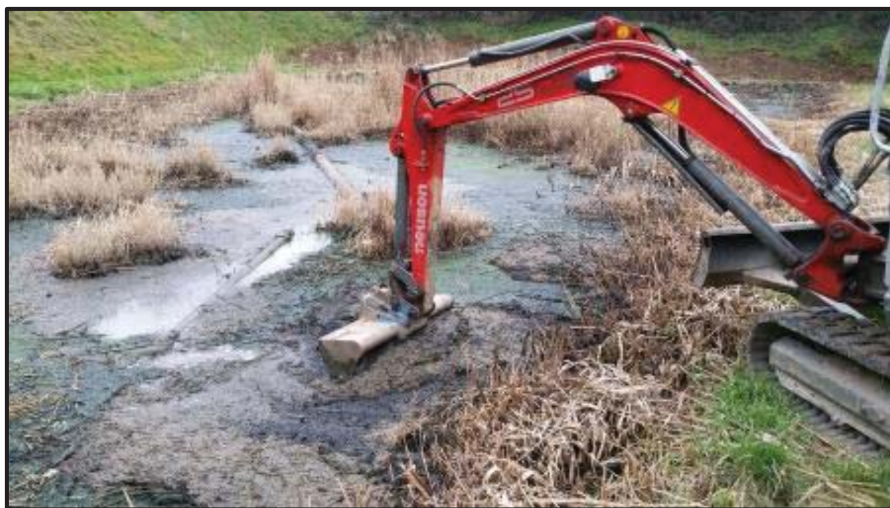
Photo n°4 : Inspection plus profonde du premier étage de filtre
