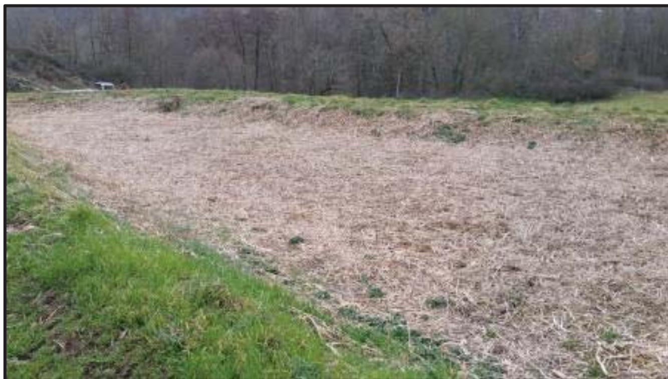
Photo n°10 : Troisième étage de filtre
