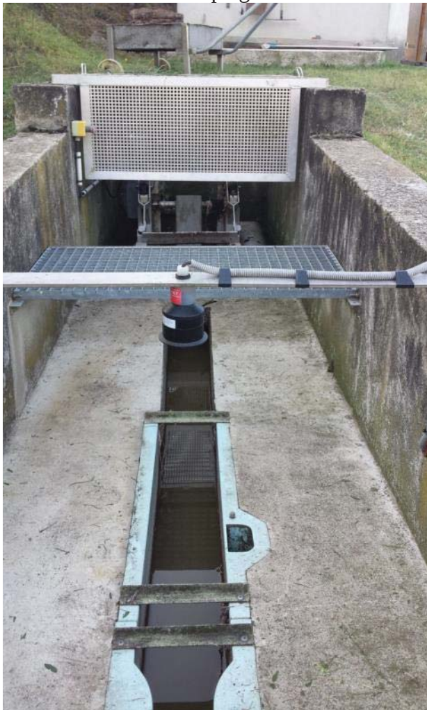
Photo 2 : Canal de comptage
