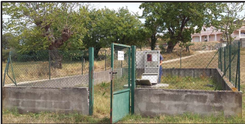
Photo 1 : Vue d'ensemble du poste
