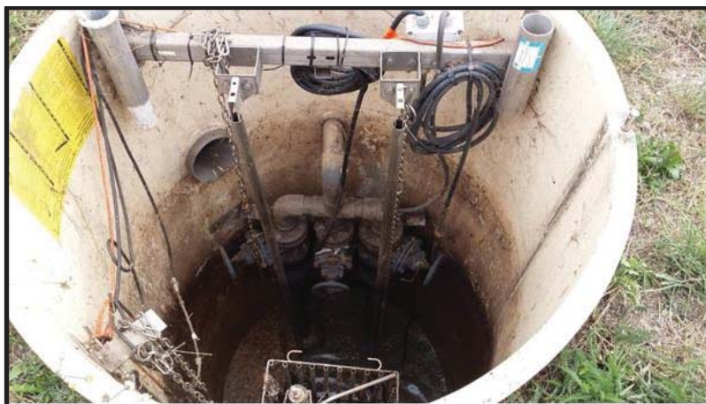
Photo 3 : Vue intérieur du poste
