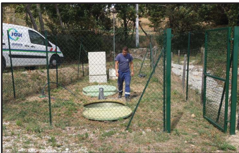
Photo 1 : Vue d'ensemble du poste de refoulement
