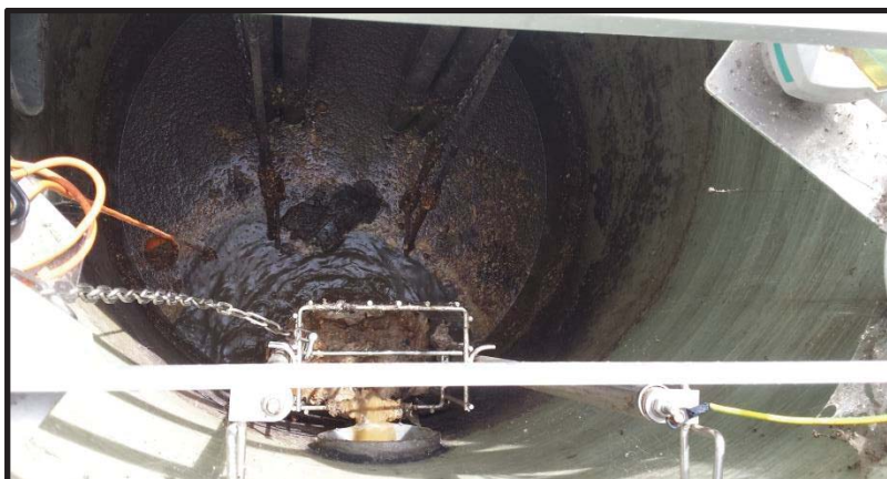
Photo 3 : Vue intérieur du poste
