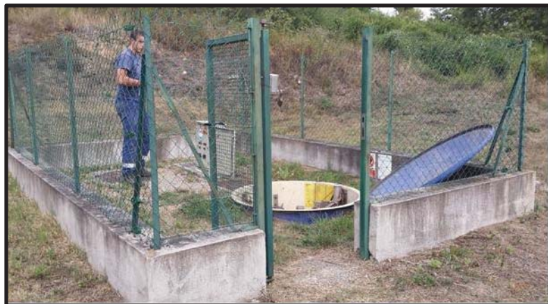
Photo 1 : Vue d'ensemble du poste de refoulement
