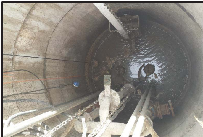
Photo 3 : Vue intérieur du poste
