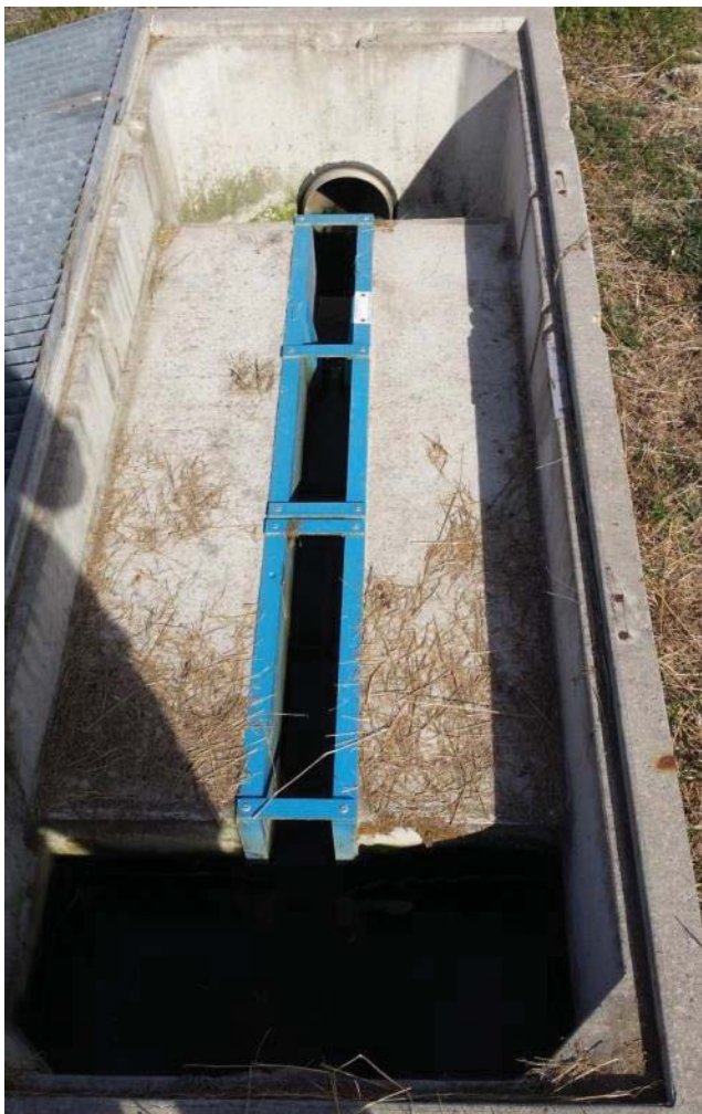
Photo 14 : Canal de comptage de sortie
