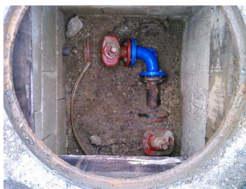
Aperçu du jeu de vannes VP9 – VP10 en bout de réseau
