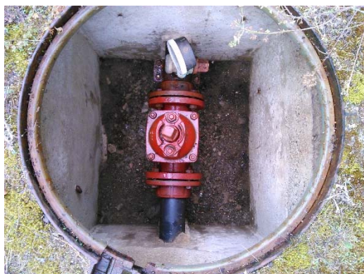
Aperçu d'une vanne de partage (VP2) compteur en coffret
