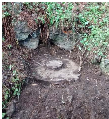
Aperçu du regard de collecte recouvert d'un tampon en fonte
