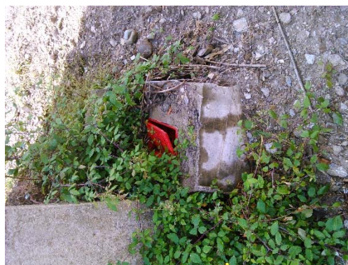
Aperçu d'un coffre incendie dans le village
