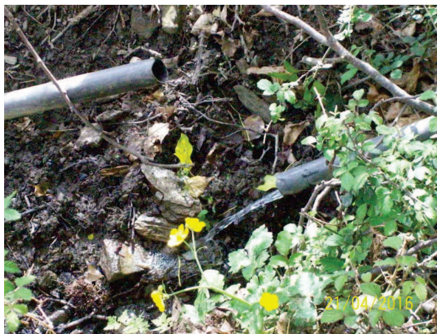
Captage de Piovale amont : Conduite d'adduction rompue
