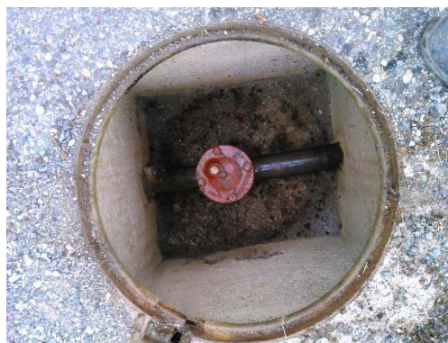
Aperçu d'une ventouse en parcours
