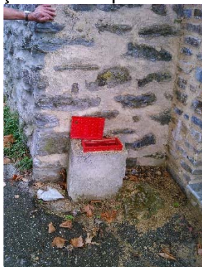
Aperçu d'une bouche d'incendie
