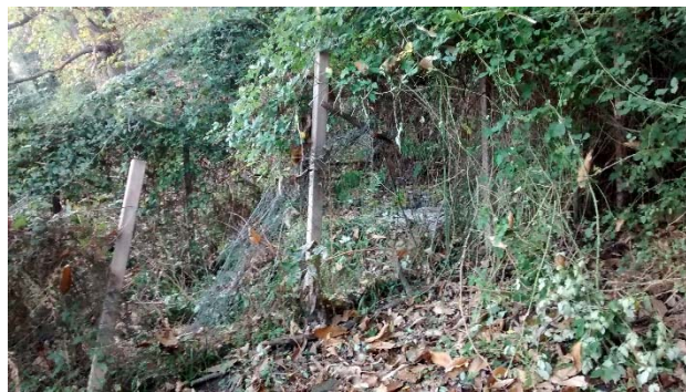
Aperçu de la clôture détériorée
