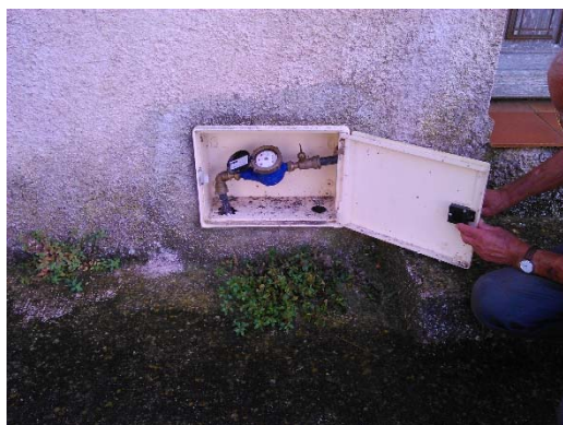
Aperçu d'un compteur en coffret
