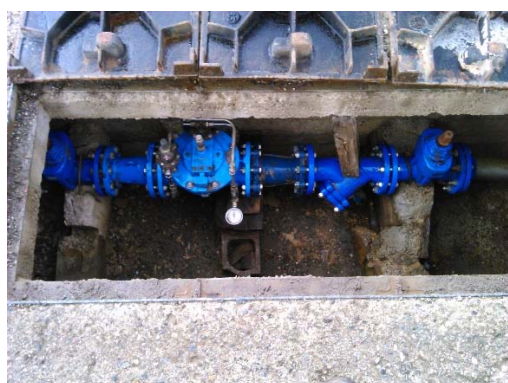
Aperçu du stabilisateur de pression (Hydrostab)
