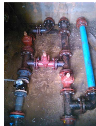
Aperçu du jeu de vannes
