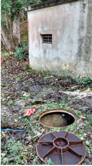
Vue de l'ancienne station de pompage et du regard de collecte commun
