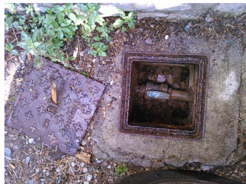
Aperçu d'une vanne de sectionnement récente
