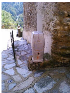
Aperçu du poteau d'incendie du village
