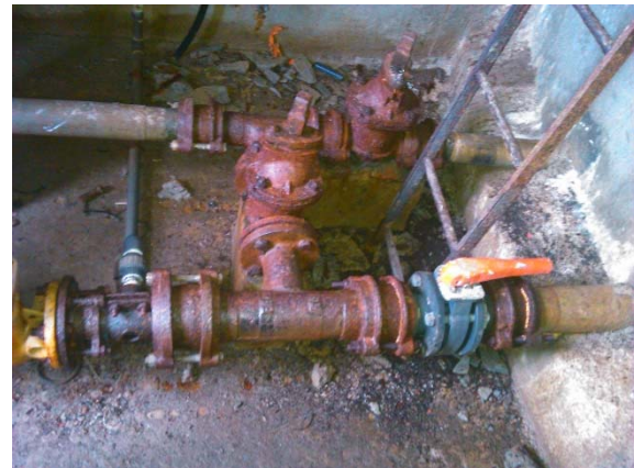
Aperçu du jeu de vannes
