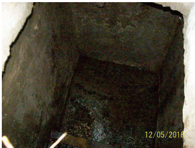
Captage de Caracutu : Bac de mise en charge et départ vers le réservoir
