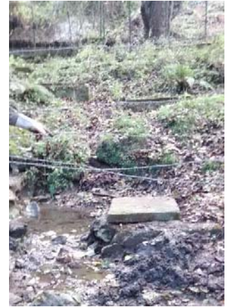
Aperçu du captage n°6
