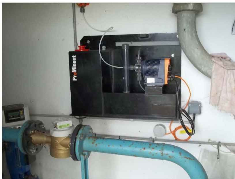
Pompe d'injection du chlore
