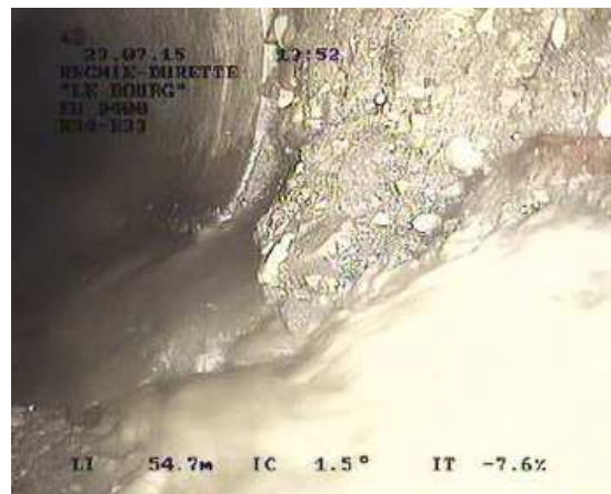
Dégradation de surface dans un regard
