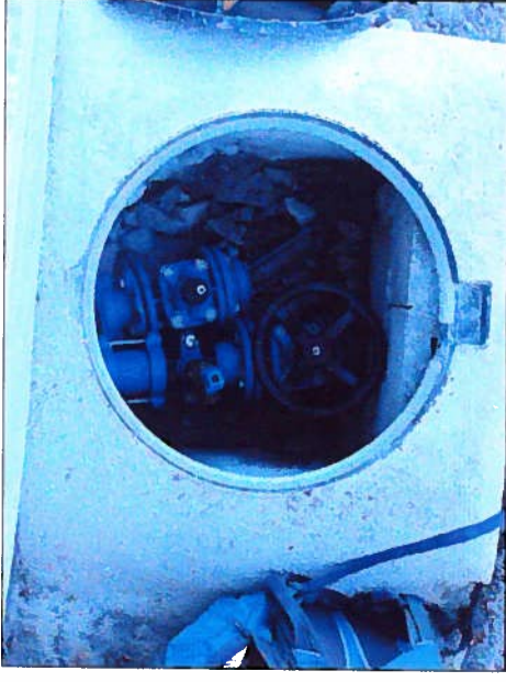
Regard à vannes avec vannerie et robinet de prélèvement
