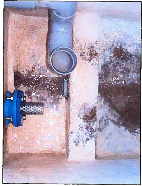
Bassin de décantation avec crépine sur adduction et siphon sur trop plein
