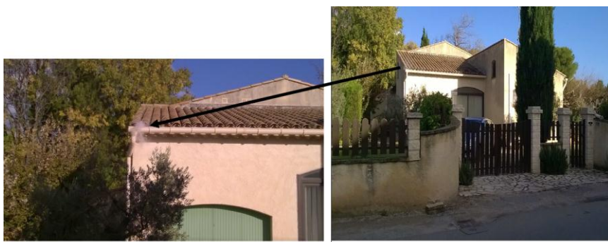
FIGURE 7 : EXEMPLE DE GOUTTIERE MAL RACCORDEE
