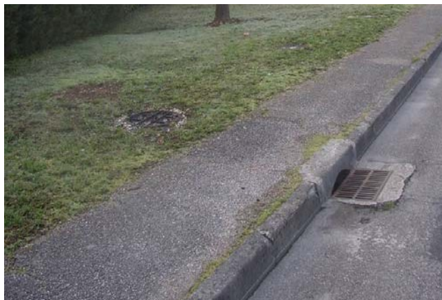
Avaloir conduisant les eaux pluviales de voirie vers le puits d'infiltration – Chassieu 69
