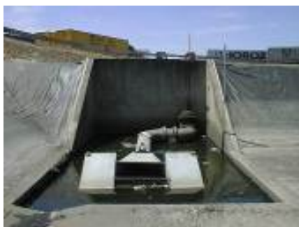
Débit régulé par flotteur
