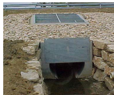
Plaque métallique fixée sur orifice de sortie
