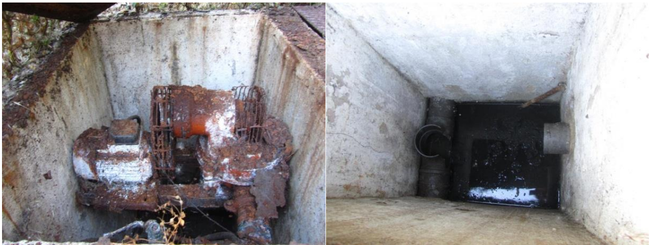
Figure 11 : Pompes – Bac de décantation (Juillet 2012)
