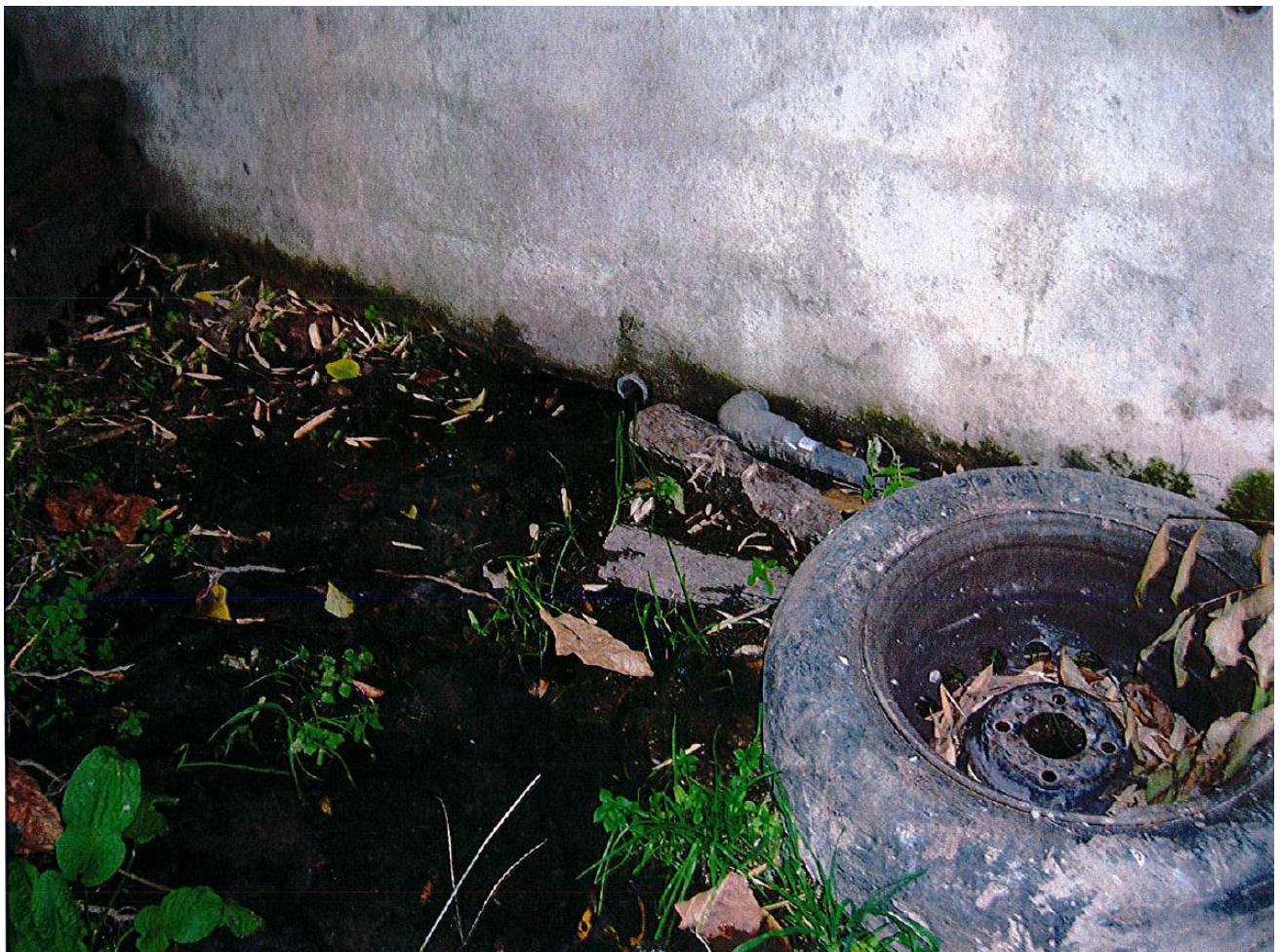
Figure 20 : Débordements au niveau du muret bordant R9
