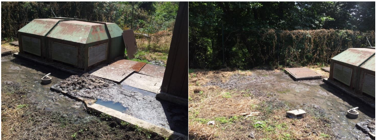
Figure 13 : Station de traitement (Fin Août 2012)
