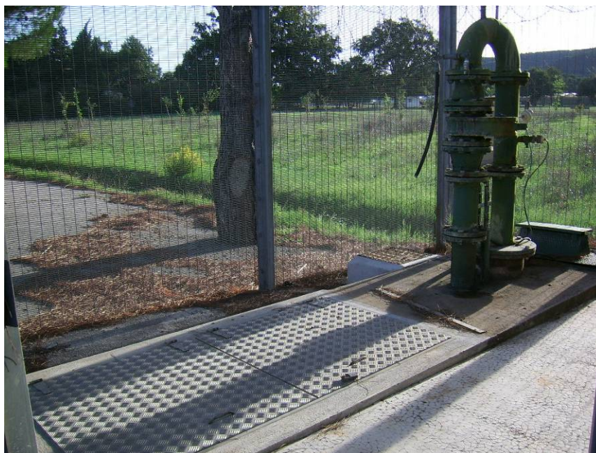
Figure 4 : Captage de Fonqueballe (photo SCE)
