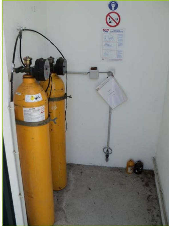
Figure 4 : Unité de traitement au chlore gazeux du site de Fontaine l'Evêque
