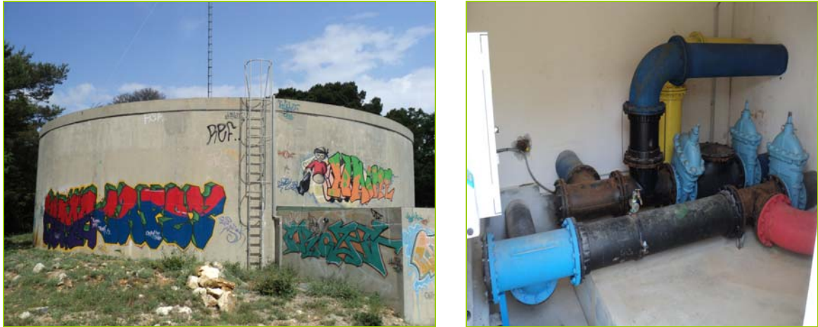
Figure 5 : Réservoir syndical 1 000 m 3 de Baudinard sur Verdon et sa chambre de vannes
