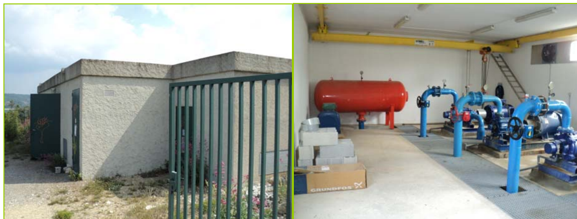
Figure 3 : La station de pompage de Fontaine l'Evêque
