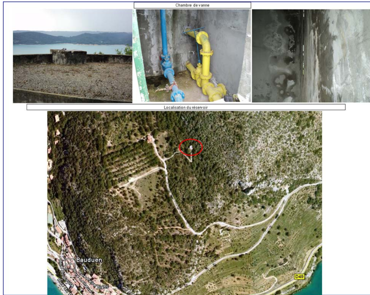
Figure 9 : Le réservoir communal
