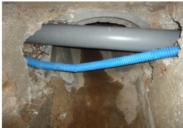
Présence d'une conduite d'assainissement dans le regard R27
