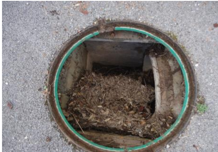
Vue intérieure du regard R17 obstrué par les dépôts
