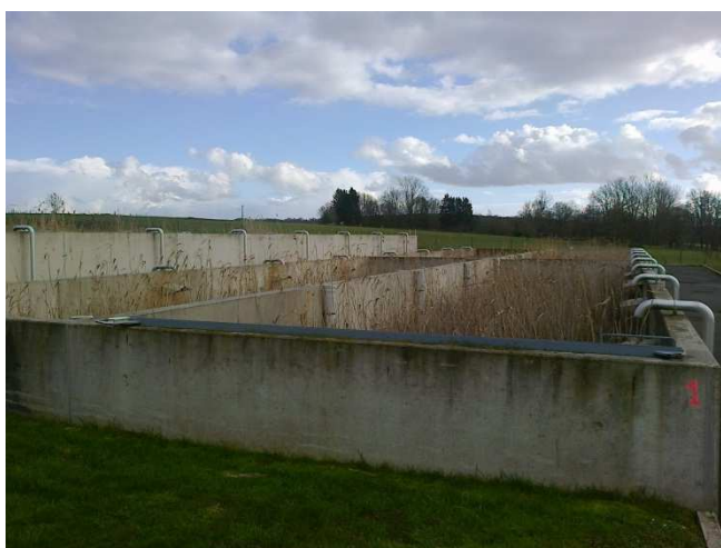
Document n° 3 : Photographie des lits plantés de roseaux (source : SEDE)
