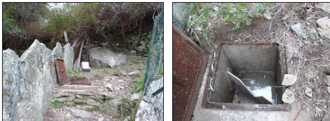
Photo 7 : FERRAGINE - Matériel de mesure posé au niveau du regard n°53
