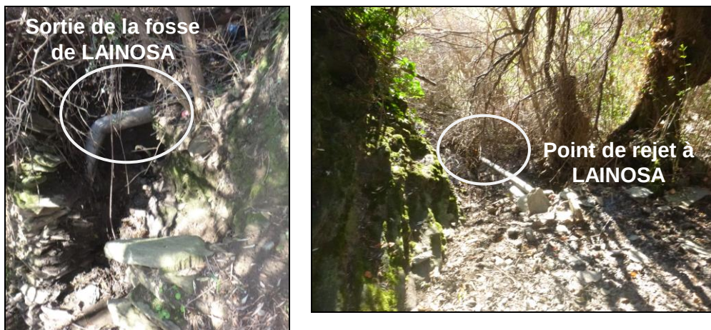
Photo 3 : Point de rejet du réseau d'assainissement des eaux usées de LAINOSA
