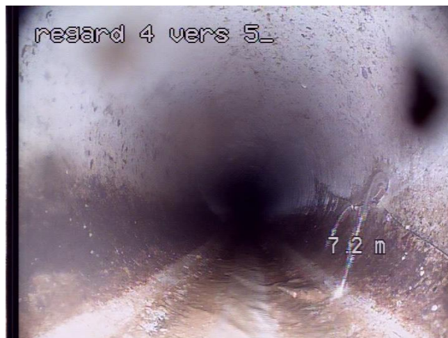
n°2 Arrivée d'eau depuis fissure de la canalisation
