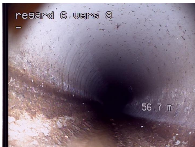
n°3 Fin de l'inspection - bout de cable
