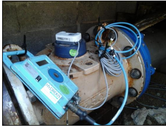
Figure 17 : Vue du compteur de l'OEHC en sortie des deux réservoirs équipés durant la campagne
