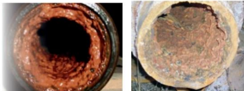
Figure 29 : Exemple d'entartrage de canalisations AEP
