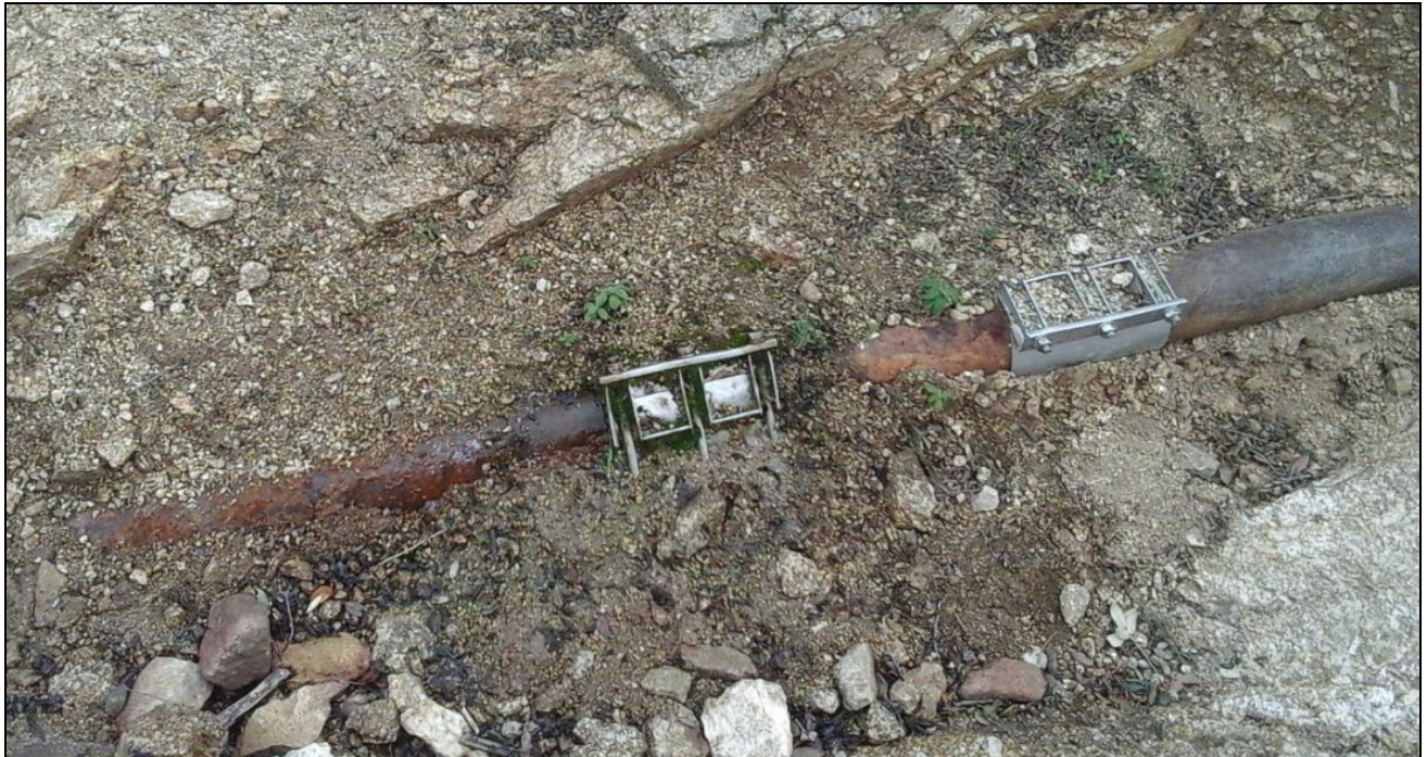
Figure 15 : Vue d'un tronçon de réseau apparent – réseau de distribution Capuccino
