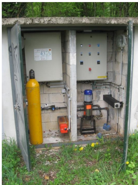
Figure 17 : Photographie du traitement de désinfection au chlore gazeux de Brevilliers
