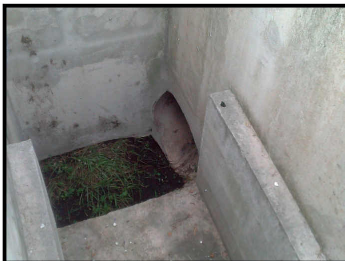
Départ du Trop-Plein
