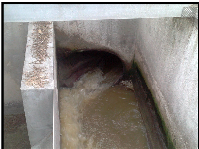
Arrivée de l'effluent
