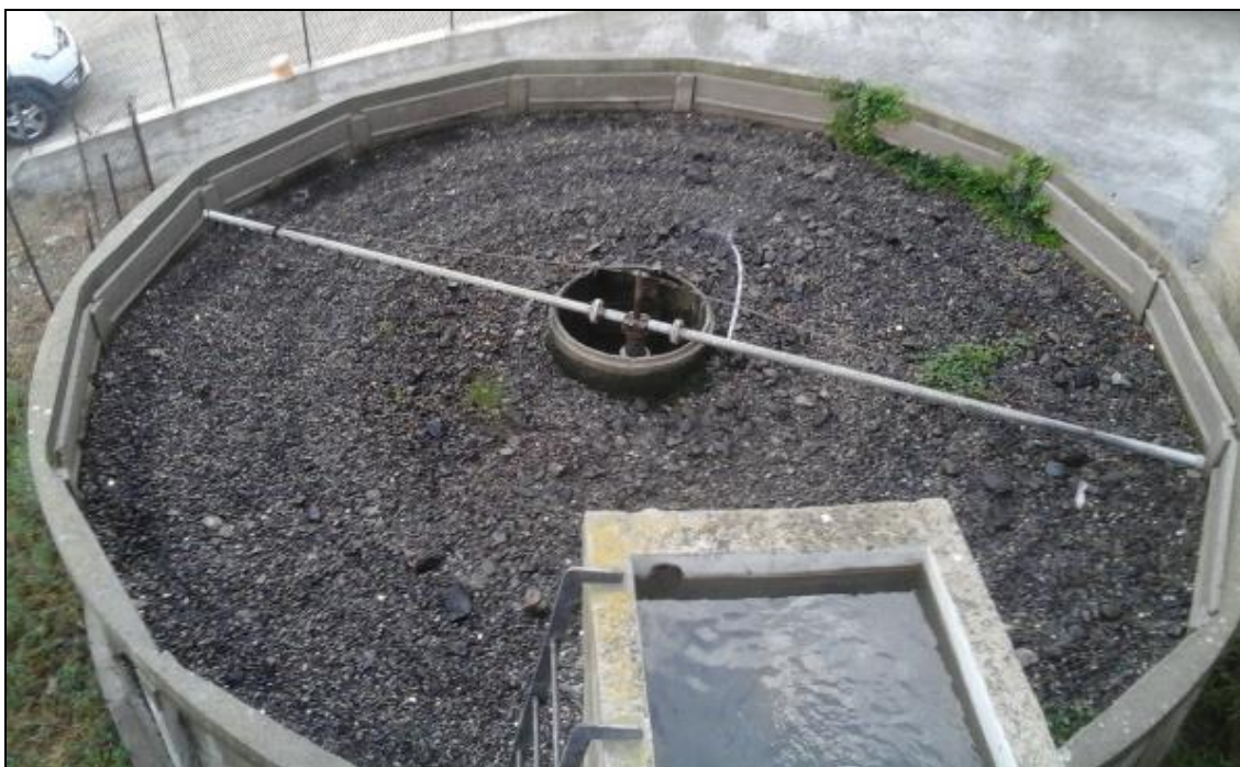
Figure 13 : Vue du lit bactérien et de son Sprinkler partiellement colmaté
