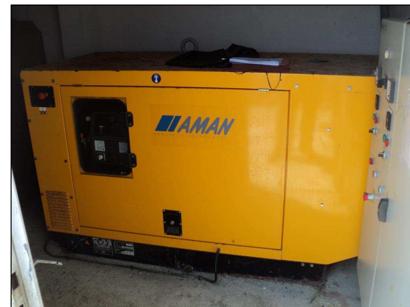
Groupe électrogène et cuve de stockage fioul
