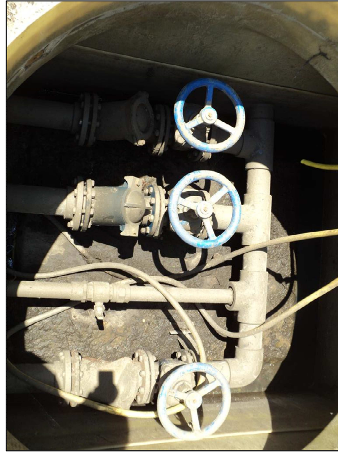
Chambre de vannes
