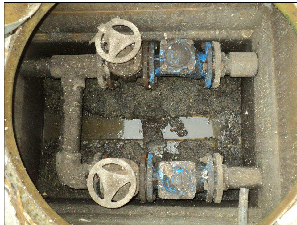
Chambre de vannes
