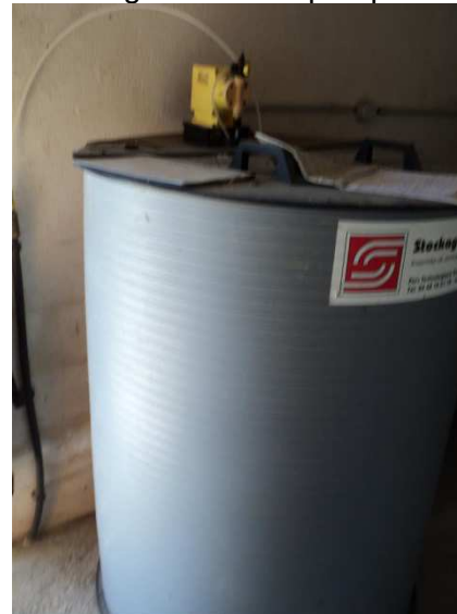
Cuve stockage nutriox et pompe doseuse
