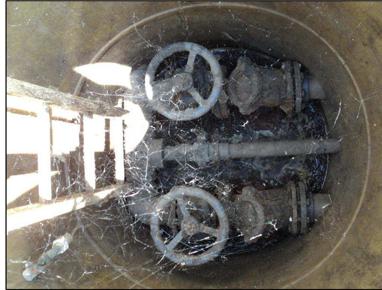
Chambre de vannes
