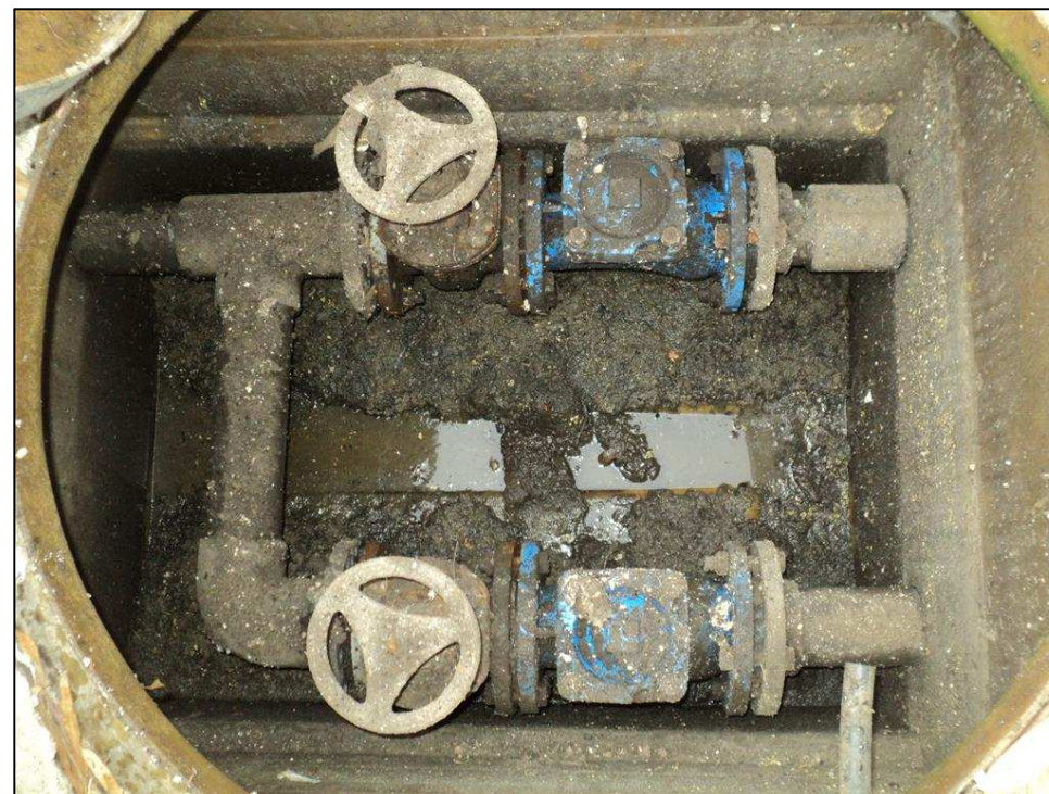
Chambre de vannes
