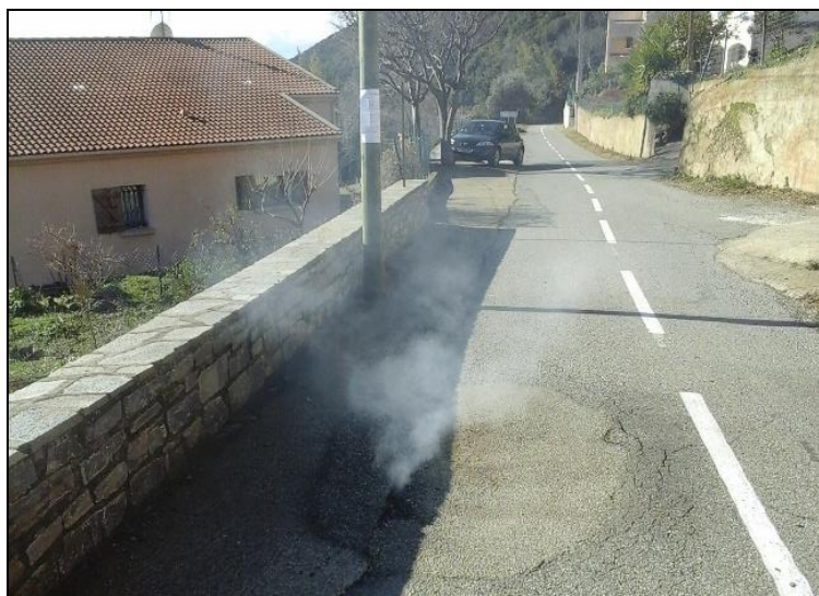
Figure 64 : Vue de la probable casse sur le réseau de collecte du village
