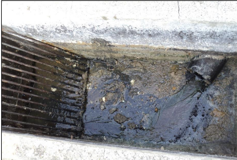
Figure 10 : Vue du dégrilleur
