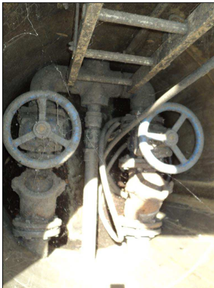
Chambre de vannes
