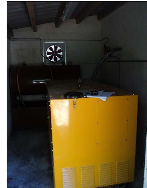
Groupe électrogène et cuve de stockage fioul
