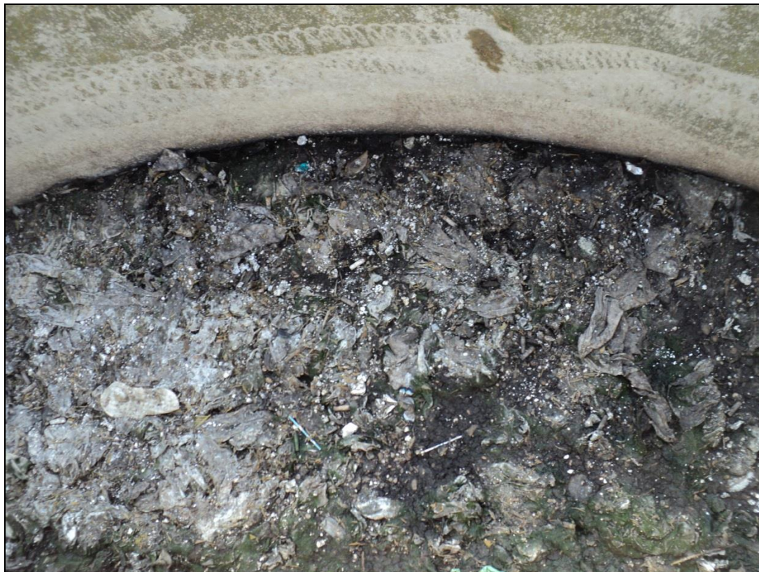
Figure 17 : Vue de la surface du décanteur-digesteur
