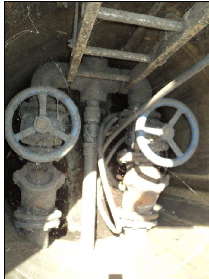
Chambre de vannes
