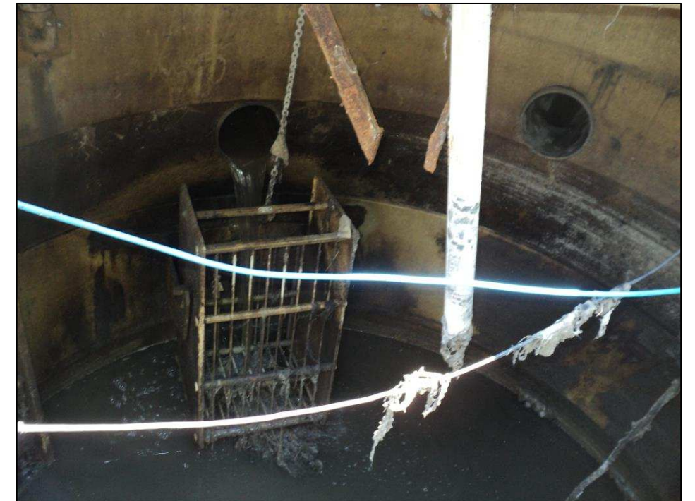
Panier de dégrillage et trop-plein PR
