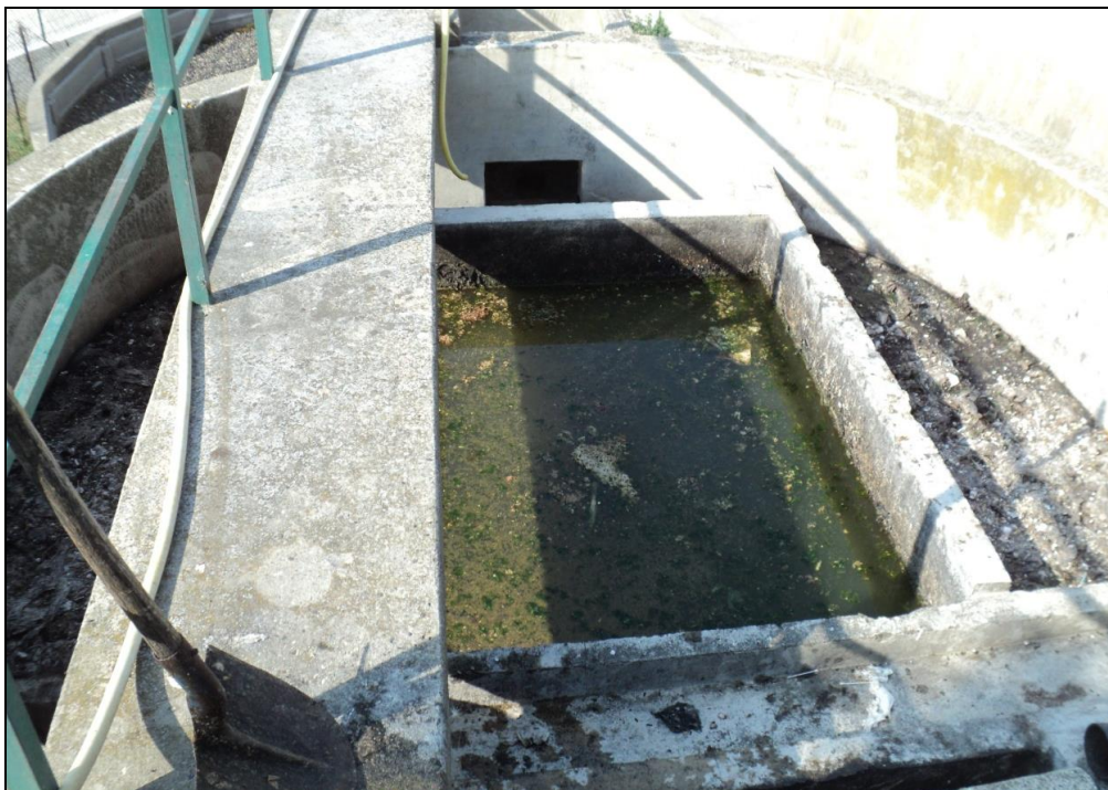
Figure 11 : Vue de dessus du décanteur et de l'arrivée de la recirculation du clarificateur
