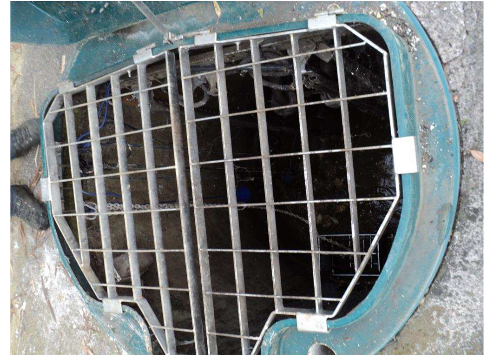
Vue des barreaux anti-chute au niveau de la bâche
