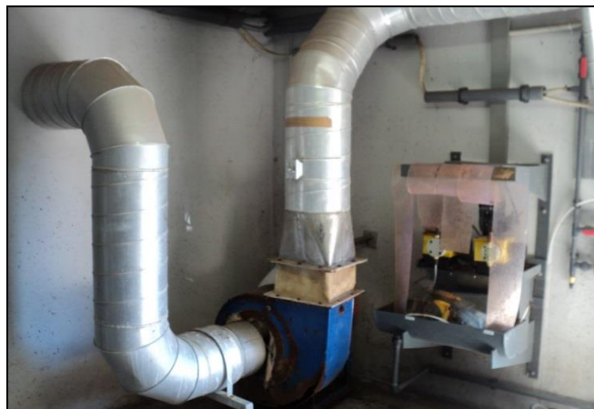
Figure 33 : Vue du système de ventilation et du système d'ensemencement
