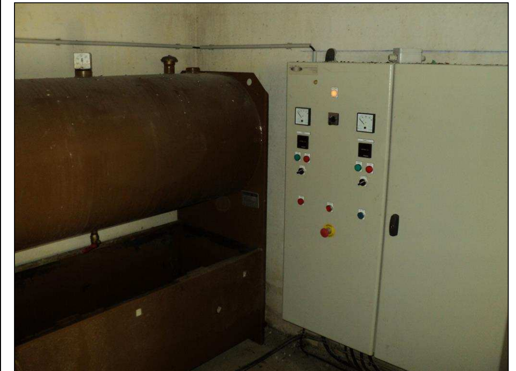
Vue de la cuve de stockage du fioul et de l'armoire électrique
