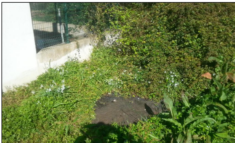
Figure 62 : Vue du débordement d'eaux usées suite à l'arrêt du PR Tinta
