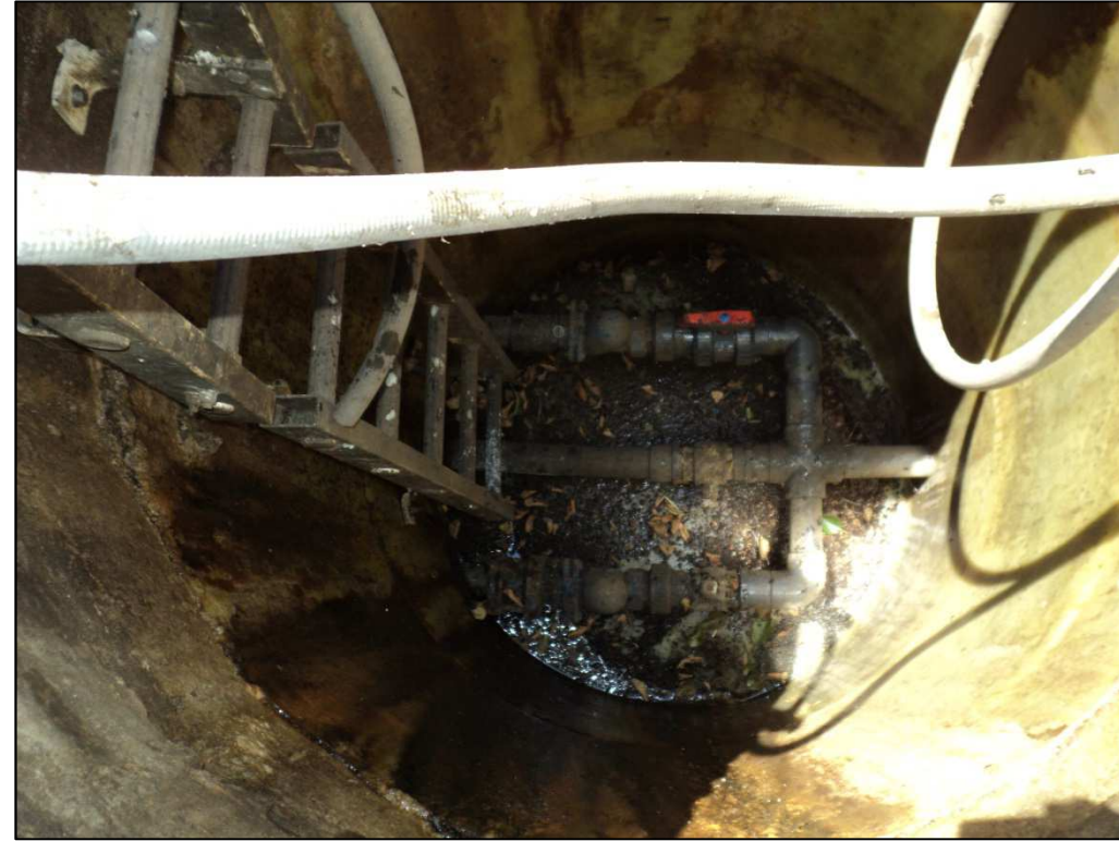
Chambre de vannes
