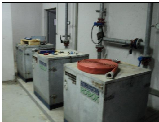
Figure 21 : vue des surpresseurs d'air
