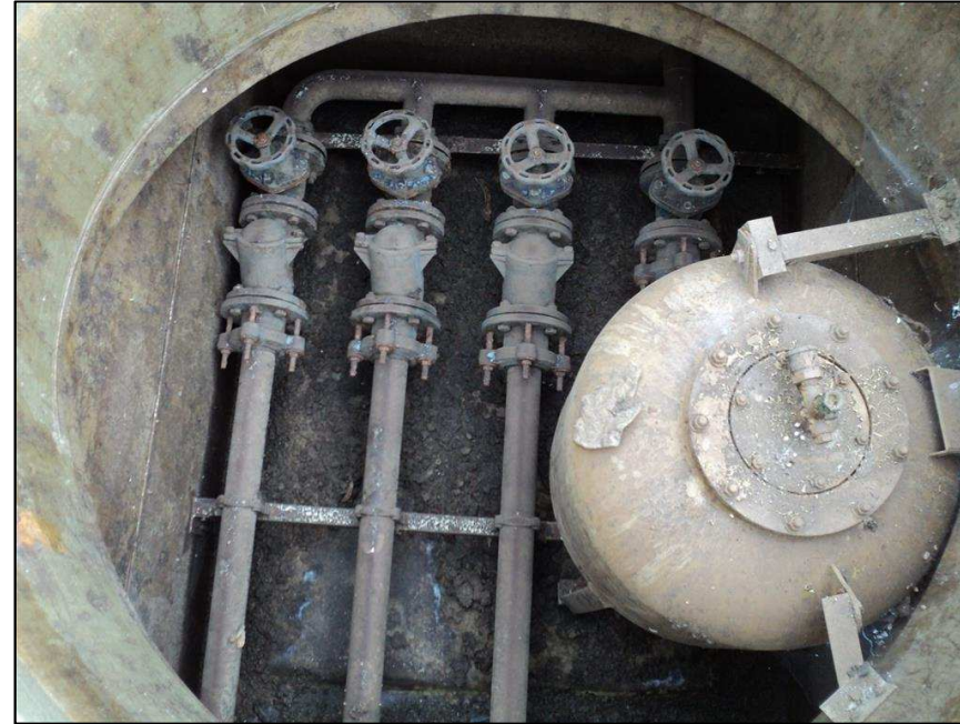
Chambre de vannes
