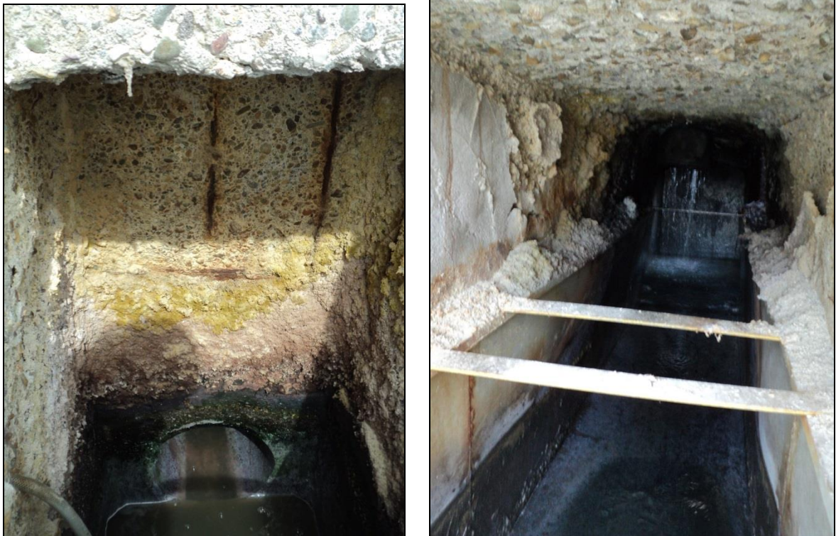
Figure 36 : Vue de l'état de corrosion avancé à l'intérieur du canal d'entrée des effluents
