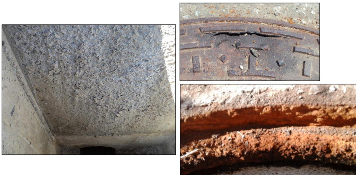
Figure 61 : Vues des signes de corrosion importante au niveau des regards de visite
