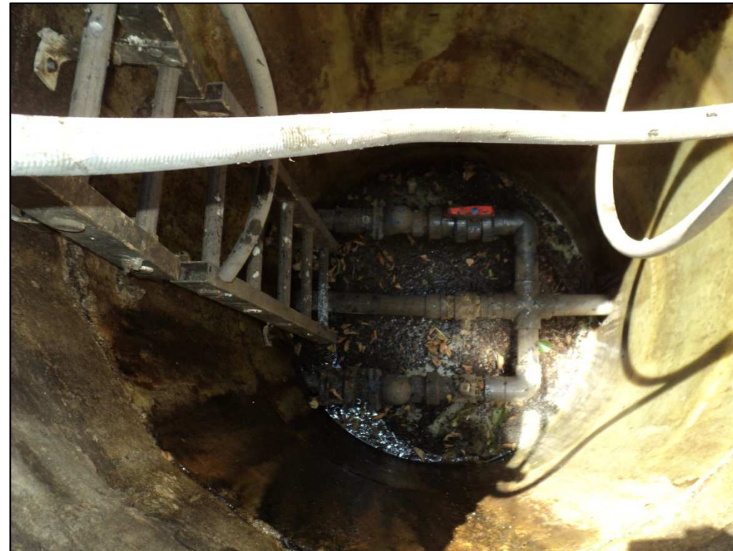
Chambre de vannes
