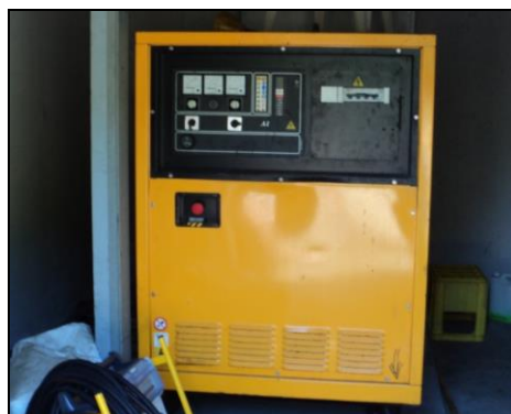
Figure 35 : Vue du groupe électrogène
