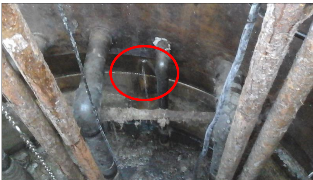
Figure 63 : Vue du défaut d'étanchéité au niveau du PR général
