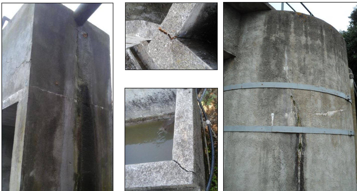
Figure 16 : Vue des fissures et des fuites présentes au niveau des différents ouvrages de traitement
