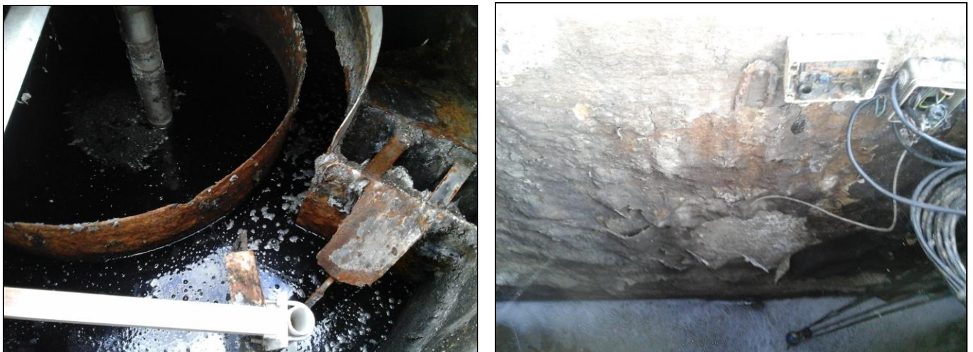
Figure 37 : Vues de la corrosion au niveau d'un dessableur/dégraisseur et d'un bassin d'aération
