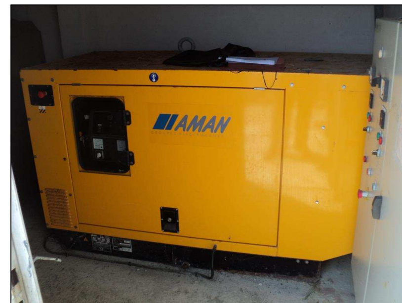
Groupe électrogène et cuve de stockage fioul
