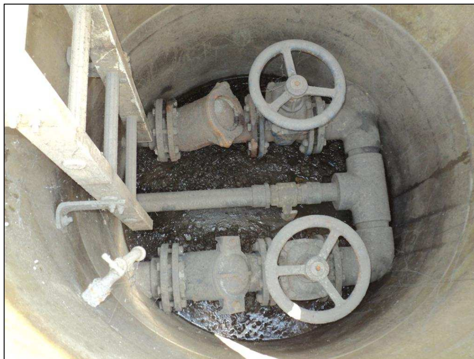
Chambre de vannes
