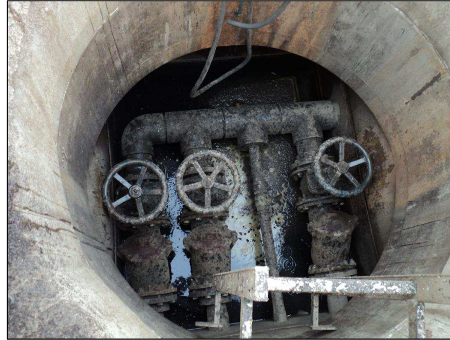
Chambre de vannes
