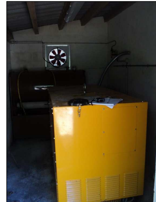
Groupe électrogène et cuve de stockage fioul
