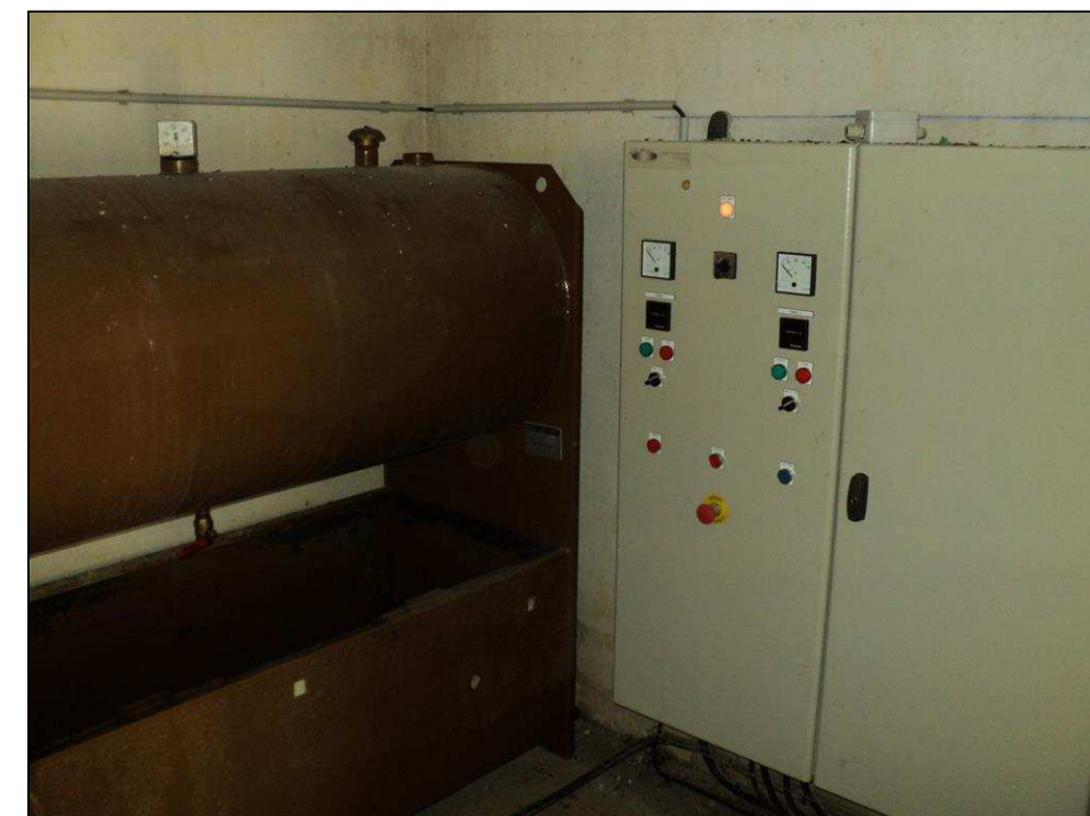
Vue de la cuve de stockage du fioul et de l'armoire électrique
