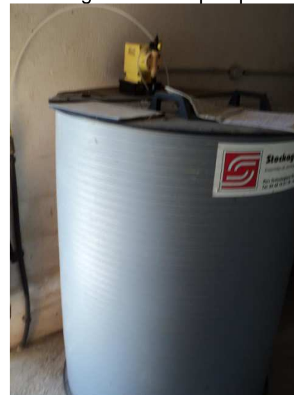
Cuve stockage nutriox et pompe doseuse
