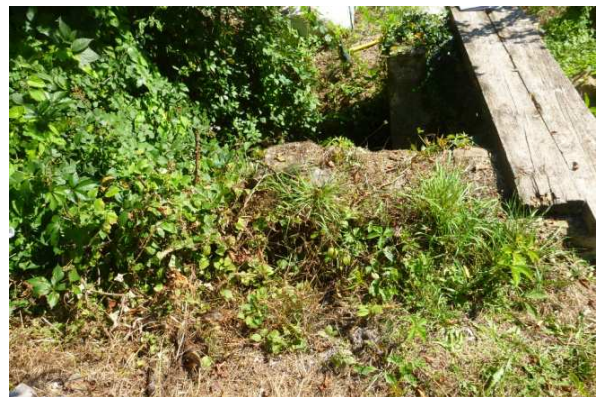
Encoche d'érosion derrière le pilier
