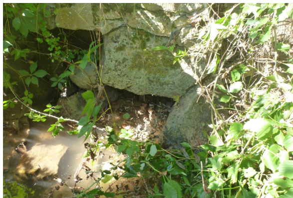
Affouillement au pied du pilier en rive gauche
