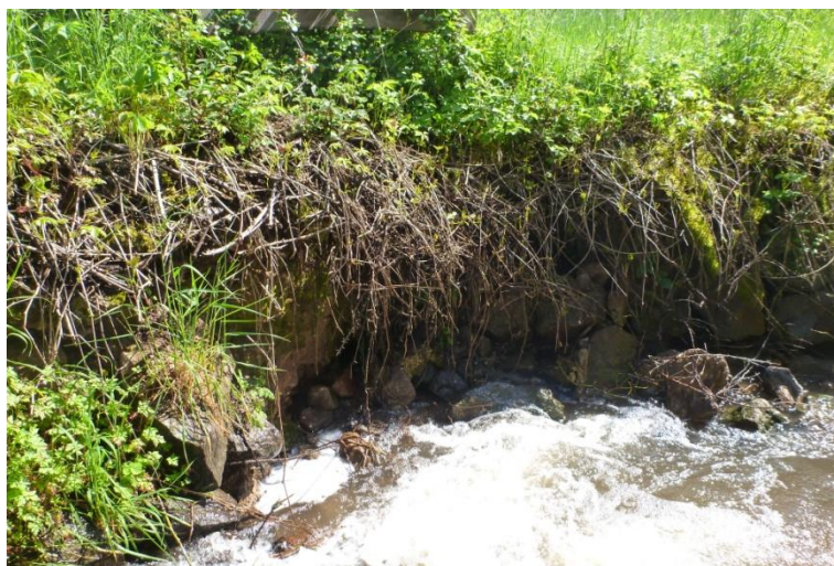
Figure 20 : photographie de l'érosion prononcée en rive gauche à l'exutoire du cadre.
