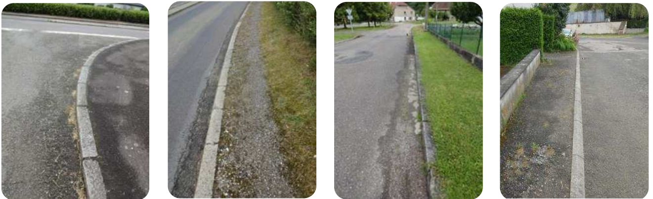
Exemple de divers revêtement dans les rues de Saulnot, qui témoignent d'un état variable de la voirie.
