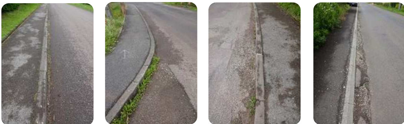
Exemple de divers revêtement dans les rues de Chenebier, qui témoignent d'un état variable de la voirie.
