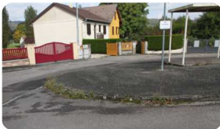
Exemple de divers revêtement dans les rues de Champey, qui témoignent d'un état variable de la voirie.
