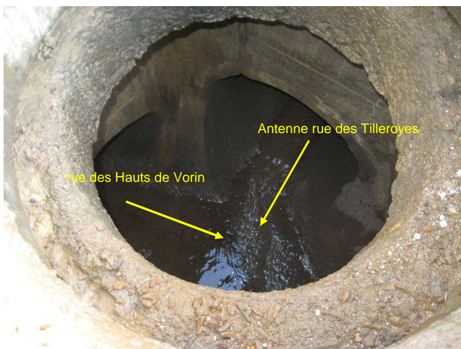
Figure n° 5 : Arrivées en Ø 600 (rue des Hauts de Vorin et antenne rue des Tilleroyes) - départ en Ø 600 vers le bassin d'infiltration Eurespace
