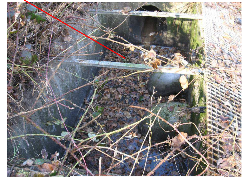
Arrivée des EP et alimentation du bassin
