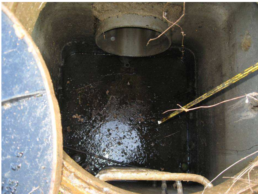
Figure n° 14 : Puits perdu à l'exutoire du lotissement
