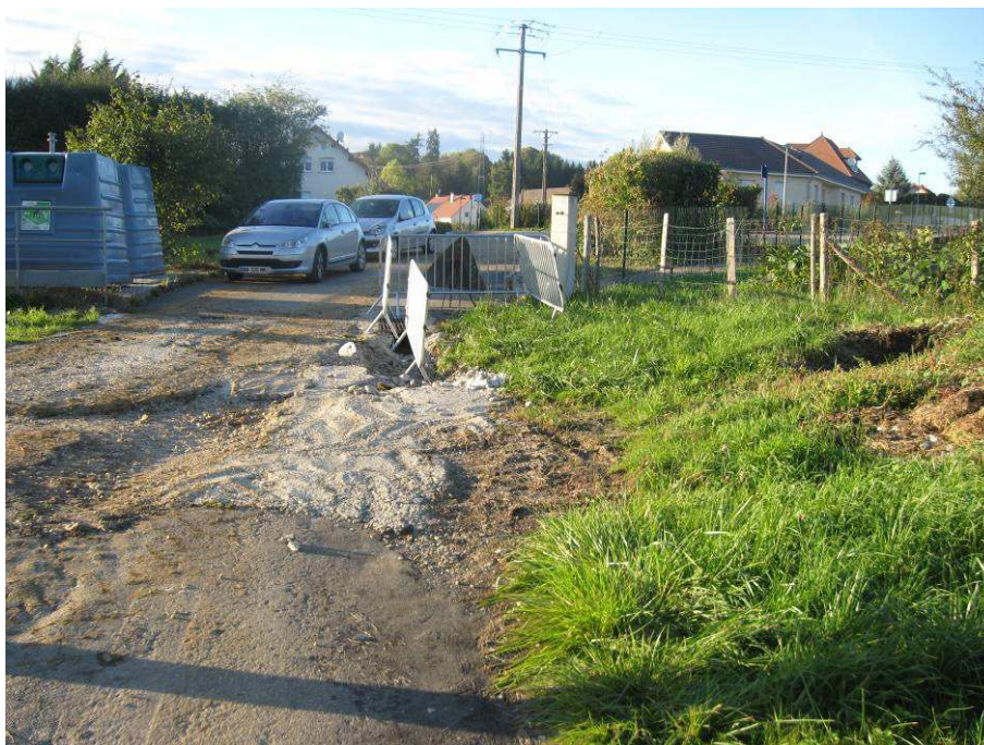
Figure n° 11 : Exutoire de la canalisation EP doublée, rue des Hauts de Vorin
