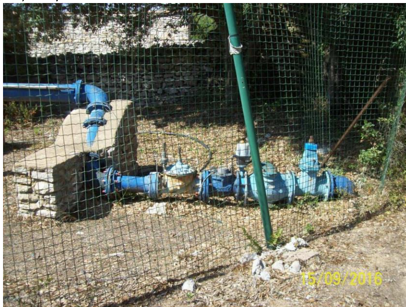
Conduite d'amenée de l'eau brute à la station de Cavallo Morto
