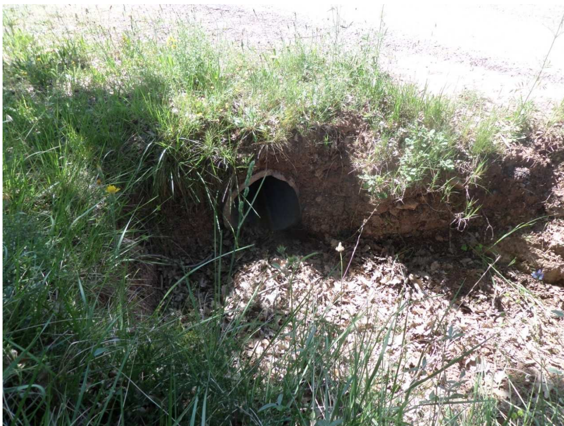
P63 : amont (buse DN400) aval (buse DN500)
