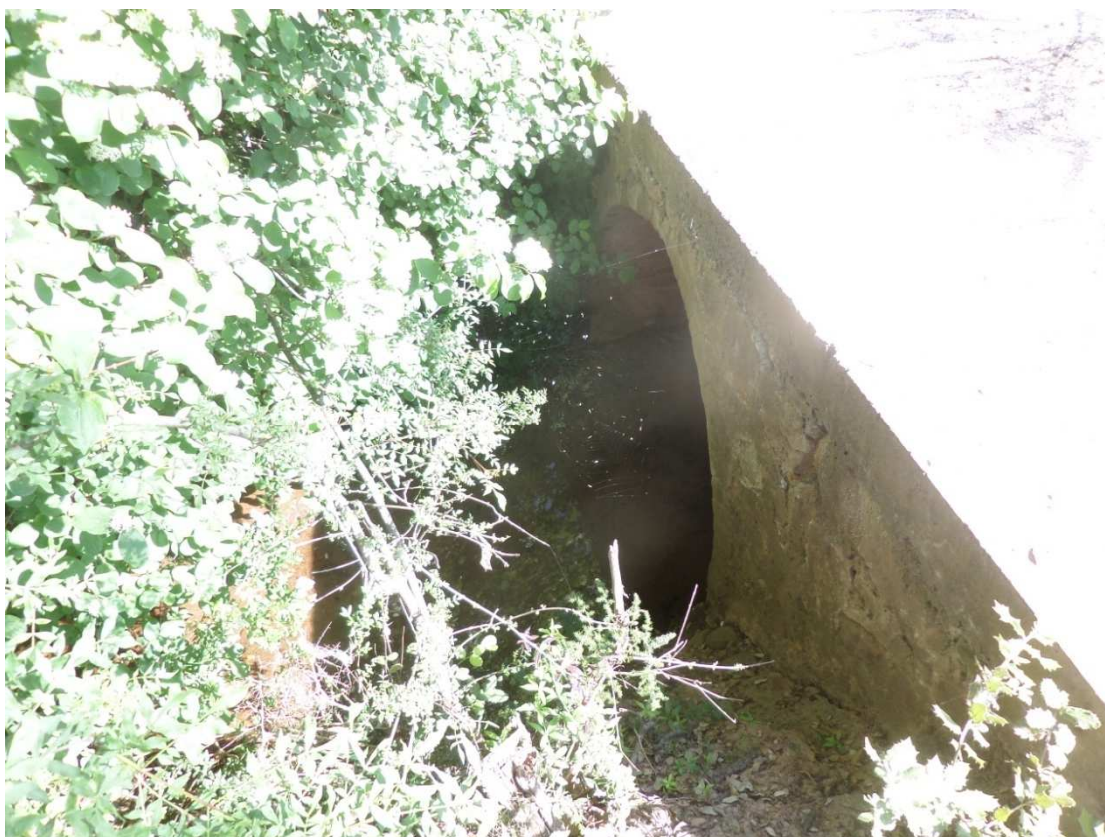
P52 : amont (cadre / hauteur : 1,25m / largeur : 1,4m) aval DN 1250
