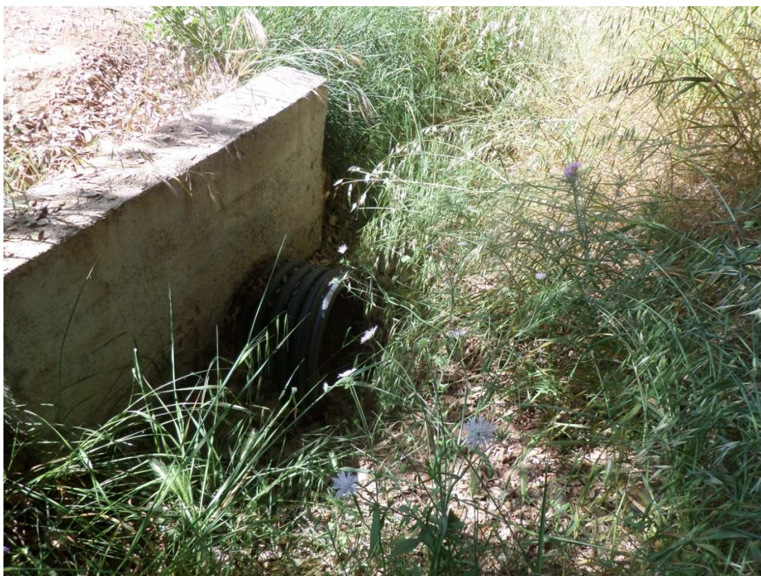
P60 : amont (buse DN500) aval (buse DN300)
