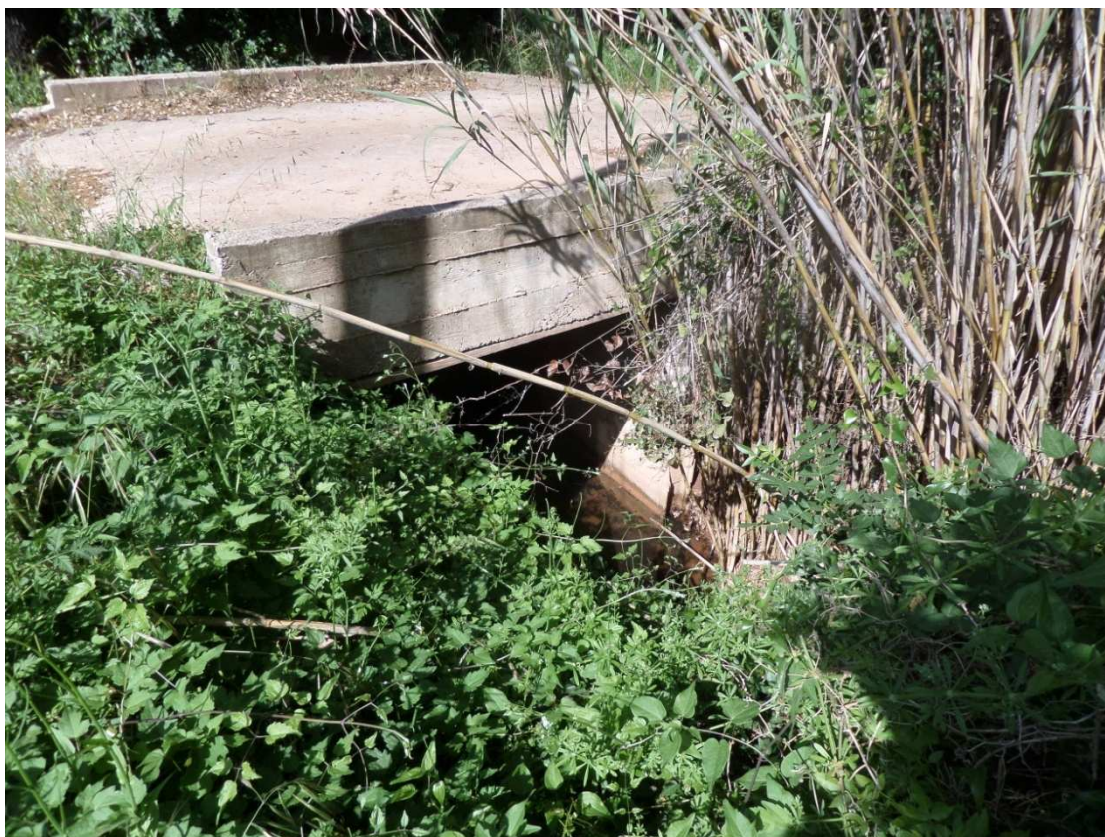
P51 : amont (cadre / hauteur : 1,7m / largeur : 2,1m) aval DN 1500
