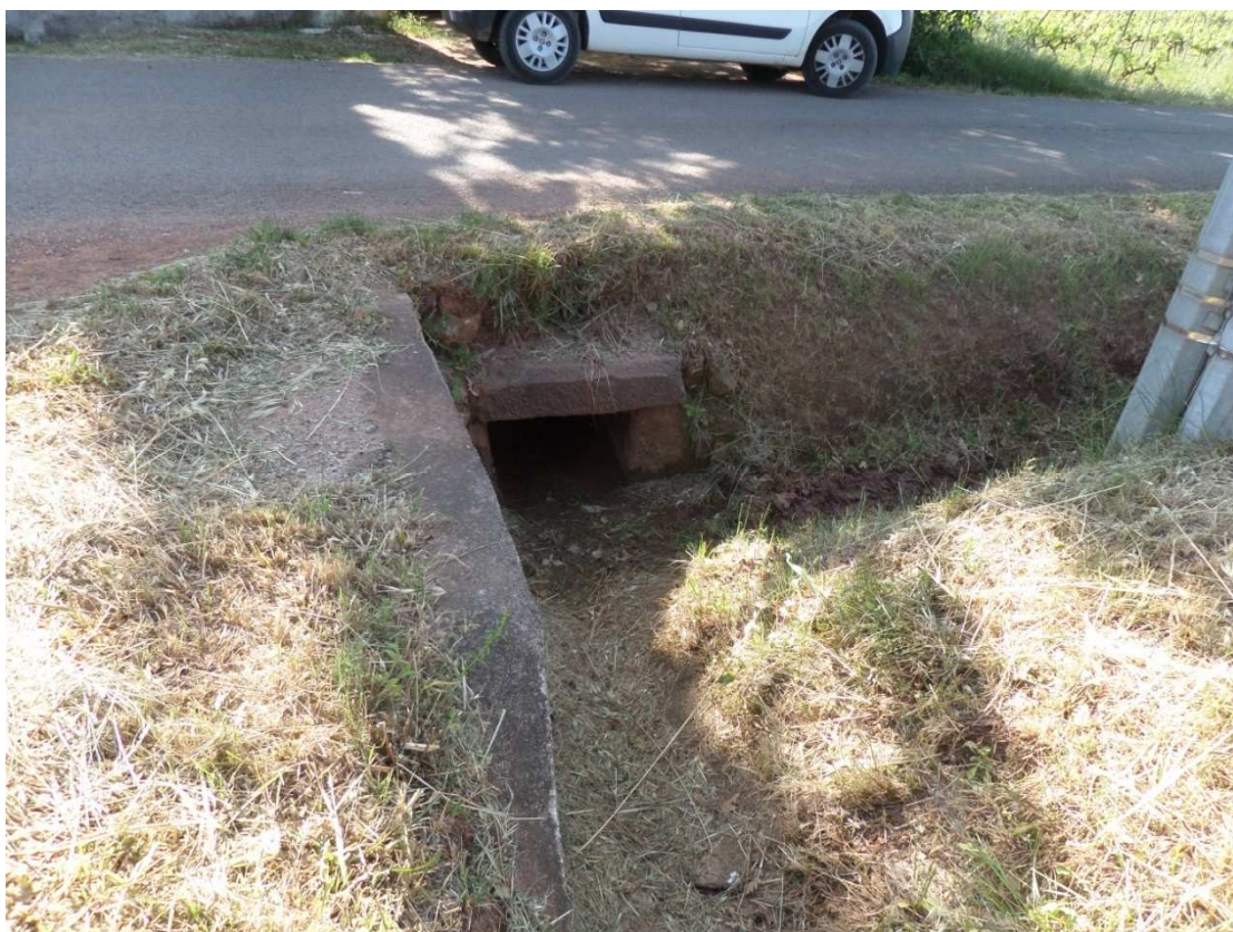
P48 : amont (cadre hauteur : 0,45m / largeur : 0,6m) aval DN 600
