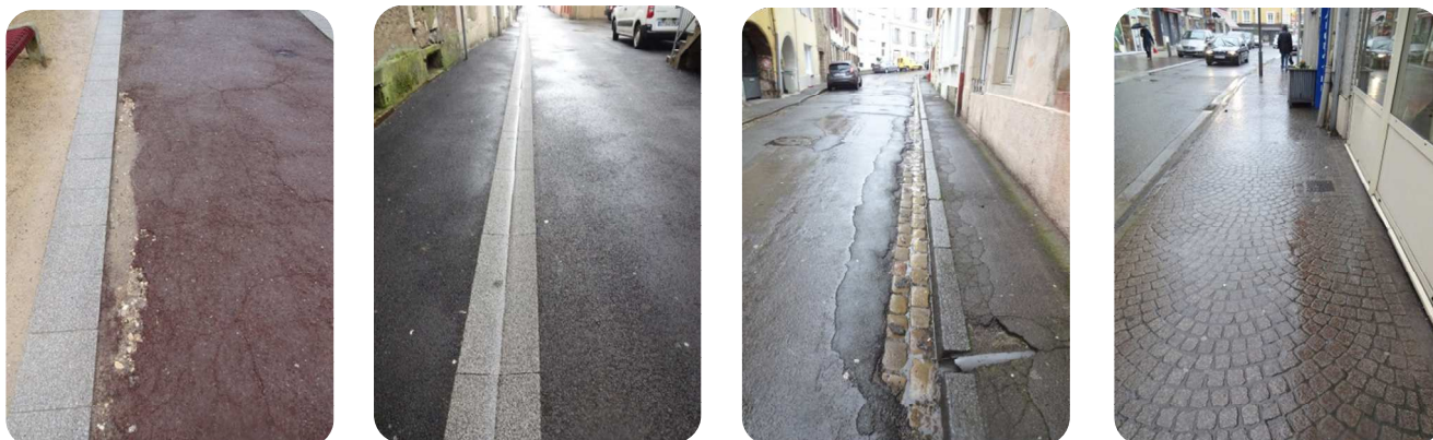
Exemple de divers revêtement dans les rues d'Héricourt, qui témoignent d'un état variable de la voirie.
