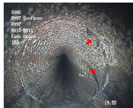
Joint défectueux et corrosion
