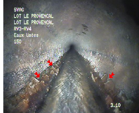
Dégradation du revêtement
