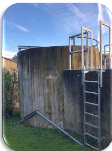
Figure 3 : Silo de stockage des boues
