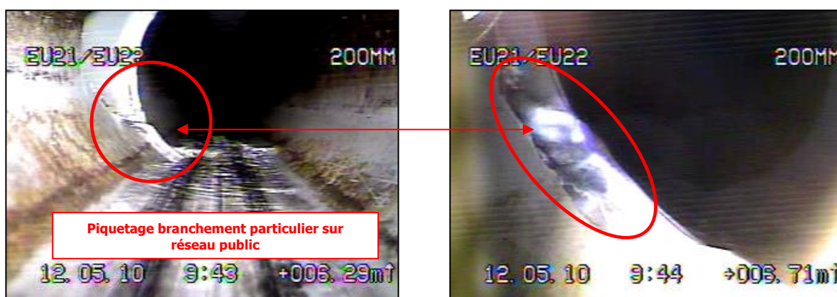
Figure 3 : Exemple d'intrusions d'ECPP sur un branchement raccordé au réseau principal
