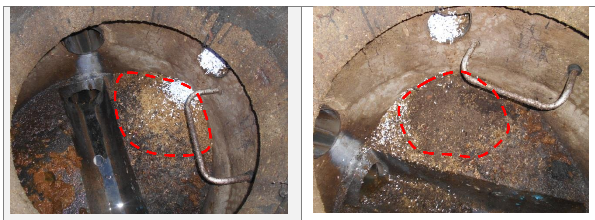
Figure 10 : Amas de terre présent au pied de la canalisation du DO
