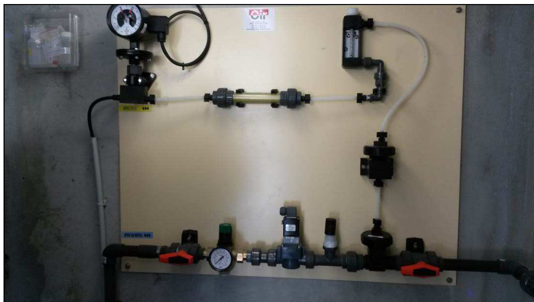
Photo 10 : Traitement au chlore dans la chambre de vanne du réservoir de Serre Moulet
