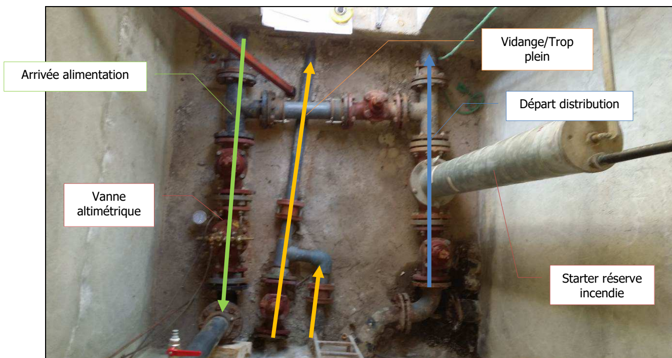
Photo 8 : Chambre de vannes - réservoir Village
