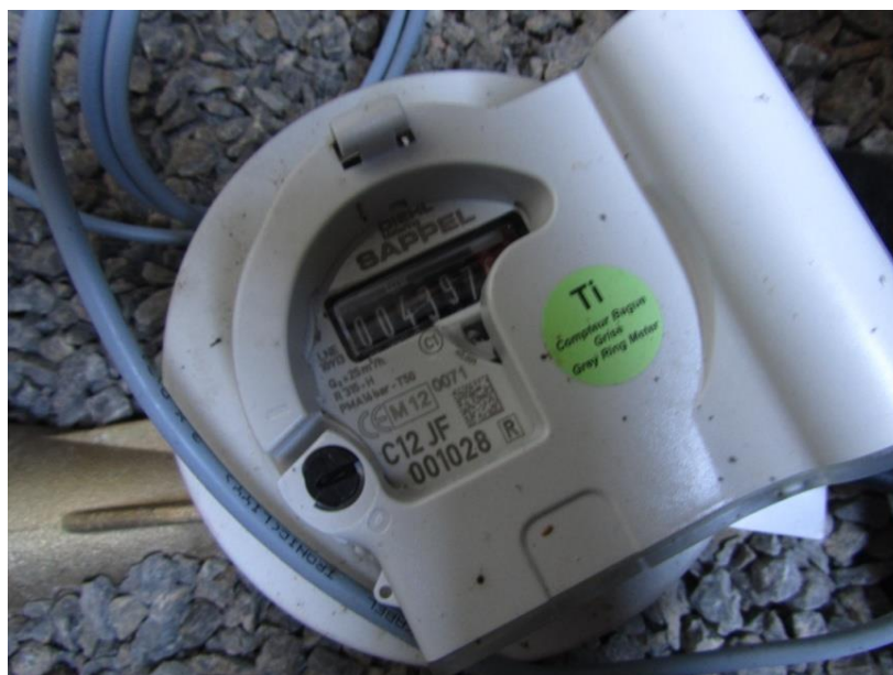
Figure 28 : Compteur sur la distribution
