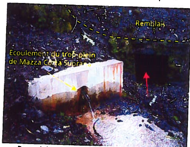
Regard de captage de Mazza Corta Suttana (fleche rouge)
