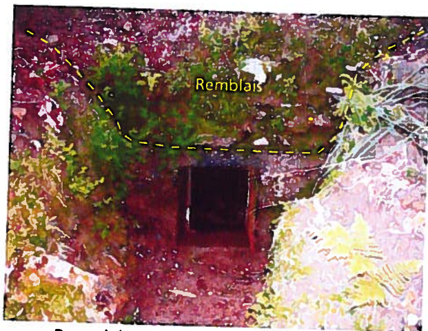
Regard de captage de Mazza Corta Suprana
