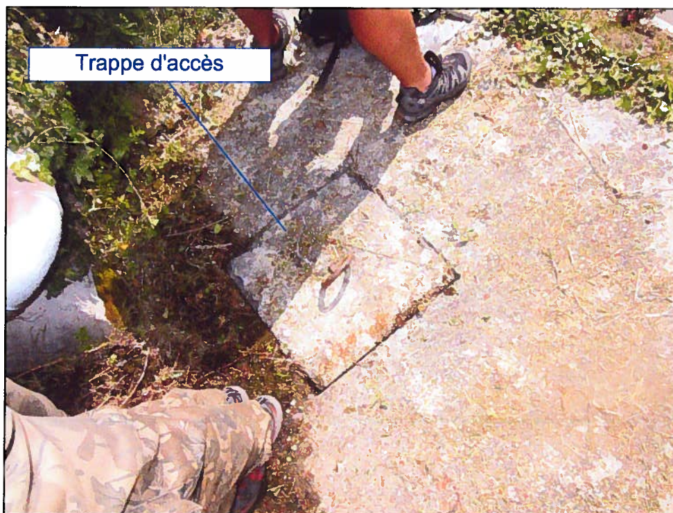
Chambre à vannes
