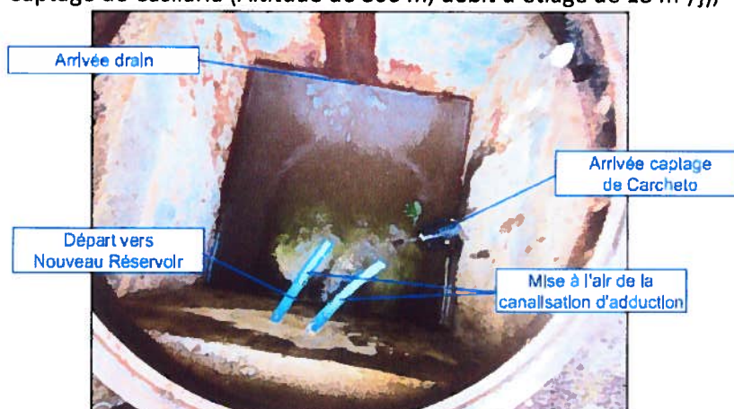
Photo 2 : Intérieur du regard collecteur du captage de Casilaria
