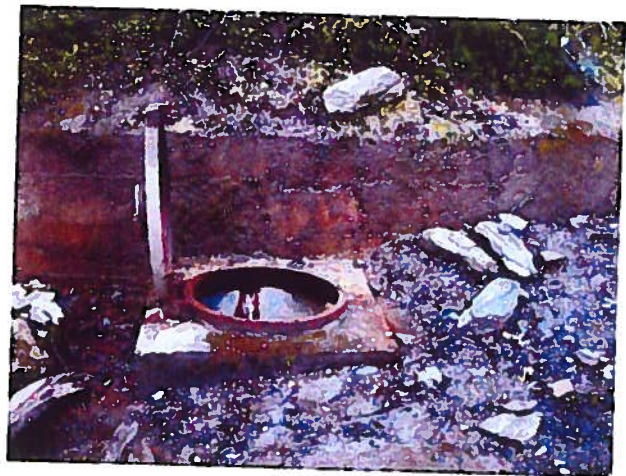
Regard de captage de Casilaria
