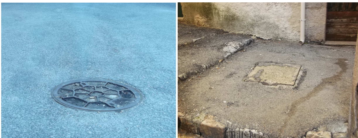
Figure 17 : Photographie de regard non étanche
