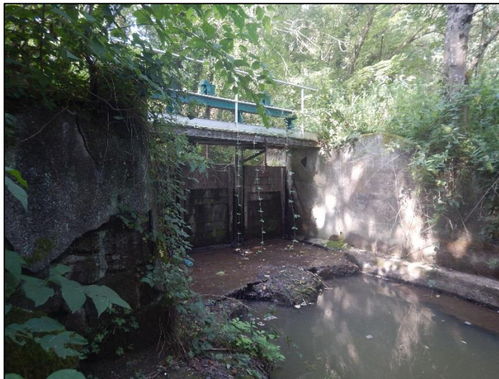
Fig. 8. Vannes de décharge
