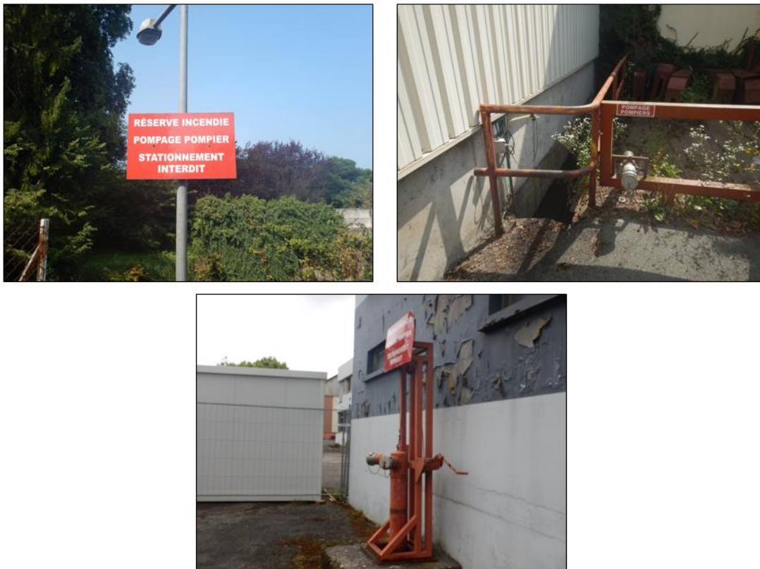
Fig. 20. Différents pompages pompiers sur le site
