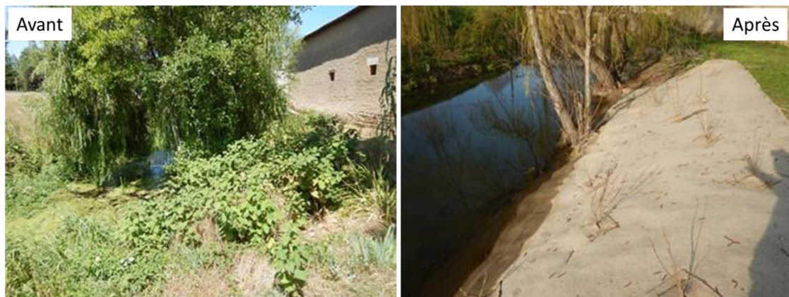
Fig. 65. Exemple de travaux concernant le traitement de la Renouée du Japon (Sablonne à Saint Loup 39)
