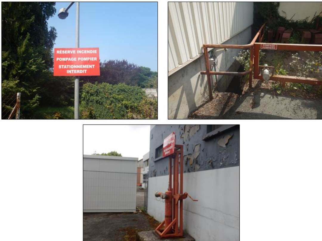
Fig. 20. Différents pompages pompiers sur le site
