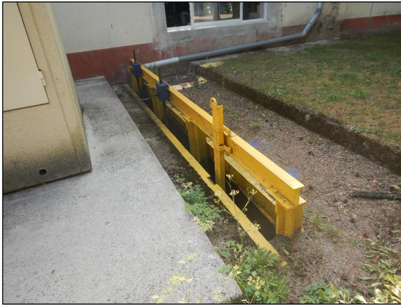
Fig. 13. Vannage de prise d'eau
