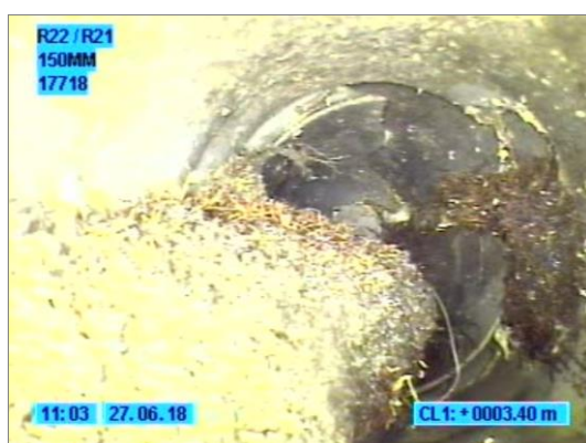
Figure 13 : Visualisation de racines créant une obstruction dans la canalisation (tronçon R21-R22)
