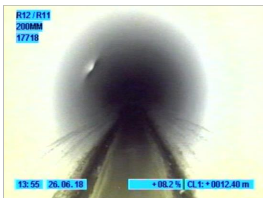
Figure 14 : Visualisation d'un poinçonnement (tronçon R11-R12)
