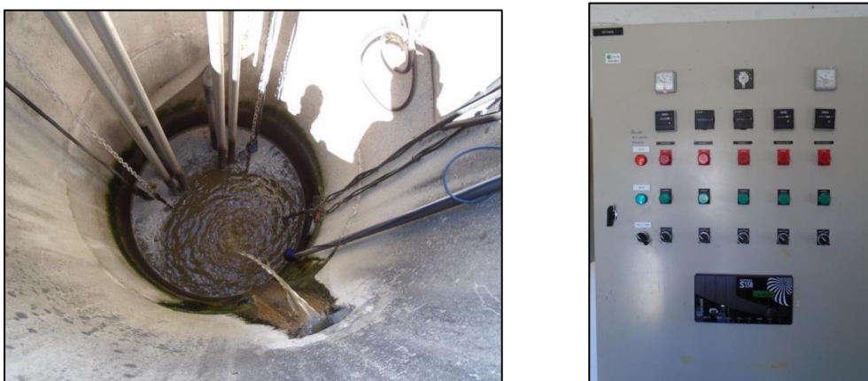
Figure 21 : Photographies du PR de la STEP
