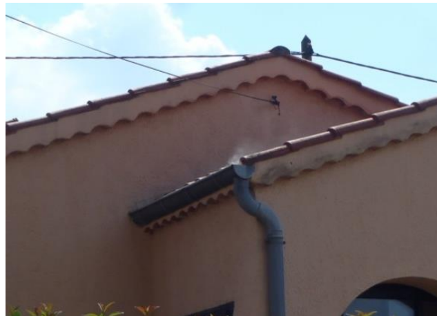
2 - Identification de tous les organes laissant s'échapper la fumée
