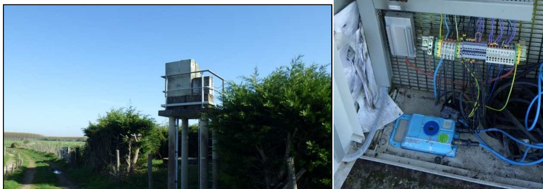
Photos 4 : Point de mesure Poste de refoulement
