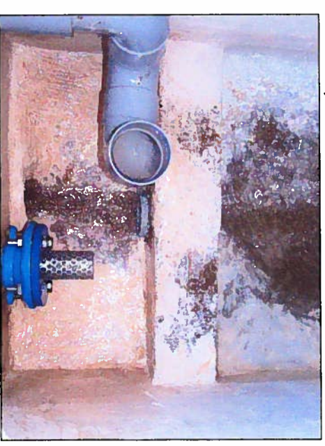
avec crépine sur adduction et siphon sur trop plein
