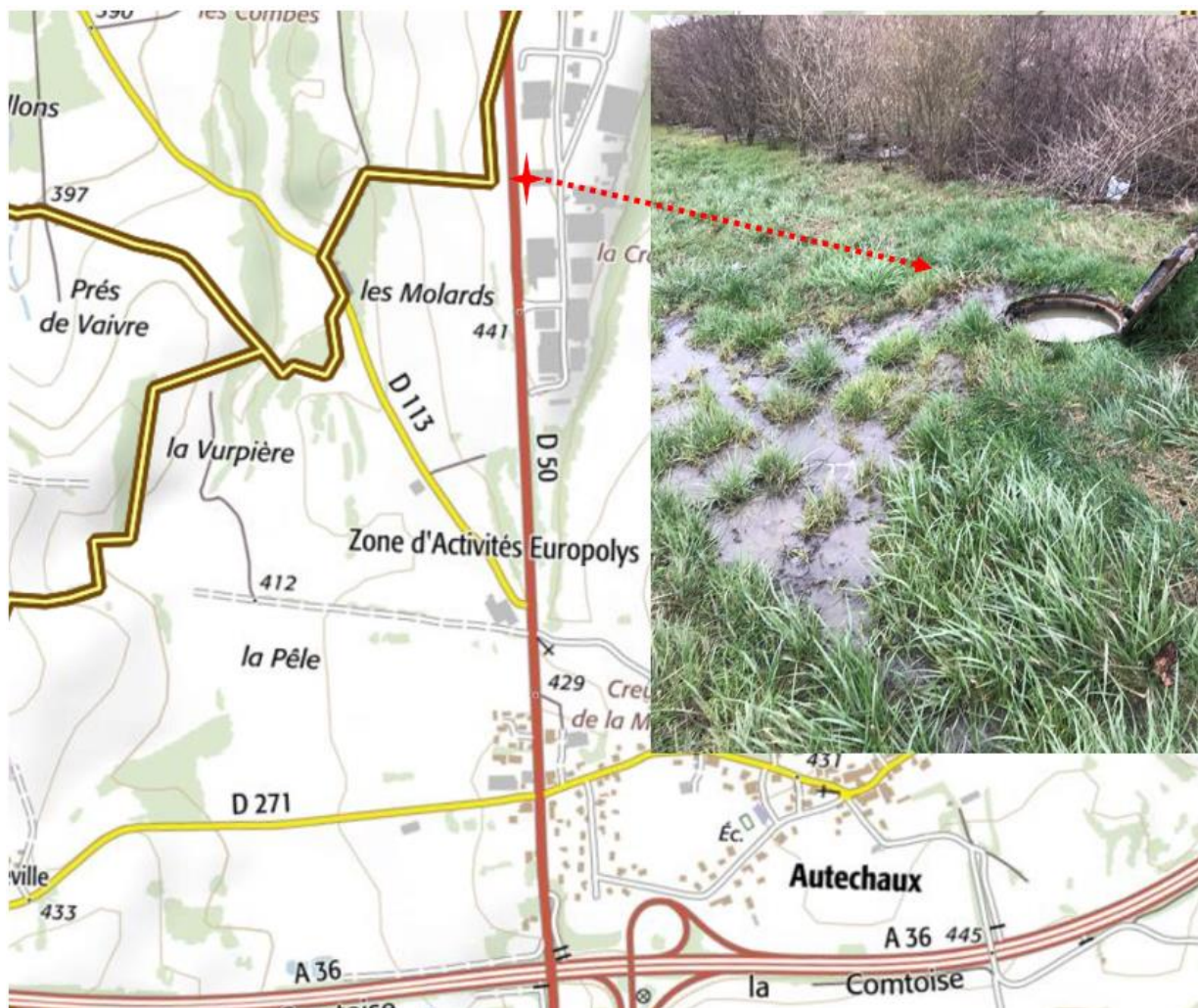
Figure 16 : Mise en charge du réseau (R 183) à la zone d'activité Europolys
