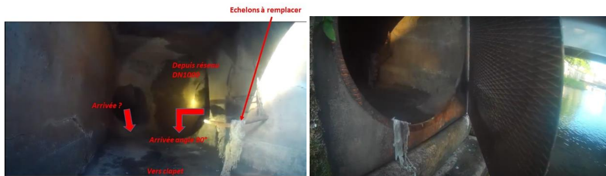
Figure 5. Vue de l'intérieur du regard en amont du clapet (image de gauche) et du clapet anti-retour (image de droite) du DO15 Théâtre (Source : 3D EAU).
