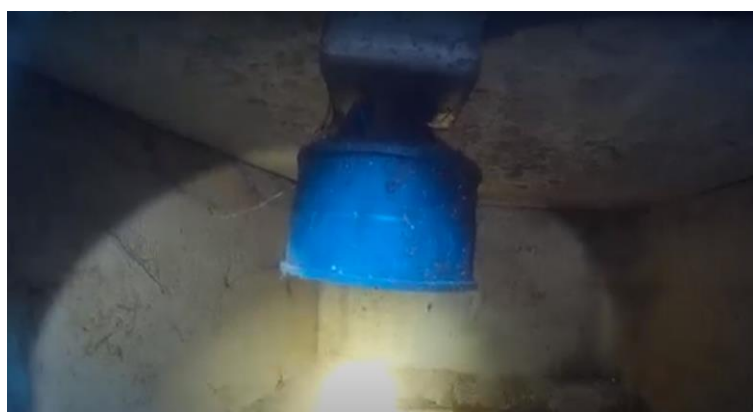
Figure 32. Capteur de niveau d'eau actuel situé dans la chambre DO16 Degombert en amont de la crête déversante (Source : 3D EAU).
