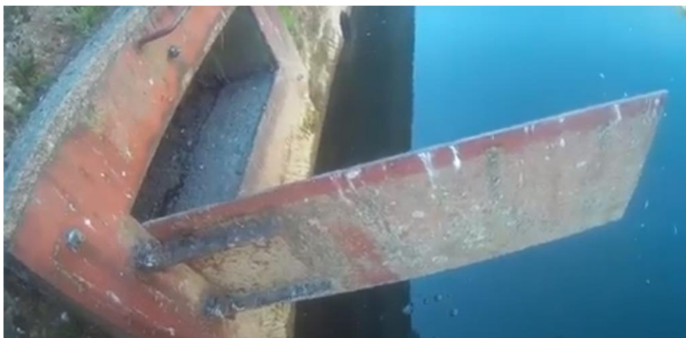
Figure 5. Vue du clapet anti-retour du DO16 Degombert (Source : 3D EAU).
