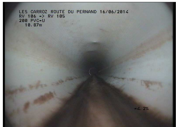
Photo: 2_4A, MPEG #: 160614_1, 00:01:14 11,26m, Poinçonnement à 12 h.
