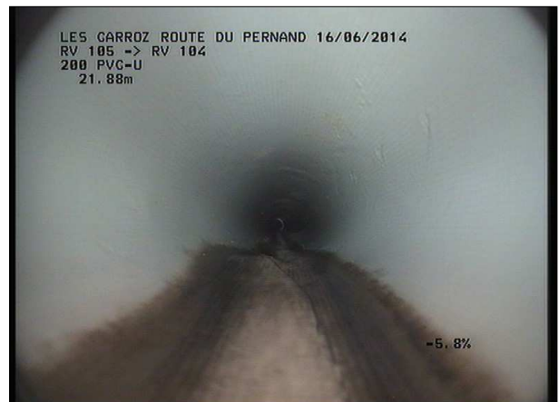
Photo: 3_7A, MPEG #: 160614_1, 00:03:04 22,26m, Fissure longitudinale à 06 h suite à écrasement vertical avec déformation du fil d'eau
