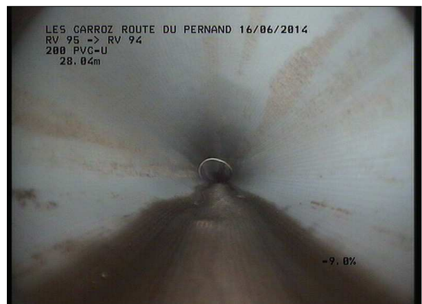
Photo: 13_4A, MPEG #: 160614_1, 00:02:32 28,33m, Poinçonnement de 06 à 07 h.
