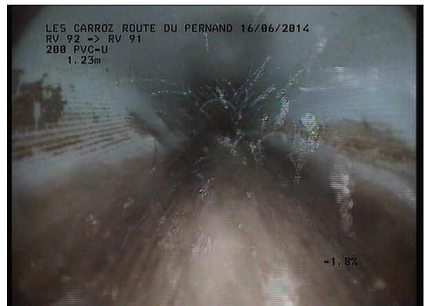
Photo: 16_2A, MPEG #: 160614_1, 00:01:07 1,52m, Fissure longitudinale à 07 h.
