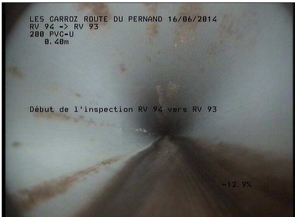
Photo: 14_1A, MPEG #: 160614_1, 00:00:00 0,4m, Début de l'inspection RV 94 SCERCL vers RV 90 SCERCL
