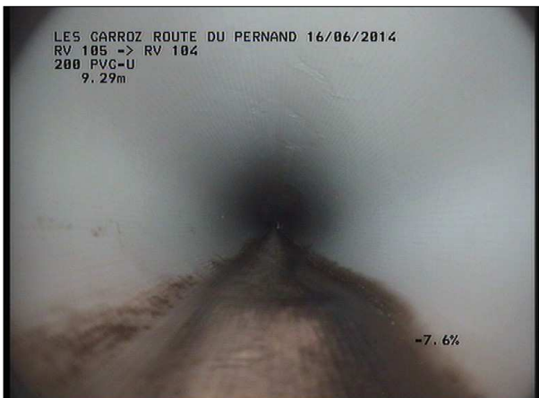
Photo: 3_3A, MPEG #: 160614_1, 00:01:10 9,41m, Ecrasement vertical avec déformation du fil d'eau
