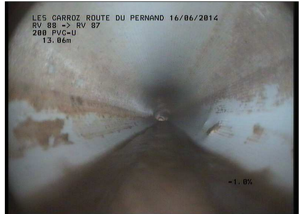
Photo: 20_2A, MPEG #: 160614_1, 00:00:58 13,37m, Poinçonnement à 04 h.
