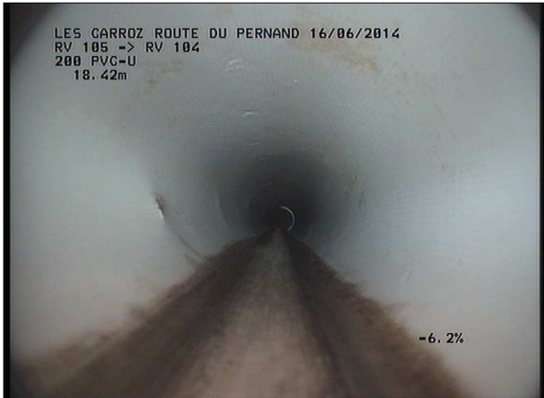
Photo: 3_5A, MPEG #: 160614_1, 00:02:20 18,69m, Poinçonnement à 09 h.
