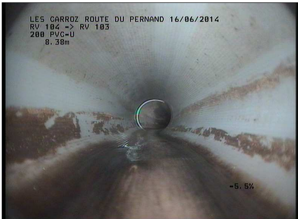
Photo: 4_5A, MPEG #: 160614_1, 00:01:34 8,59m, Ecrasement vertical avec déformation du fil d'eau
