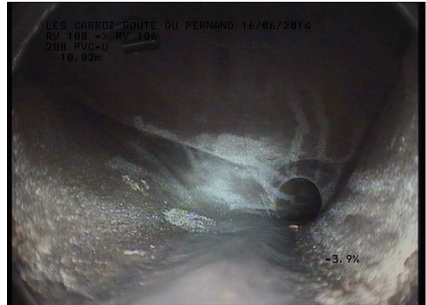
Photo: 1_2A, MPEG #: 160614_1, 00:00:56 10,62m, Fin de l'inspection RV 106 SOUS ENROBES
