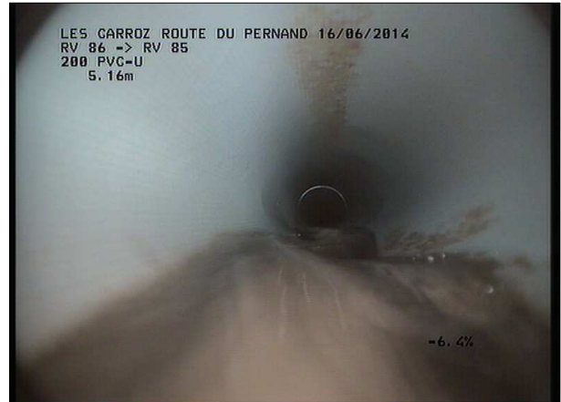
Photo: 22_5A, MPEG #: 160614_1, 00:01:17 5,16m, Ecrasement vertical avec déformation du fil d'eau
