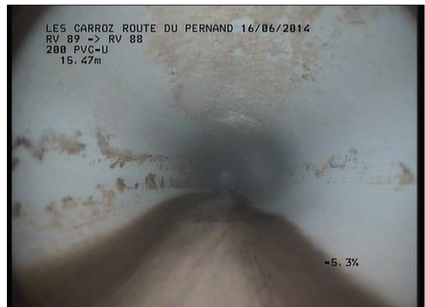
Photo: 19_4A, MPEG #: 160614_1, 00:01:46 15,47m, Ecrasement vertical avec déformation du fil d'eau
