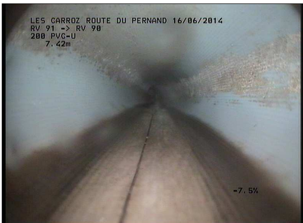
Photo: 17_3A, MPEG #: 160614_1, 00:01:02 7,62m, Fissure longitudinale à 06 h.
