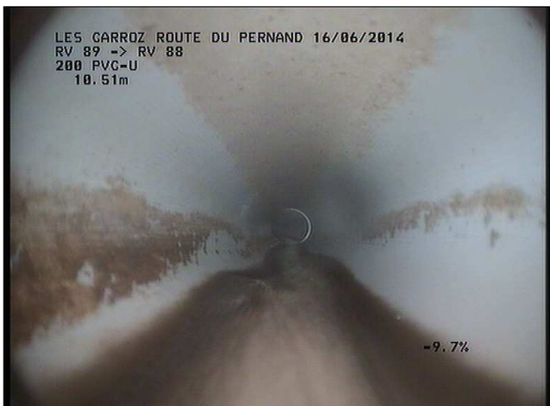
Photo: 19_3A, MPEG #: 160614_1, 00:01:06 10,76m, Ecrasement vertical avec déformation du fil d'eau
