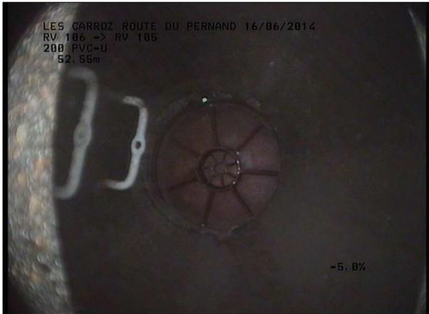
Photo: 2_7B, MPEG #: 160614_1, 00:04:39 52,55m, Fin de l'inspection RV 105 Présence e racines dans REGARD RV 105
