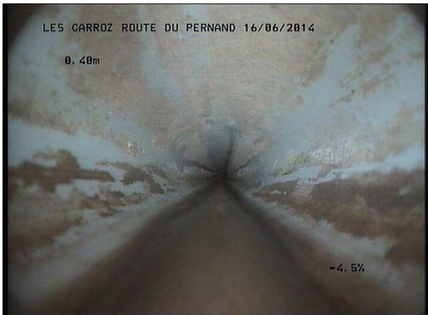
Photo: 13_1A, MPEG #: 160614_1, 00:00:00 0,4m, Début de l'inspection RV 96 SCERCL vers RV 94 SCERCL
