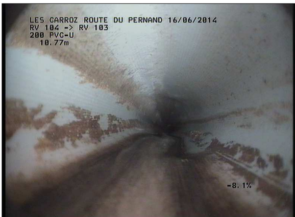
Photo: 4_7A, MPEG #: 160614_1, 00:02:21 11,13m, Ecrasement vertical avec déformation du fil d'eau
