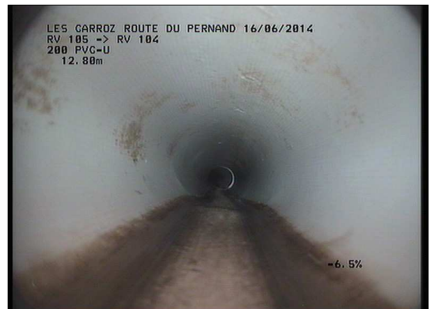
Photo: 3_4A, MPEG #: 160614_1, 00:01:42 13,14m, Ecrasement vertical avec déformation du fil d'eau
