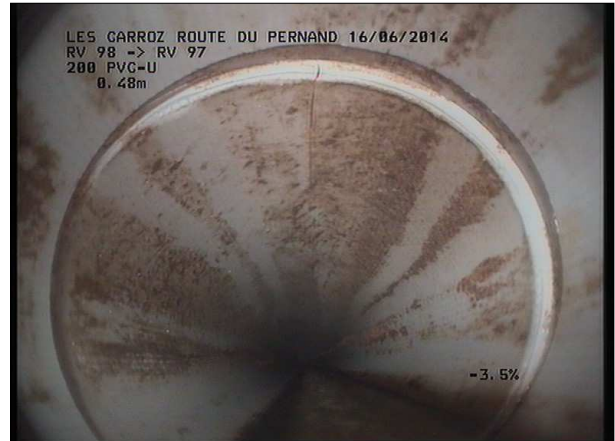
Photo: 10_2A, MPEG #: 160614_1, 00:00:25 0,63m, Fissure longitudinale à 12 h.
