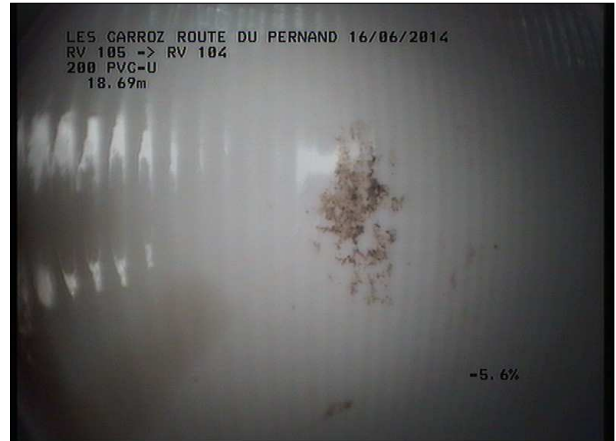
Photo: 3_5B, MPEG #: 160614_1, 00:02:20 18,69m, Poinçonnement à 09 h.
