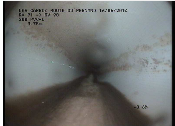
Photo: 17_2A, MPEG #: 160614_1, 00:00:24 3,75m, Ecrasement vertical avec déformation du fil d'eau
