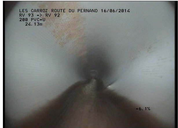
Photo: 15_2A, MPEG #: 160614_1, 00:01:37 24,42m, Poinçonnement à 04 h.
