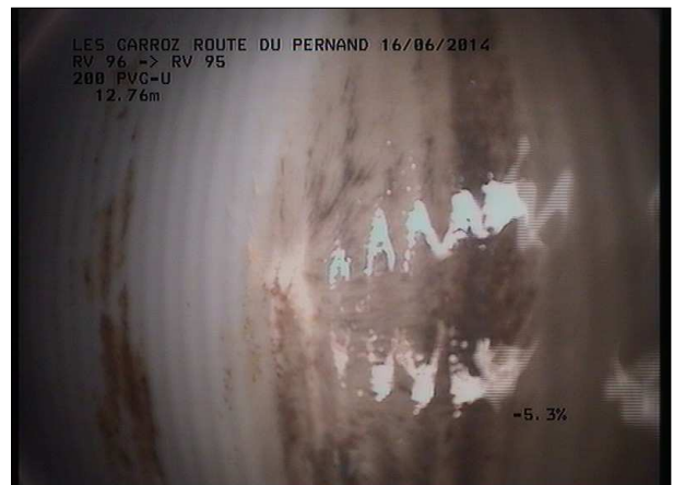
Photo: 12_3B, MPEG #: 160614_1, 00:01:19 12,76m, Poinçonnement à 07 h.
