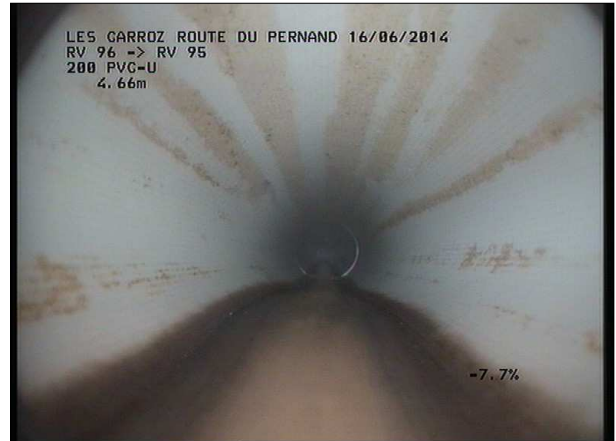
Photo: 12_2A, MPEG #: 160614_1, 00:00:26 5,1m, Ecrasement vertical avec déformation du fil d'eau
