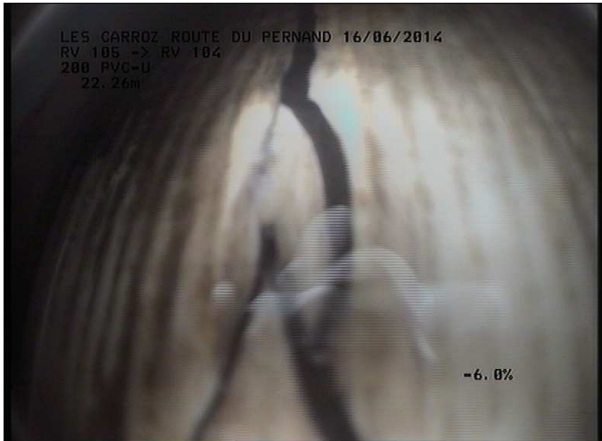
Photo: 3_7B, MPEG #: 160614_1, 00:03:04 22,26m, Fissure longitudinale à 06 h suite à écrasement vertical avec déformation du fil d'eau
