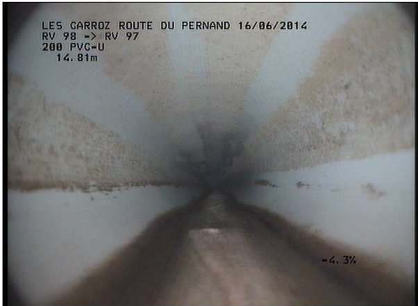
Photo: 10_4A, MPEG #: 160614_1, 00:01:59 15,05m, Poinçonnement à 06 h.
