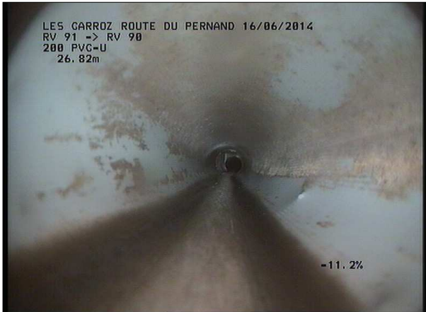
Photo: 17_4A, MPEG #: 160614_1, 00:02:52 27,11m, Poinçonnement à 04 h.
