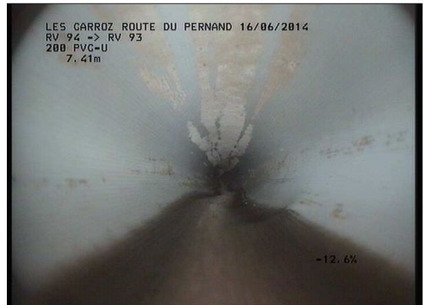
Photo: 14_2A, MPEG #: 160614_1, 00:00:32 7,72m, Ecrasement vertical avec déformation du fil d'eau
