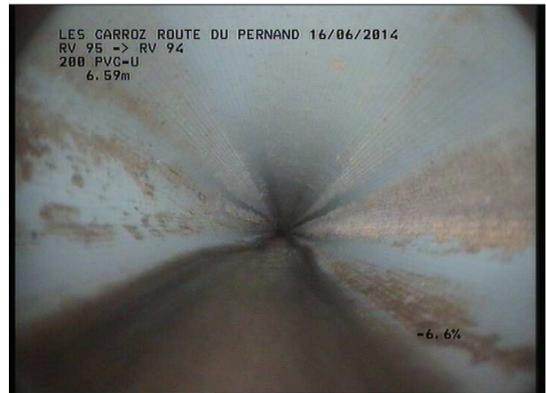
Photo: 13_2A, MPEG #: 160614_1, 00:00:38 6,59m, Ecrasement vertical avec déformation du fil d'eau
