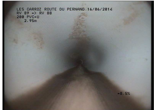
Photo: 19_2A, MPEG #: 160614_1, 00:00:19 3,16m, Ecrasement vertical avec déformation du fil d'eau
