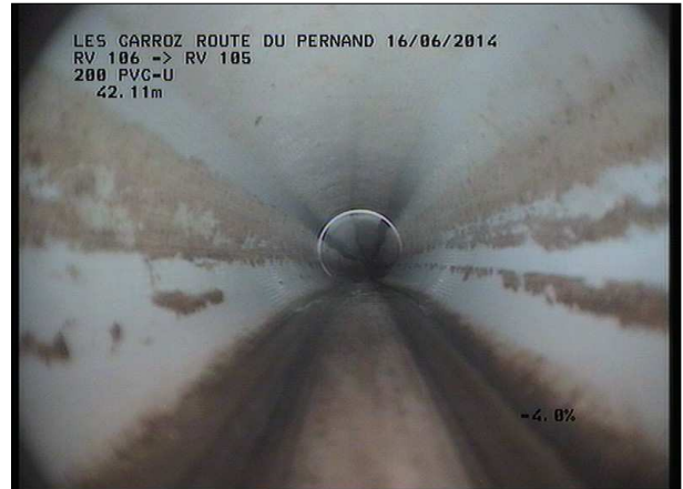
Photo: 2_5A, MPEG #: 160614_1, 00:03:28 42,5m, Ecrasement vertical avec déformation du fil d'eau
