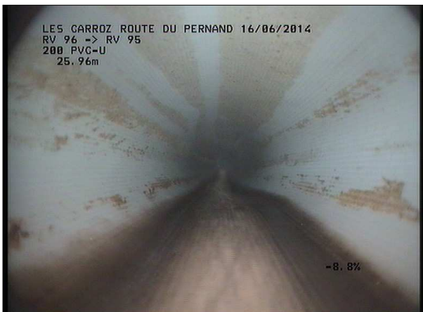
Photo: 12_5A, MPEG #: 160614_1, 00:02:42 26,29m, Ecrasement vertical avec déformation du fil d'eau
