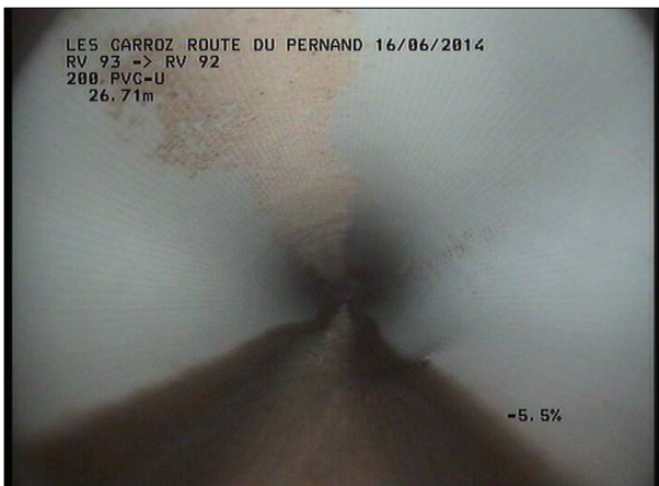
Photo: 15_3A, MPEG #: 160614_1, 00:01:58 26,94m, Poinçonnement à 05 h.
