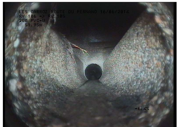
Photo: 2_7A, MPEG #: 160614_1, 00:04:39 52,55m, Fin de l'inspection RV 105 Présence e racines dans REGARD RV 105
