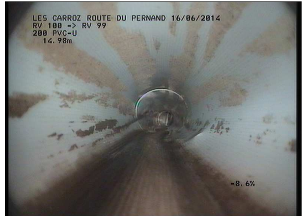
Photo: 8_5A, MPEG #: 160614_1, 00:02:59 15,24m, Poinçonnement de 04 à 05 h.
