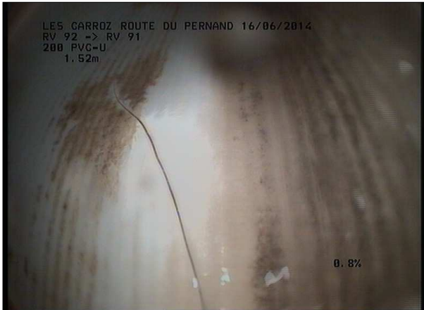
Photo: 16_2B, MPEG #: 160614_1, 00:01:07 1,52m, Fissure longitudinale à 07 h.
