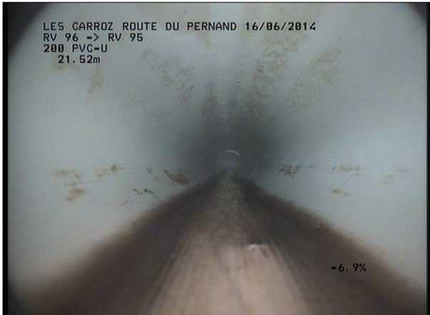
Photo: 12_4A, MPEG #: 160614_1, 00:02:09 21,73m, Poinçonnement à 05 h.
