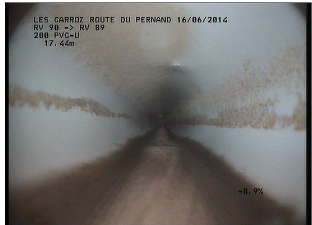
Photo: 18_2A, MPEG #: 160614_1, 00:01:24 17,82m, Ecrasement vertical avec déformation de voûte et fil d'eau
