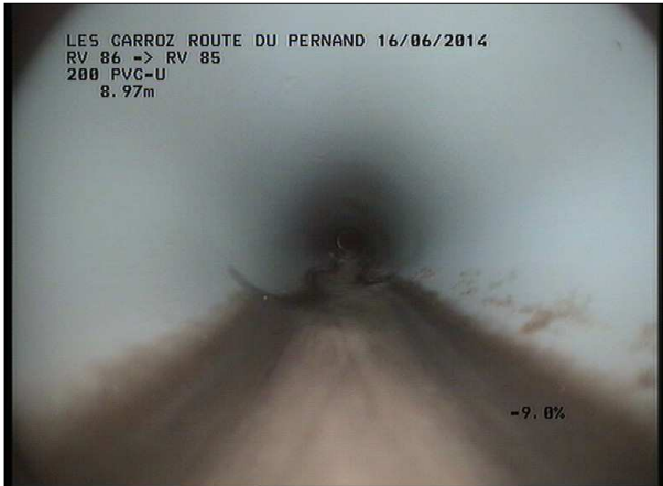
Photo: 22_7A, MPEG #: 160614_1, 00:02:14 9,29m, Ecrasement vertical avec déformation du fil d'eau
