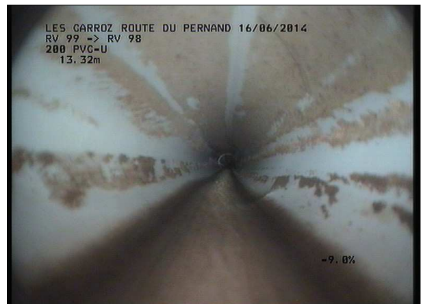
Photo: 9_4A, MPEG #: 160614_1, 00:01:30 13,62m, Poinçonnement à 04 h.
