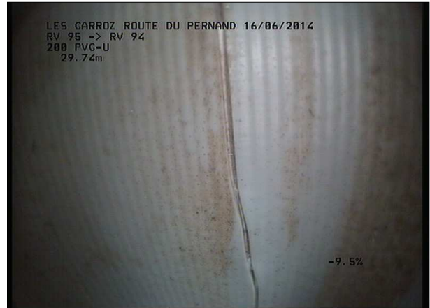
Photo: 13_5B, MPEG #: 160614_1, 00:02:55 29,74m, Fissure longitudinale à 01 h.
