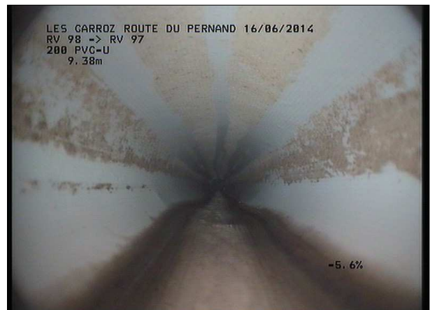
Photo: 10_3A, MPEG #: 160614_1, 00:01:19 9,69m, Ecrasement vertical avec déformation du fil d'eau
