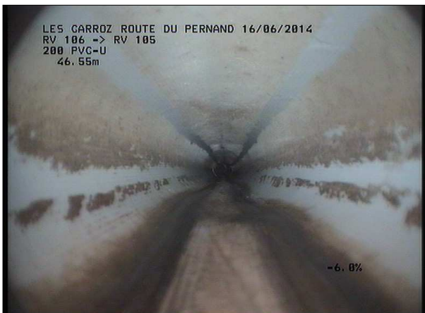
Photo: 2_6A, MPEG #: 160614_1, 00:04:01 46,76m, Ecrasement vertical avec déformation du fil d'eau
