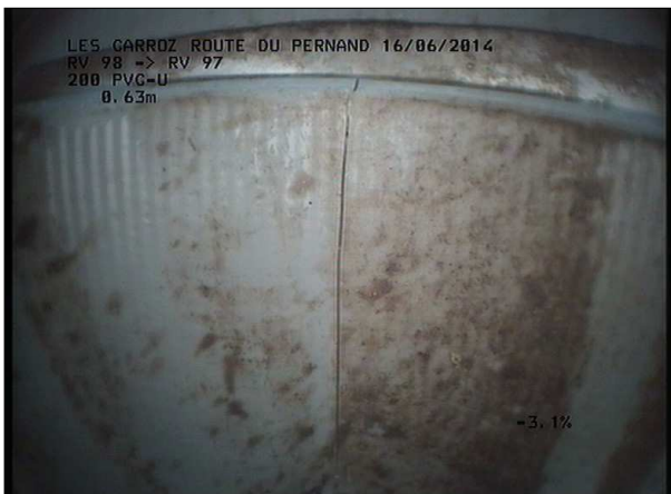
Photo: 10_2B, MPEG #: 160614_1, 00:00:25 0,63m, Fissure longitudinale à 12 h.
