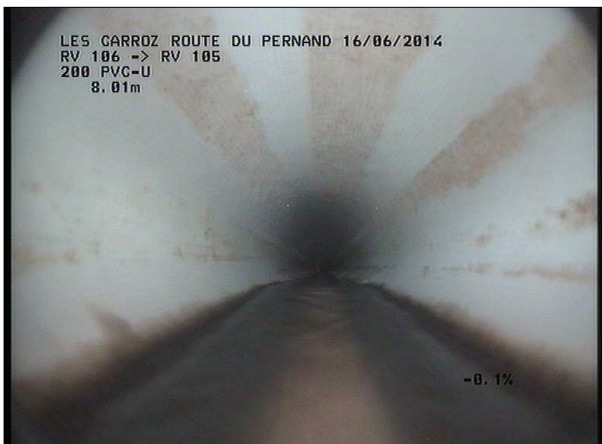
Photo: 2_3A, MPEG #: 160614_1, 00:00:46 8,46m, Ecrasement vertical avec déformation du fil d'eau
