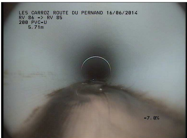
Photo: 22_6A, MPEG #: 160614_1, 00:01:41 5,9m, Fissure longitudinale fermée à 06 h.
