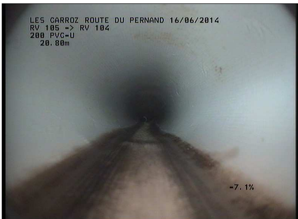
Photo: 3_6A, MPEG #: 160614_1, 00:02:44 21,05m, Ecrasement vertical avec déformation du fil d'eau
