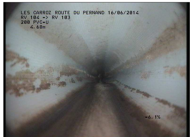
Photo: 4_4A, MPEG #: 160614_1, 00:00:58 5,26m, Ecrasement vertical avec déformation du fil d'eau
