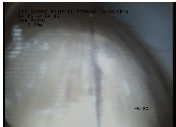
Photo: 22_6B, MPEG #: 160614_1, 00:01:41 5,9m, Fissure longitudinale fermée à 06 h.
