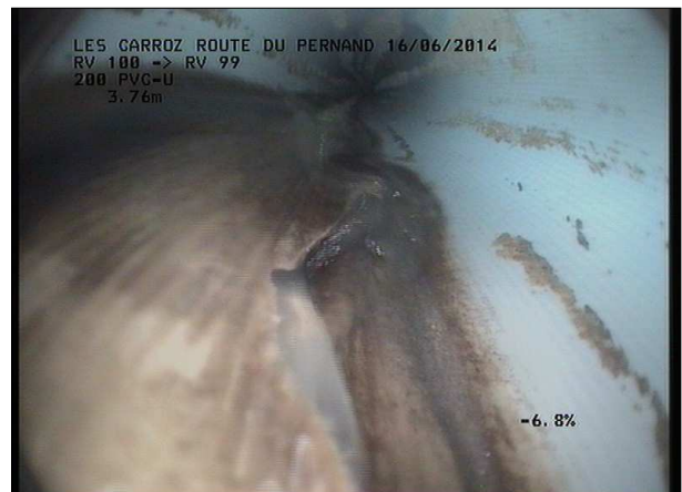
Photo: 8_2B, MPEG #: 160614_1, 00:01:05 3,76m, Fissure longitudinale à 05 h.
