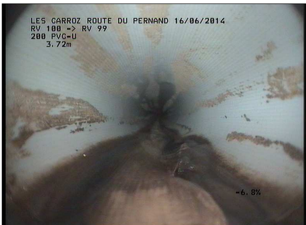
Photo: 8_3A, MPEG #: 160614_1, 00:01:05 3,76m, Fissure longitudinale à 05 h.
