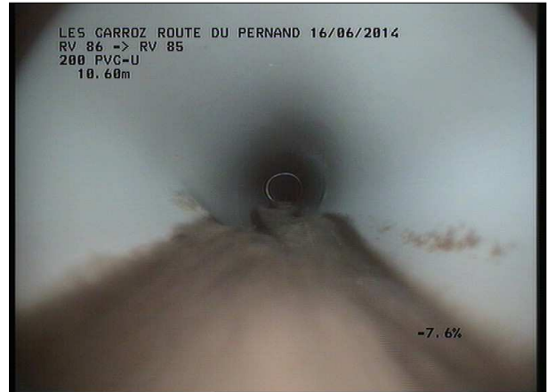
Photo: 22_8A, MPEG #: 160614_1, 00:02:38 10,82m, Ecrasement vertical avec déformation du fil d'eau
