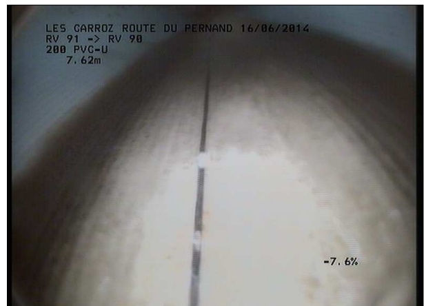
Photo: 17_3B, MPEG #: 160614_1, 00:01:02 7,62m, Fissure longitudinale à 06 h.
