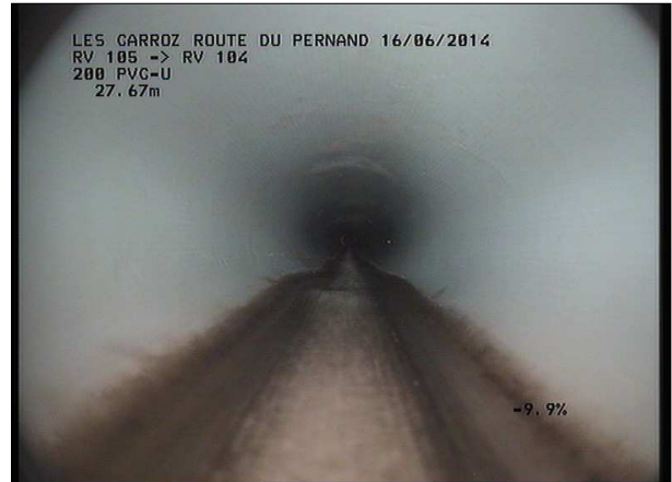
Photo: 3_8A, MPEG #: 160614_1, 00:04:19 28,04m, Ecrasement vertical avec déformation du fil d'eau
