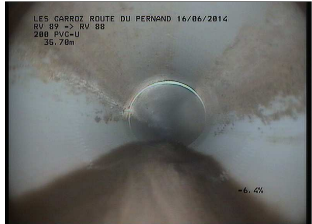
Photo: 19_6A, MPEG #: 160614_1, 00:03:33 35,96m, Ecrasement vertical avec déformation du fil d'eau
