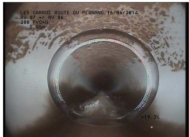
Photo: 21_3A, MPEG #: 160614_1, 00:01:23 5,82m, Emboîtement insuffisant de 12 à 12 h.
