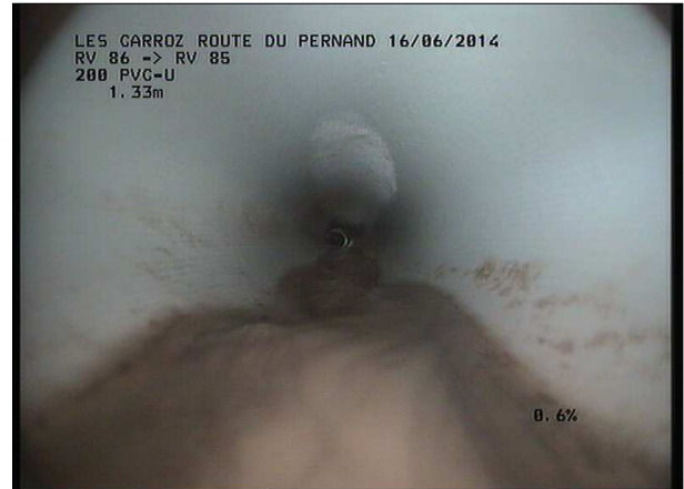
Photo: 22_2A, MPEG #: 160614_1, 00:00:11 1,5m, Poinçonnement à 07 h.
