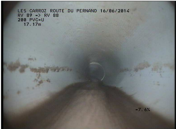
Photo: 19_5A, MPEG #: 160614_1, 00:02:08 17,42m, Ecrasement vertical avec déformation du fil d'eau
