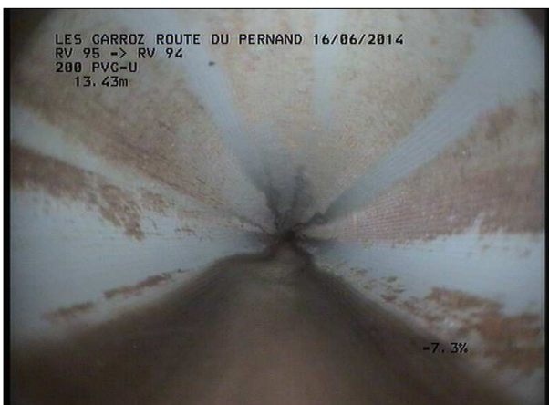
Photo: 13_3A, MPEG #: 160614_1, 00:01:17 13,86m, Ecrasement vertical avec déformation du fil d'eau
