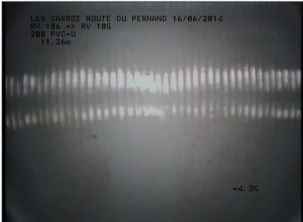
Photo: 2_4B, MPEG #: 160614_1, 00:01:14 11,26m, Poinçonnement à 12 h.
