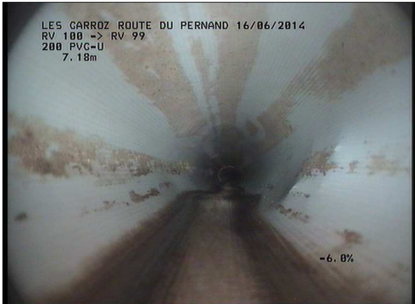
Photo: 8_4A, MPEG #: 160614_1, 00:02:08 7,55m, Poinçonnement de 03 à 07 h.
