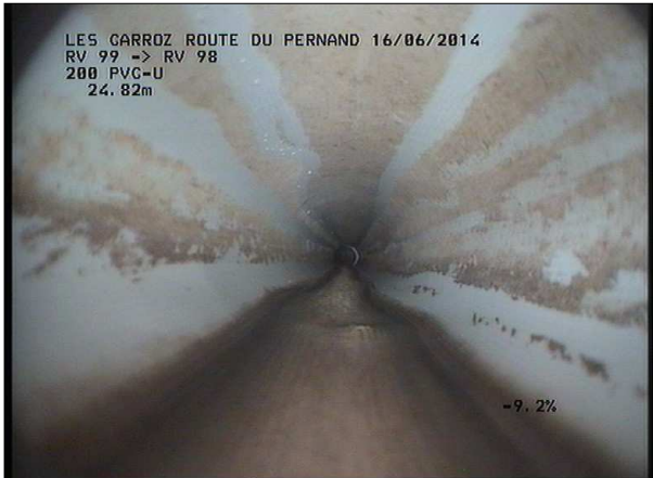
Photo: 9_5A, MPEG #: 160614_1, 00:02:19 25,06m, Poinçonnement à 06 h.
