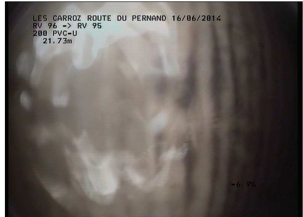
Photo: 12_4B, MPEG #: 160614_1, 00:02:09 21,73m, Poinçonnement à 05 h.
