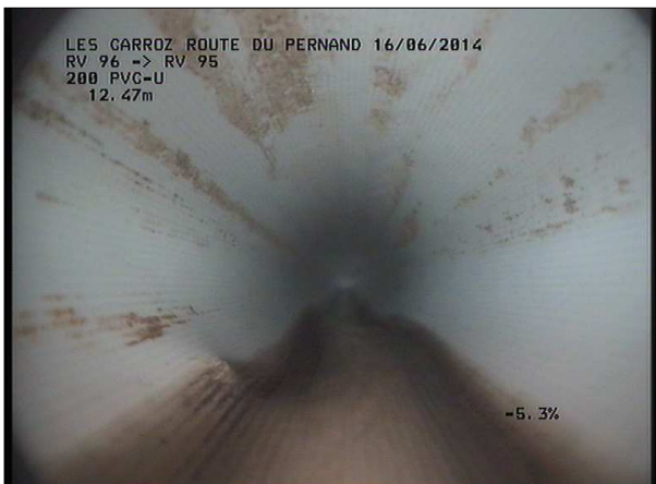
Photo: 12_3A, MPEG #: 160614_1, 00:01:19 12,76m, Poinçonnement à 07 h.
