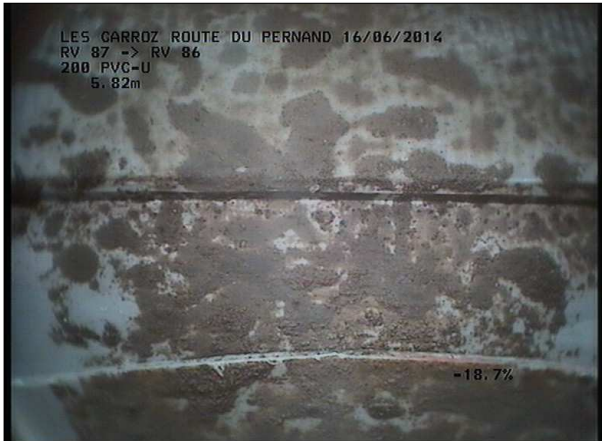
Photo: 21_3B, MPEG #: 160614_1, 00:01:23 5,82m, Emboîtement insuffisant de 12 à 12 h.
