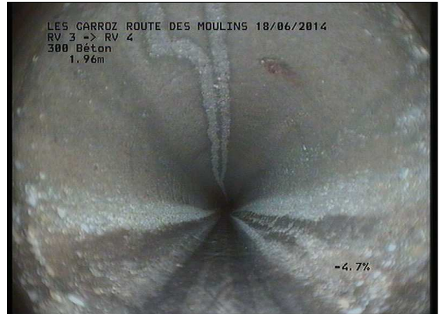
Photo: 3_4A, MPEG #: 180614_1, 00:01:08 2,31m, Dégradation du revêtement à 01 h.
