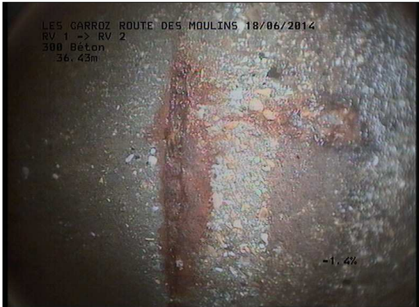
Photo: 1_16B, MPEG #: 180614_1, 00:06:38 36,43m, Armatures visibles de 03 à 05 h.
