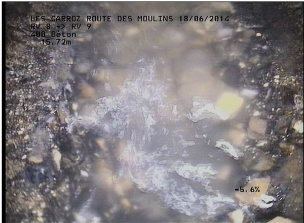
Photo: 8_5B, MPEG #: 180614_1, 00:02:39 15,72m, Dégradation du revêtement à 06 h.
