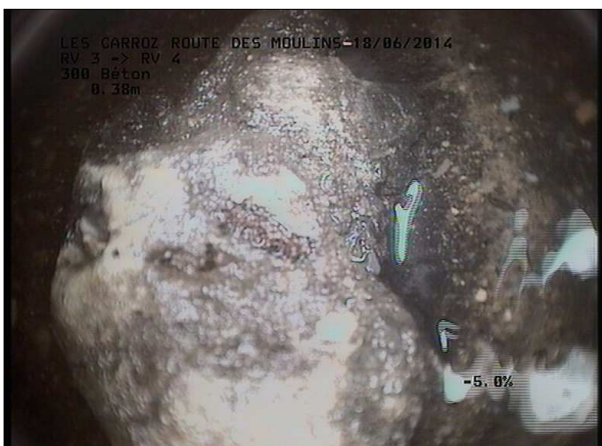
Photo: 3_2B, MPEG #: 180614_1, 00:00:05 0,46m, Dépôt de concrétions à 07 h.
