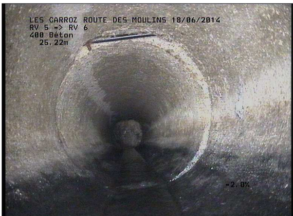
Photo: 5_7A, MPEG #: 180614_1, 00:03:20 26,03m, Joint défectueux (élastomère) de 11 à 01 h.
