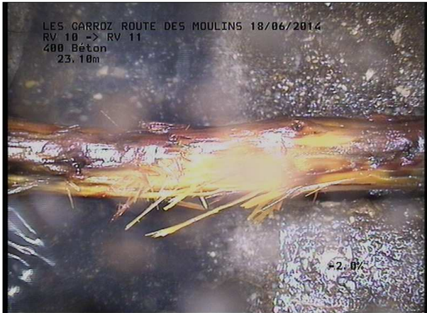
Photo: 10_5B, MPEG #: 180614_1, 00:03:19 23,1m, Pénétration d'élément extérieur de 03 à 08 h morceau de bois coincé dans un emboitement
