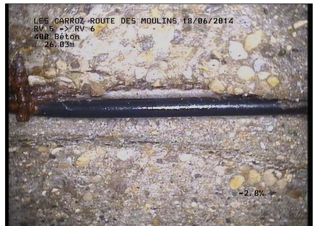
Photo: 5_7B, MPEG #: 180614_1, 00:03:20 26,03m, Joint défectueux (élastomère) de 11 à 01 h.
