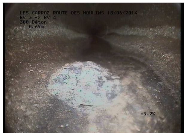
Photo: 3_3A, MPEG #: 180614_1, 00:00:38 0,83m, Dépôt de concrétions à 07 h.
