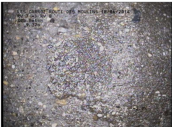
Photo: 7_6B, MPEG #: 180614_1, 00:02:51 9,37m, Poinçonnement à 12 h.
