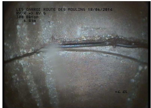
Photo: 4_4B, MPEG #: 180614_1, 00:01:23 6,81m, Joint défectueux (élastomère) de 10 à 12 h.
