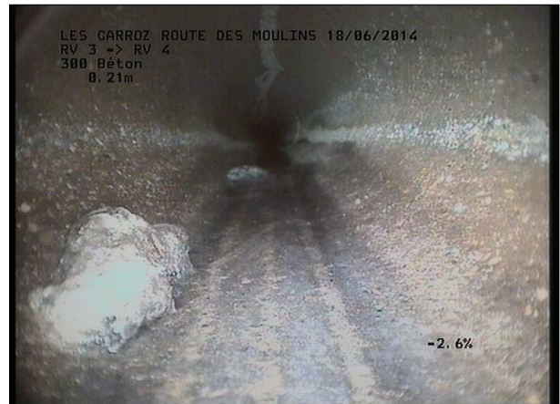
Photo: 3_2A, MPEG #: 180614_1, 00:00:05 0,46m, Dépôt de concrétions à 07 h.
