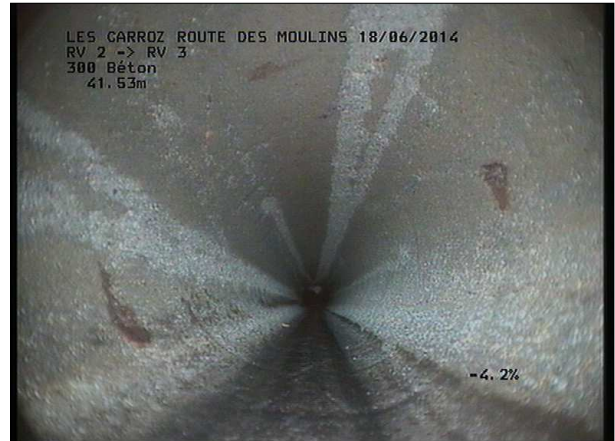
Photo: 2_10A, MPEG #: 180614_1, 00:05:04 41,79m, Dégradation du revêtement de 12 à 12 h.
