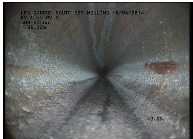
Photo: 1_16A, MPEG #: 180614_1, 00:06:38 36,43m, Armatures visibles de 03 à 05 h.
