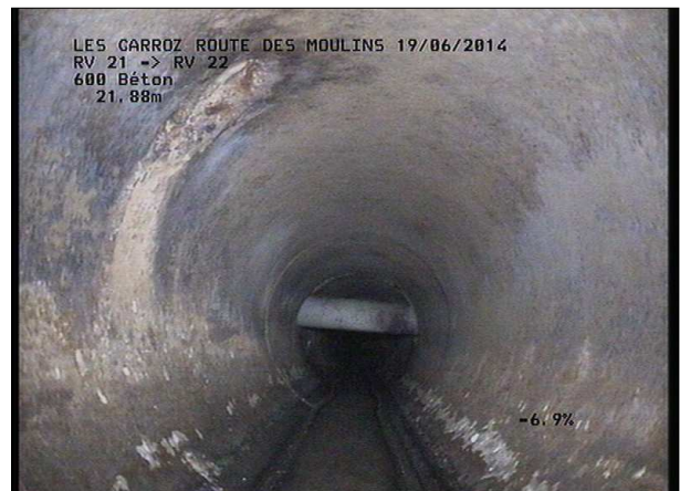
Photo: 21_3A, MPEG #: 180614_1, 00:01:30 22,88m, Raccordement direct à 10 h.
