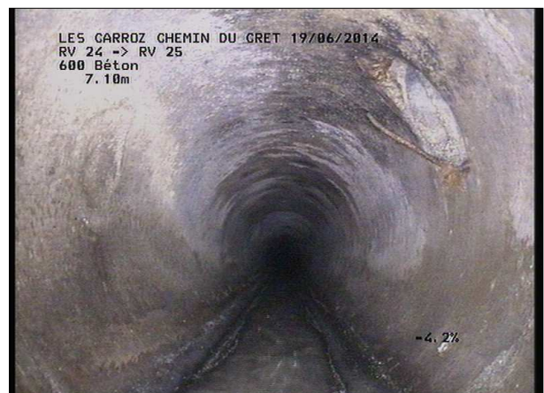
Photo: 24_3A, MPEG #: 180614_1, 00:01:02 8,18m, Raccordement direct à 01 h.
