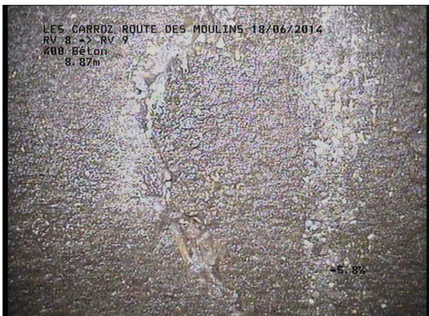
Photo: 8_2B, MPEG #: 180614_1, 00:00:49 8,87m, Poinçonnement à 11 h.
