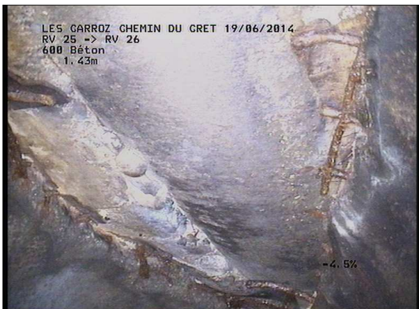
Photo: 25_4B, MPEG #: 180614_1, 00:00:51 5,44m, Eclatement de voute à 12 h par traversée de tuyau
