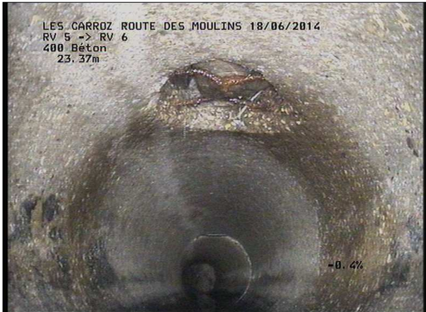
Photo: 5_6A, MPEG #: 180614_1, 00:02:46 23,99m, Infiltration à 12 h par perforation
