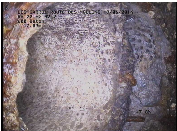
Photo: 22_4B, MPEG #: 180614_1, 00:01:29 17,03m, Raccordement pénétrant à 11 h.
