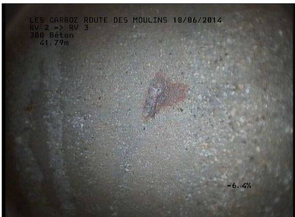
Photo: 2_10B, MPEG #: 180614_1, 00:05:04 41,79m, Dégradation du revêtement de 12 à 12 h.
