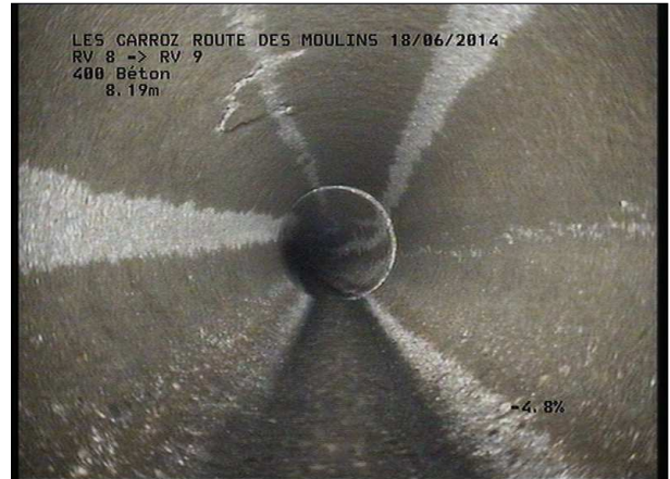
Photo: 8_2A, MPEG #: 180614_1, 00:00:49 8,87m, Poinçonnement à 11 h.
