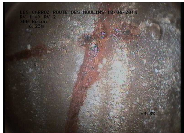
Photo: 1_5B, MPEG #: 180614_1, 00:01:27 6,23m, Armatures visibles de 12 à 12 h.
