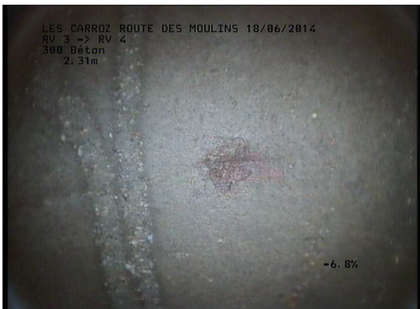
Photo: 3_4B, MPEG #: 180614_1, 00:01:08 2,31m, Dégradation du revêtement à 01 h.
