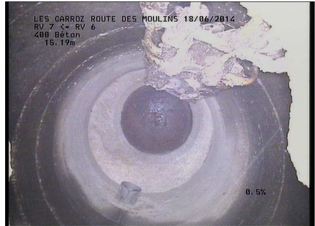
Photo: 6_6B, MPEG #: 180614_1, 00:03:09 15,19m, Fin de l'inspection R 283 sous enrobés
