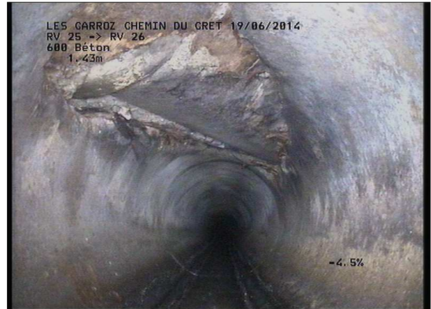
Photo: 25_4A, MPEG #: 180614_1, 00:00:51 5,44m, Eclatement de voute à 12 h par traversée de tuyau
