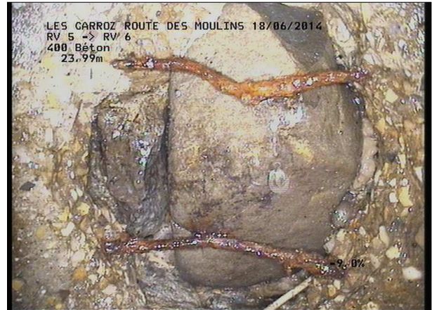
Photo: 5_6B, MPEG #: 180614_1, 00:02:46 23,99m, Infiltration à 12 h par perforation
