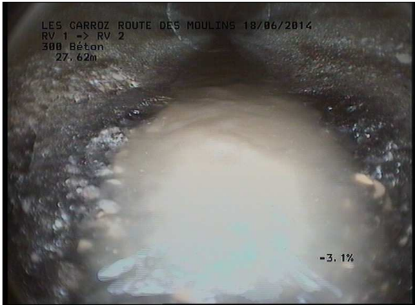
Photo: 1_12B, MPEG #: 180614_1, 00:04:50 27,62m, Dégradation du revêtement à 06 h.
