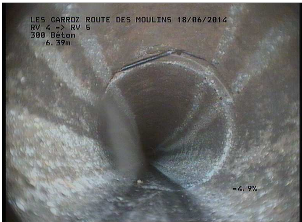
Photo: 4_4A, MPEG #: 180614_1, 00:01:23 6,81m, Joint défectueux (élastomère) de 10 à 12 h.
