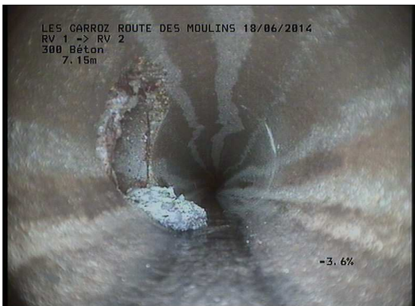
Photo: 1_7A, MPEG #: 180614_1, 00:01:54 7,6m, Dépôt de concrétions à 07 h.
