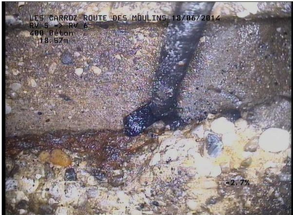
Photo: 5_3B, MPEG #: 180614_1, 00:01:49 18,57m, Joint défectueux (élastomère) à 08 h.
