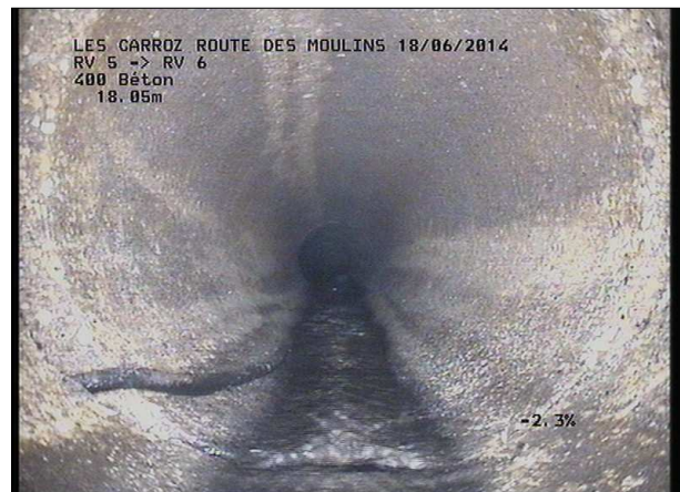
Photo: 5_3A, MPEG #: 180614_1, 00:01:49 18,57m, Joint défectueux (élastomère) à 08 h.
