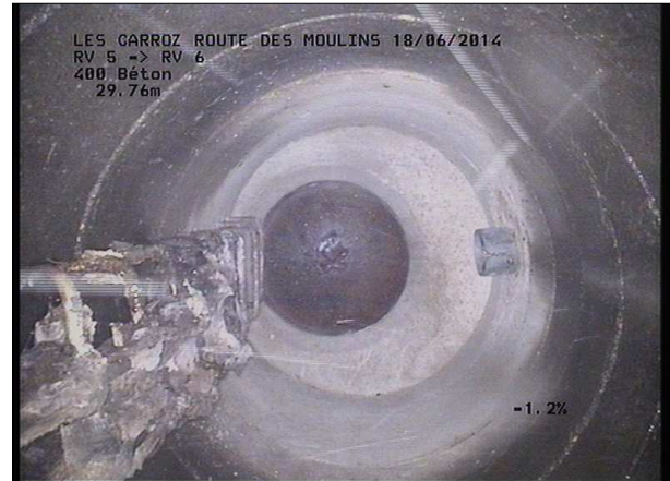
Photo: 5_8B, MPEG #: 180614_1, 00:03:47 28,9m, Fin de l'inspection R 283 sous enrobés
