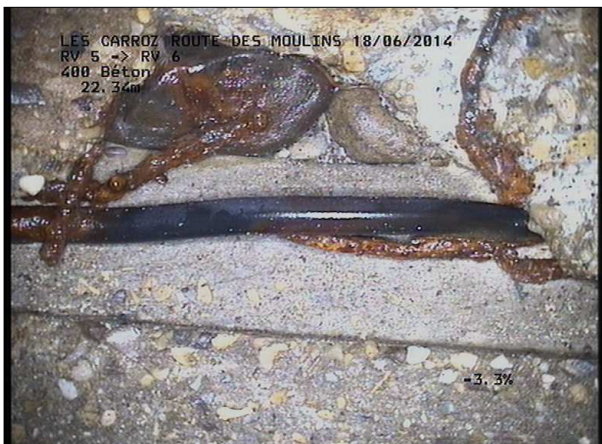
Photo: 5_4B, MPEG #: 180614_1, 00:02:17 22,34m, Joint défectueux (élastomère) à 12 h.
