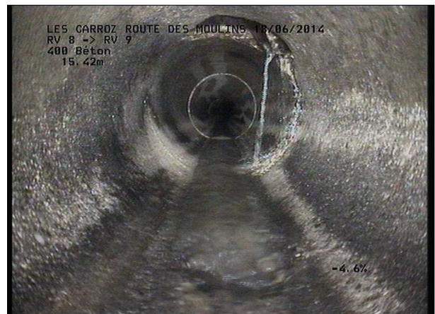
Photo: 8_5A, MPEG #: 180614_1, 00:02:39 15,72m, Dégradation du revêtement à 06 h.
