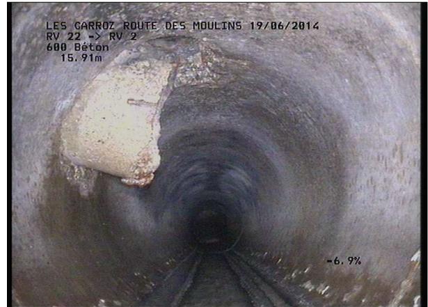
Photo: 22_4A, MPEG #: 180614_1, 00:01:29 17,03m, Raccordement pénétrant à 11 h.
