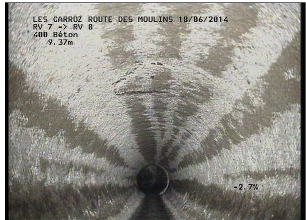
Photo: 7_6A, MPEG #: 180614_1, 00:02:51 9,37m, Poinçonnement à 12 h.
