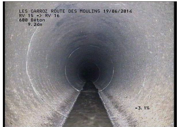
Photo: 15_2A, MPEG #: 180614_1, 00:00:45 10,24m, Fissure transversale fermée (circulaire)
