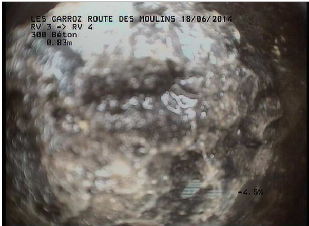
Photo: 3_3B, MPEG #: 180614_1, 00:00:38 0,83m, Dépôt de concrétions à 07 h.
