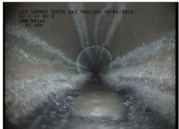
Photo: 1_12A, MPEG #: 180614_1, 00:04:50 27,62m, Dégradation du revêtement à 06 h.
