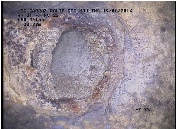
Photo: 21_3B, MPEG #: 180614_1, 00:01:30 22,88m, Raccordement direct à 10 h.
