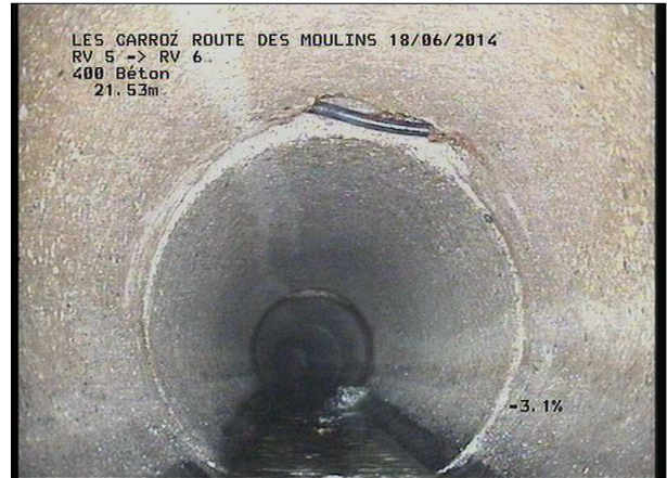
Photo: 5_4A, MPEG #: 180614_1, 00:02:17 22,34m, Joint défectueux (élastomère) à 12 h.
