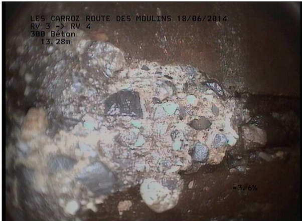
Photo: 3_7B, MPEG #: 180614_1, 00:02:37 13,28m, Dépôt de concrétions de 06 à 09 h.
