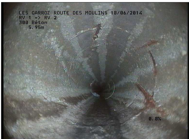
Photo: 1_5A, MPEG #: 180614_1, 00:01:27 6,23m, Armatures visibles de 12 à 12 h.
