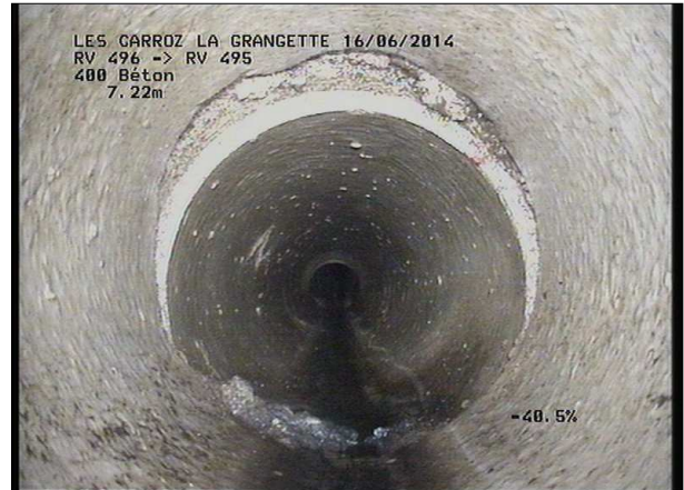
Photo: 5_4A, MPEG #: 160614_1, 00:01:25 7,67m, Emboîtement décentré verticalement
