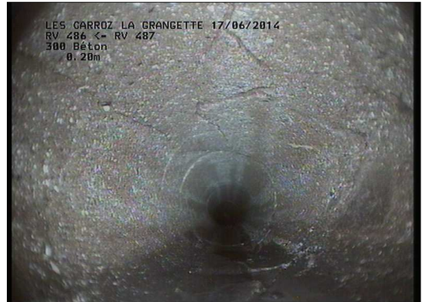
Photo: 15_2A, MPEG #: 160614_1, 00:00:09 0,2m, Fissures multiples de 12 à 12 h.
