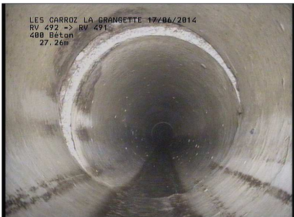
Photo: 9_13A, MPEG #: 160614_1, 00:05:20 27,74m, Emboîtement décentré verticalement
