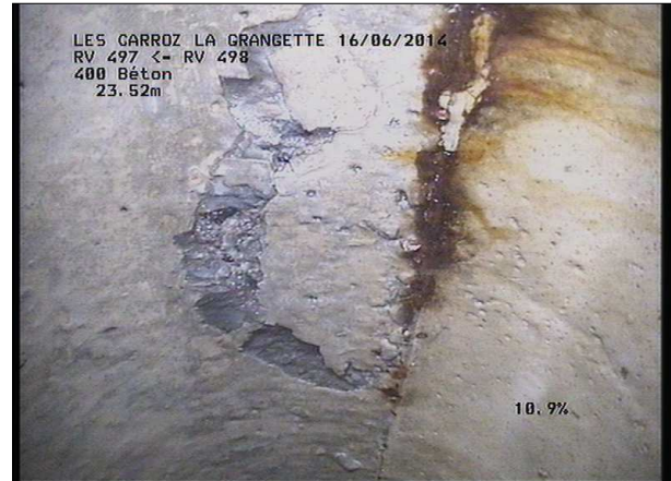
Photo: 1_11A, MPEG #: 160614_1, 00:05:29 23,52m, Dégradation du revêtement de 12 à 03 h due à oxidation des armatures
