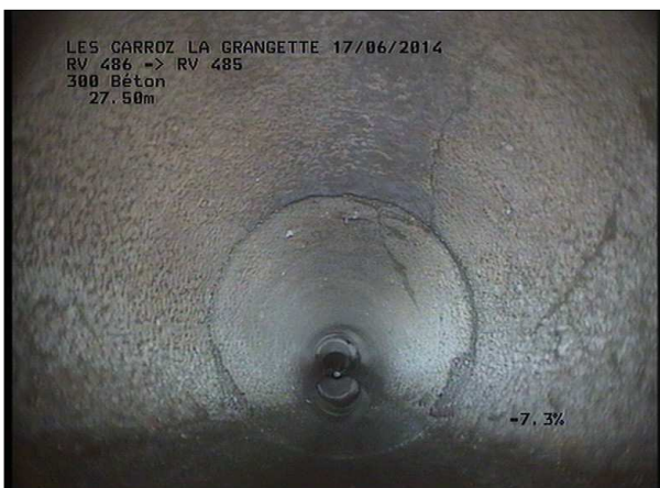
Photo: 16_7A, MPEG #: 160614_1, 00:03:16 27,64m, Fissures multiples de 12 à 12 h.
