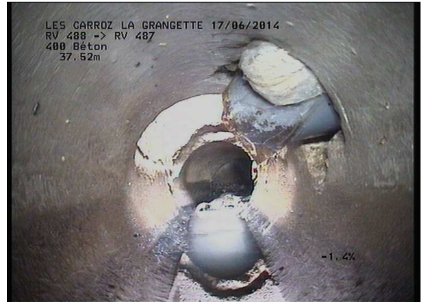
Photo: 13_11A, MPEG #: 160614_1, 00:06:34 38,35m, Raccordement pénétrant à 01 h.
