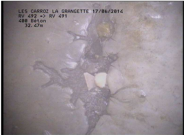
Photo: 9_14B, MPEG #: 160614_1, 00:05:58 32,47m, Dégradation du revêtement à 02 h.
