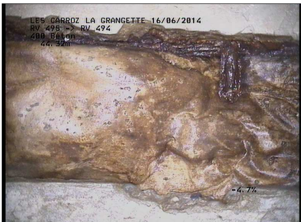
Photo: 6_12B, MPEG #: 160614_1, 00:07:51 44,32m, Epaufrure de 10 à 03 h.
