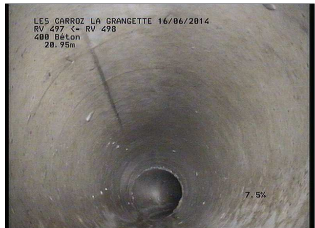
Photo: 1_10A, MPEG #: 160614_1, 00:05:00 21,39m, Armatures visibles à 11 h.
