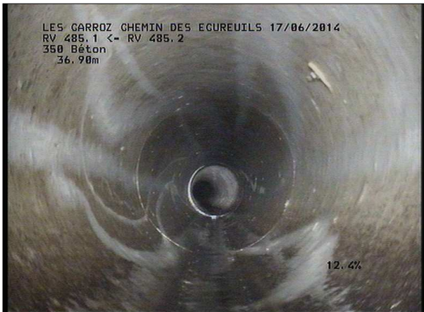
Photo: 18_12A, MPEG #: 160614_1, 00:10:02 37,07m, Interruption de l'inspection impossible de progresser, et pas d'accès à la canalisation en amont, REGARD ENTERRE
