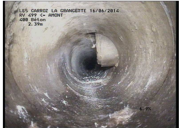
Photo: 3_2A, MPEG #: 160614_1, 00:02:51 2,39m, Raccordement pénétrant à 02 h.
