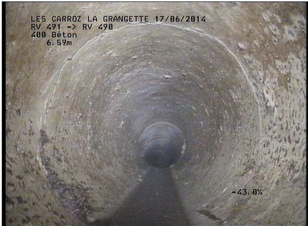
Photo: 10_8A, MPEG #: 160614_1, 00:02:55 6,59m, Fissure transversale (circulaire) avec présence de radicelles
