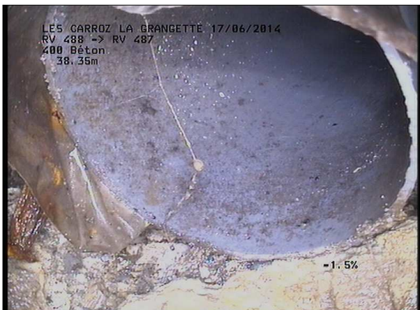
Photo: 13_11B, MPEG #: 160614_1, 00:06:34 38,35m, Raccordement pénétrant à 01 h.
