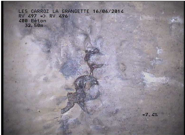
Photo: 4_13B, MPEG #: 160614_1, 00:08:02 32,5m, Dégradation du revêtement à 11 h.
