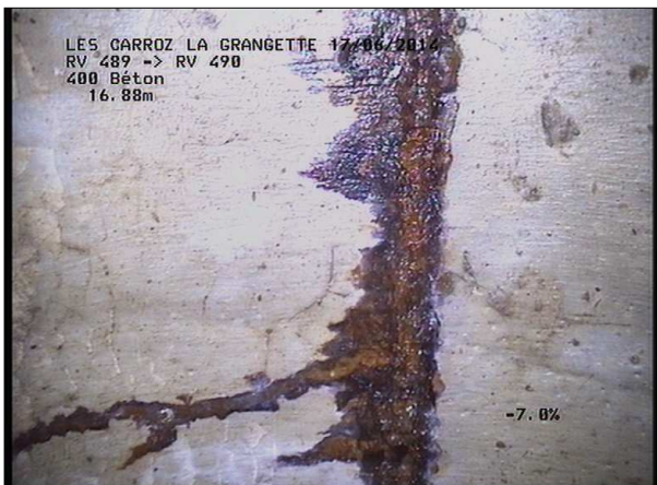
Photo: 11_6B, MPEG #: 160614_1, 00:02:56 16,88m, Armatures visibles à 12 h.
