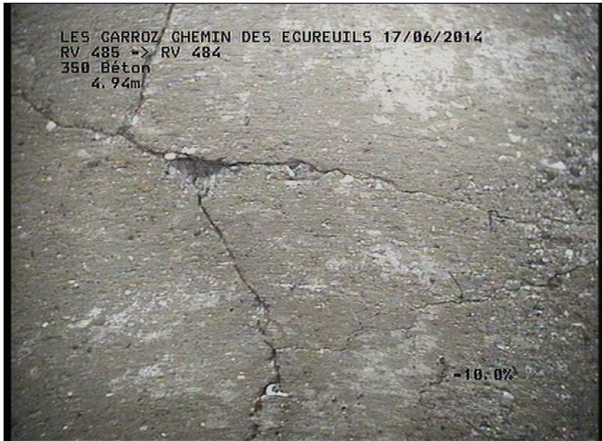
Photo: 20_3B, MPEG #: 160614_1, 00:00:44 4,94m, Fissures multiples fermées de 09 à 03 h.
