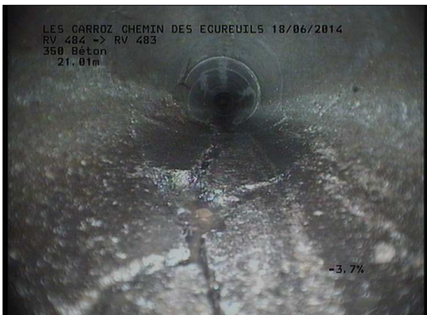
Photo: 23_4B, MPEG #: 160614_1, 00:02:25 21,01m, Fissures multiples de 12 à 12 h.
