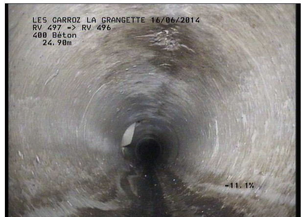
Photo: 4_9A, MPEG #: 160614_1, 00:05:23 25,49m, Dégradation du revêtement à 12 h.
