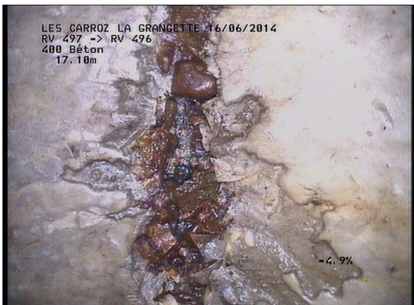
Photo: 4_6B, MPEG #: 160614_1, 00:03:15 17,1m, Dégradation du revêtement à 02 h.
