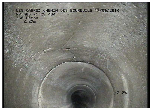
Photo: 20_3A, MPEG #: 160614_1, 00:00:44 4,94m, Fissures multiples fermées de 09 à 03 h.
