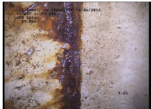
Photo: 1_12B, MPEG #: 160614_1, 00:06:37 29,05m, Armatures visibles à 08 h.
