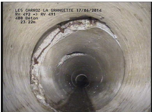
Photo: 9_11A, MPEG #: 160614_1, 00:04:25 23,81m, Eclatement de 07 à 02 h.
