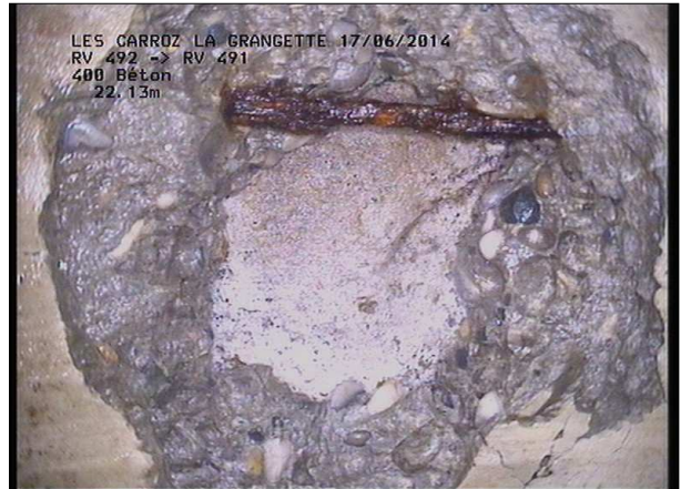
Photo: 9_10B, MPEG #: 160614_1, 00:04:04 22,13m, Eclatement à 11 h.
