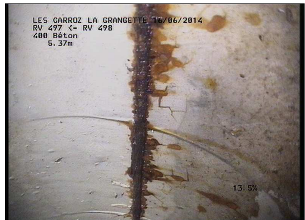
Photo: 1_3B, MPEG #: 160614_1, 00:00:59 5,37m, Armatures visibles à 03 h.
