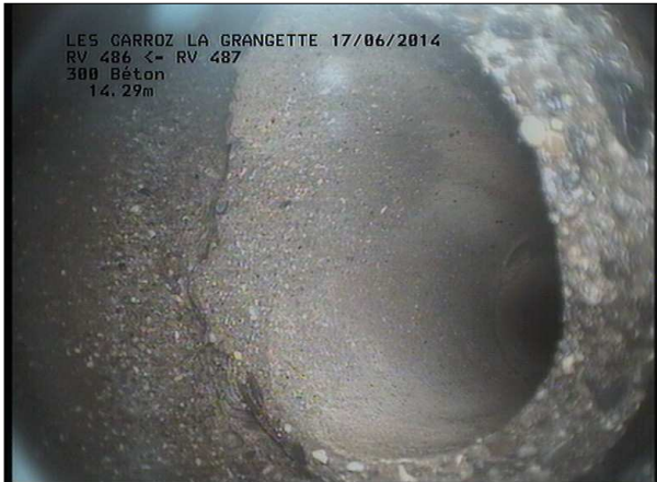
Photo: 15_7B, MPEG #: 160614_1, 00:00:36 14,29m, Raccordement pénétrant à 02 h.
