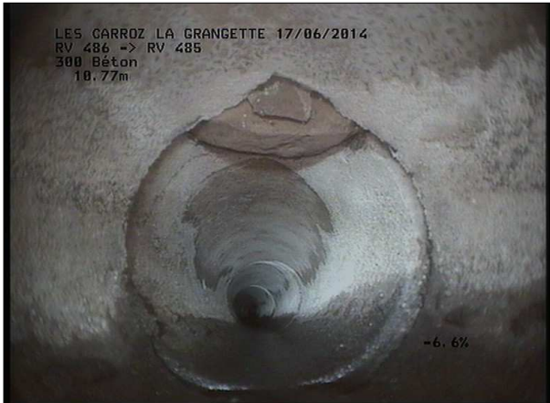
Photo: 16_4A, MPEG #: 160614_1, 00:01:19 11,1m, Eclatement à 12 h rebouché avec cailloux
