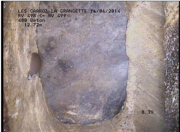
Photo: 2_9B, MPEG #: 160614_1, 00:03:58 12,72m, Raccordement direct à 12 h dans REGARD BORGNE
