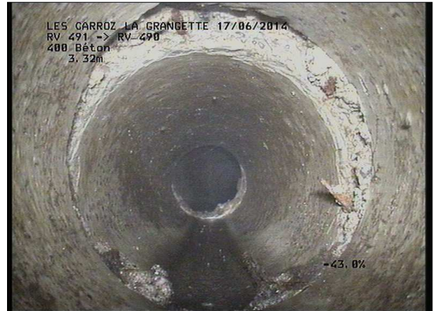
Photo: 10_4A, MPEG #: 160614_1, 00:01:32 3,32m, Emboîtement décentré verticalement
