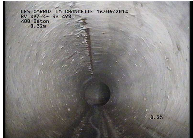
Photo: 1_5A, MPEG #: 160614_1, 00:01:47 9,1m, Armatures visibles à 12 h.
