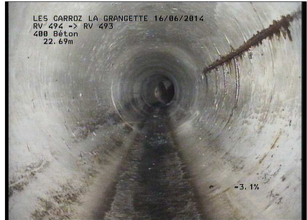
Photo: 7_6A, MPEG #: 160614_1, 00:04:21 23,3m, Armatures visibles à 01 h.
