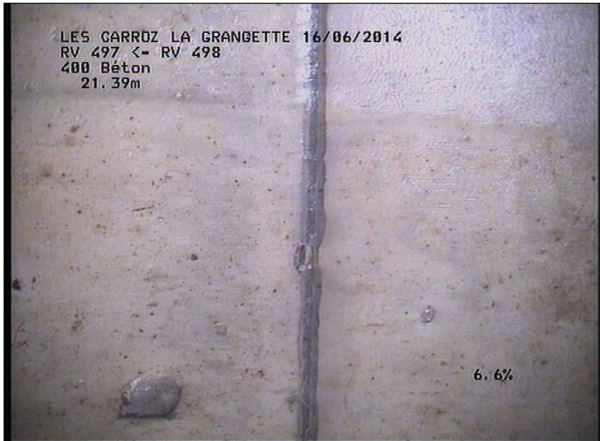
Photo: 1_10B, MPEG #: 160614_1, 00:05:00 21,39m, Armatures visibles à 11 h.
