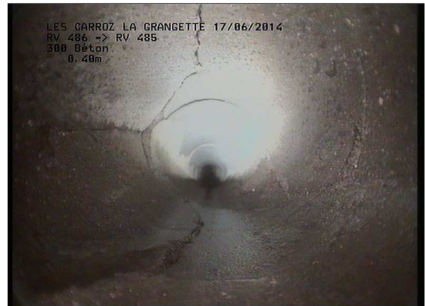
Photo: 16_2A, MPEG #: 160614_1, 00:00:05 0,88m, Fissures multiples de 12 à 12 h.
