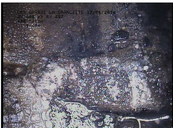
Photo: 13_2B, MPEG #: 160614_1, 00:00:10 1,49m, Dépôt de concrétions à 06 h.
