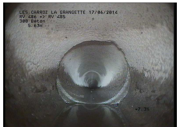
Photo: 16_3A, MPEG #: 160614_1, 00:00:46 6,05m, Emboîtement décentré verticalement
