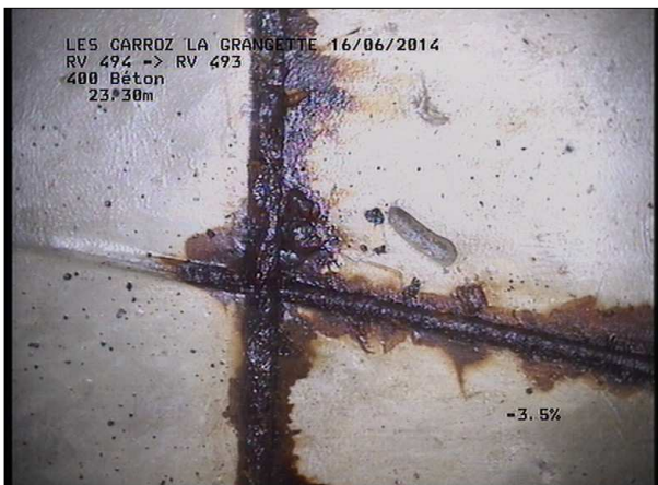
Photo: 7_6B, MPEG #: 160614_1, 00:04:21 23,3m, Armatures visibles à 01 h.
