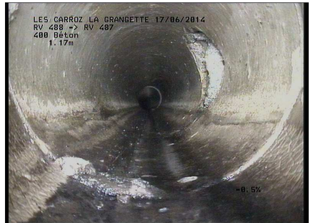
Photo: 13_2A, MPEG #: 160614_1, 00:00:10 1,49m, Dépôt de concrétions à 06 h.
