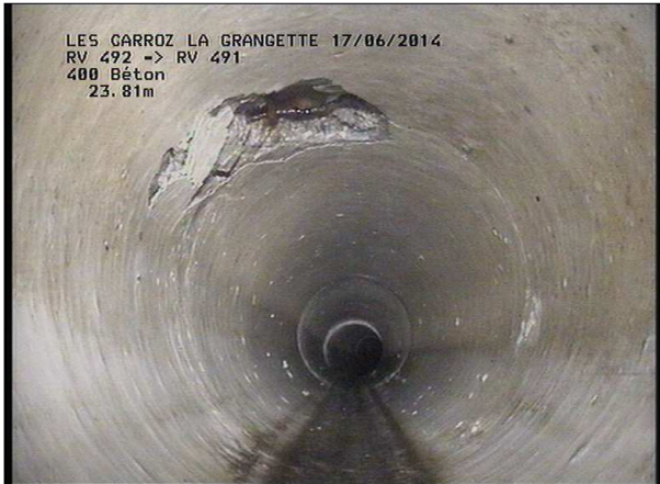
Photo: 9_12A, MPEG #: 160614_1, 00:04:45 24,42m, Eclatement de 11 à 12 h.
