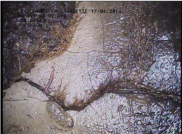
Photo: 10_3B, MPEG #: 160614_1, 00:00:46 2,35m, Fissure transversale (circulaire) avec entrée de racines
