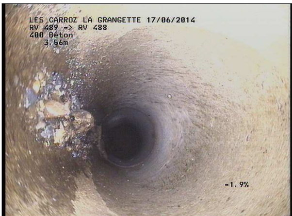
Photo: 12_4B, MPEG #: 160614_1, 00:01:01 3,56m, Raccordement direct à 10 h.
