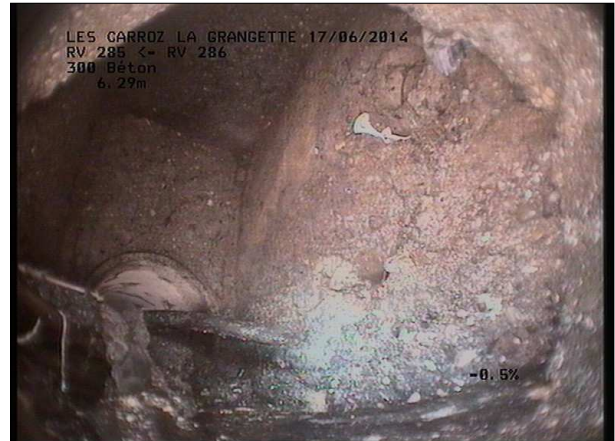
Photo: 17_2A, MPEG #: 160614_1, 00:00:36 6,29m, Pénétration d'élément extérieur de 12 à 12 h.
