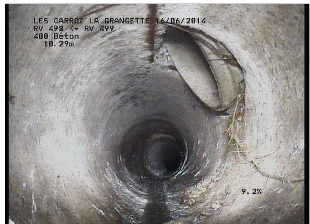
Photo: 2_7A, MPEG #: 160614_1, 00:02:42 10,88m, Raccordement direct à 02 h.
