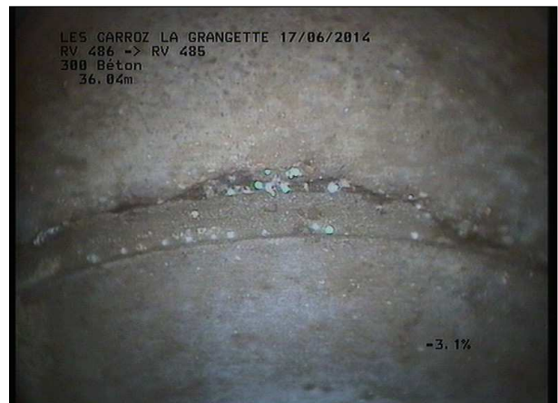
Photo: 16_12B, MPEG #: 160614_1, 00:05:45 36,04m, Epaufrure de 11 à 01 h.
