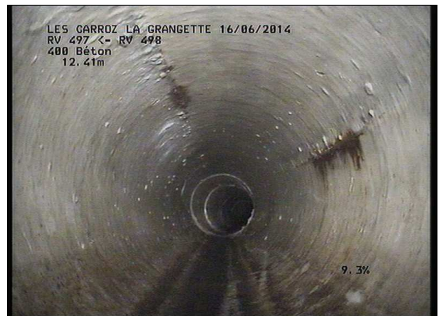
Photo: 1_6A, MPEG #: 160614_1, 00:02:26 13,09m, Armatures visibles à 11 et 03 h.
