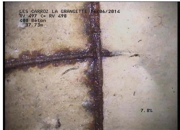
Photo: 1_15B, MPEG #: 160614_1, 00:08:38 37,73m, Armatures visibles à 09 h.
