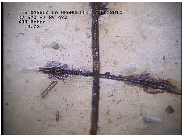
Photo: 8_2B, MPEG #: 160614_1, 00:00:21 3,72m, Armatures visibles à 12 h.
