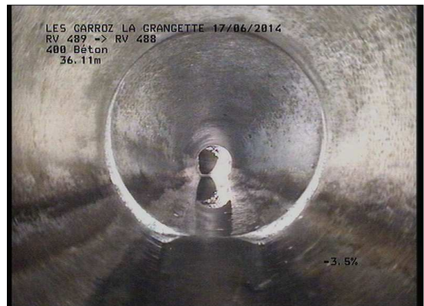
Photo: 12_11A, MPEG #: 160614_1, 00:08:37 36,68m, Emboîtement décentré verticalement
