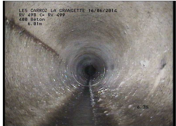
Photo: 2_4A, MPEG #: 160614_1, 00:01:32 6,55m, Armatures visibles à 10 h.
