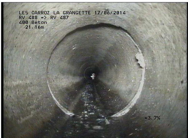
Photo: 13_7A, MPEG #: 160614_1, 00:03:45 21,72m, Emboîtement décentré verticalement
