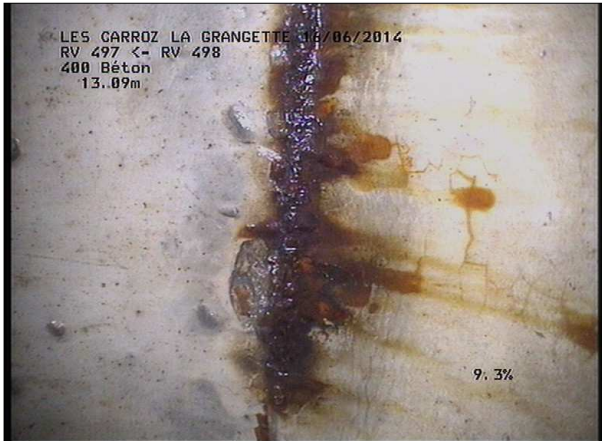
Photo: 1_6B, MPEG #: 160614_1, 00:02:26 13,09m, Armatures visibles à 11 et 03 h.
