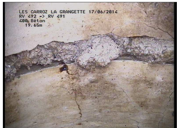
Photo: 9_7B, MPEG #: 160614_1, 00:03:06 19,65m, Dépôt de concrétions de 12 à 12 h.
