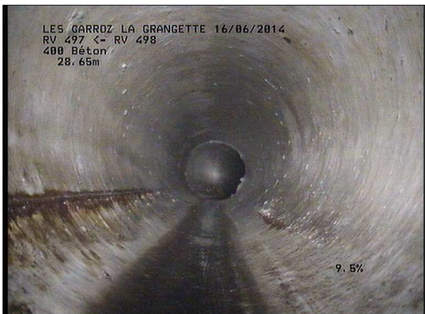
Photo: 1_12A, MPEG #: 160614_1, 00:06:37 29,05m, Armatures visibles à 08 h.
