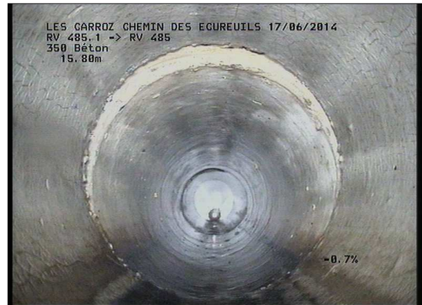
Photo: 19_6A, MPEG #: 160614_1, 00:03:33 16,14m, Emboîtement décentré verticalement
