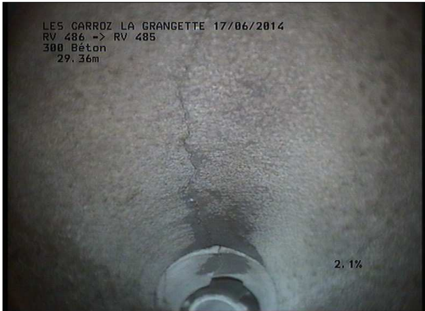
Photo: 16_8A, MPEG #: 160614_1, 00:03:47 29,54m, Fissure longitudinale à 12 h.
