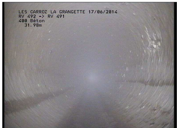
Photo: 9_14A, MPEG #: 160614_1, 00:05:58 32,47m, Dégradation du revêtement à 02 h.
