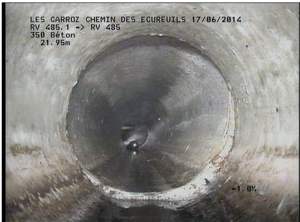
Photo: 19_8A, MPEG #: 160614_1, 00:04:32 22,41m, Emboîtement décentré verticalement
