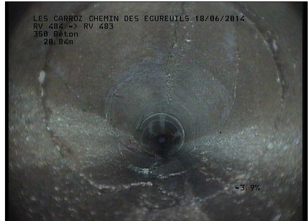
Photo: 23_4A, MPEG #: 160614_1, 00:02:25 21,01m, Fissures multiples de 12 à 12 h.
