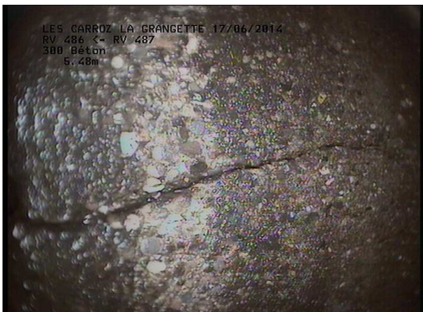
Photo: 15_4B, MPEG #: 160614_1, 00:00:36 5,48m, Fissures multiples de 12 à 12 h.
