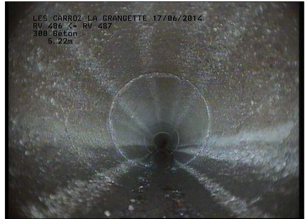
Photo: 15_4A, MPEG #: 160614_1, 00:00:36 5,48m, Fissures multiples de 12 à 12 h.
