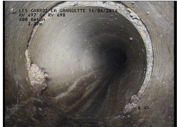
Photo: 1_2A, MPEG #: 160614_1, 00:00:22 2,37m, Dépôt de concrétions à 04 et 08 h.
