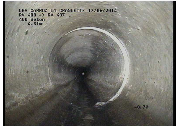
Photo: 13_4A, MPEG #: 160614_1, 00:01:04 5,34m, Emboîtement décentré horizontalement suite courbure sur j=emboîtement
