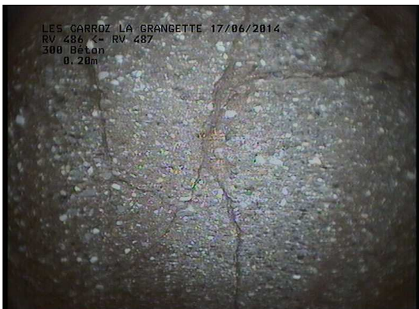
Photo: 15_2B, MPEG #: 160614_1, 00:00:09 0,2m, Fissures multiples de 12 à 12 h.
