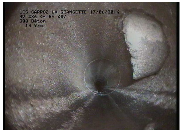
Photo: 15_7A, MPEG #: 160614_1, 00:00:36 14,29m, Raccordement pénétrant à 02 h.
