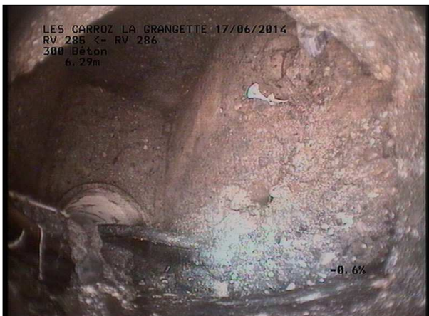
Photo: 17_3A, MPEG #: 160614_1, 00:00:42 6,47m, Interruption de l'inspection dans REGARD BORGNE
