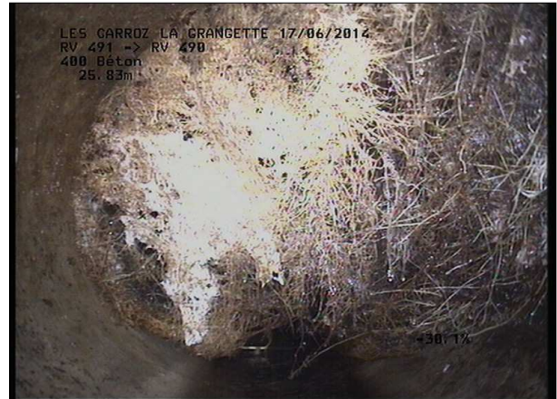
Photo: 10_17A, MPEG #: 160614_1, 00:07:28 25,83m, Racines et radicelles avec obstruction partielle de 12 à 12 h.
