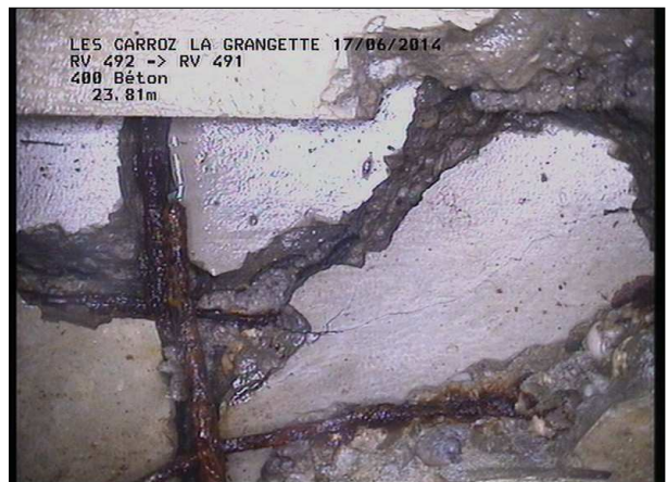
Photo: 9_11B, MPEG #: 160614_1, 00:04:25 23,81m, Eclatement de 07 à 02 h.
