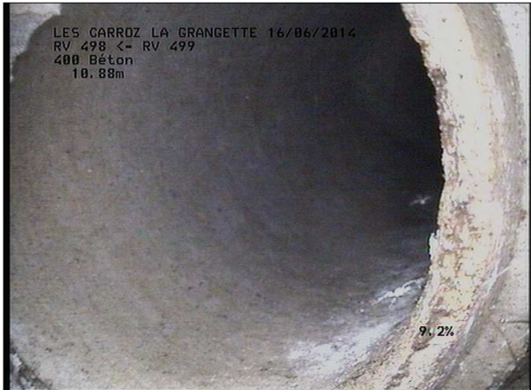
Photo: 2_7B, MPEG #: 160614_1, 00:02:42 10,88m, Raccordement direct à 02 h.
