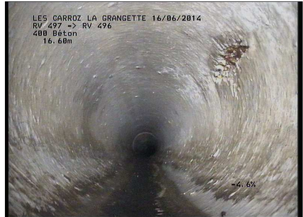
Photo: 4_6A, MPEG #: 160614_1, 00:03:15 17,1m, Dégradation du revêtement à 02 h.
