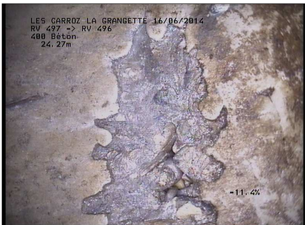
Photo: 4_8B, MPEG #: 160614_1, 00:04:55 24,27m, Dégradation du revêtement à 08 h.
