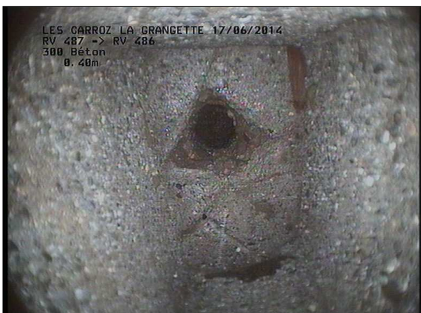
Photo: 14_2B, MPEG #: 160614_1, 00:00:10 0,4m, Interruption de l'inspection dans REGARD BORGNE SANS FOND BETON
