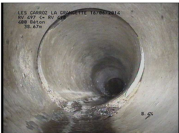
Photo: 1_16A, MPEG #: 160614_1, 00:09:03 39,2m, Emboîtement décentré verticalement
