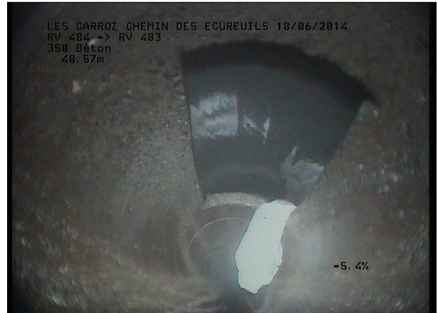
Photo: 23_10A, MPEG #: 160614_1, 00:07:01 48,57m, Effondrement partiel de 10 à 02 h réparé par extérieur avec morceaux de PVC
