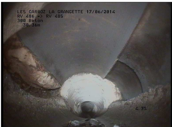
Photo: 16_9A, MPEG #: 160614_1, 00:04:16 30,36m, Effondrement partiel de 09 à 03 h rebouché avec morceau de PVC
