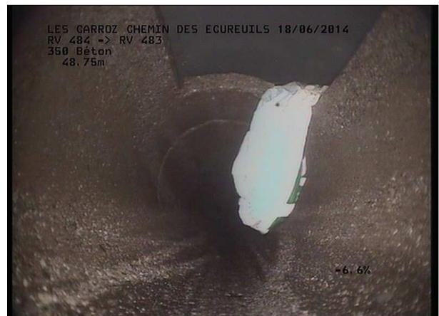
Photo: 23_11A, MPEG #: 160614_1, 00:07:42 49,19m, Pénétration d'élément extérieur à 01 h. Sac plastique
