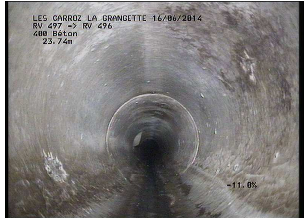
Photo: 4_8A, MPEG #: 160614_1, 00:04:55 24,27m, Dégradation du revêtement à 08 h.
