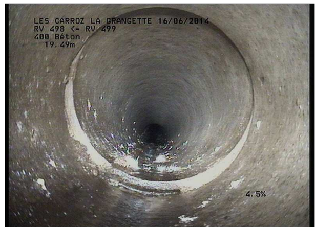
Photo: 2_11A, MPEG #: 160614_1, 00:05:40 19,97m, Emboîtement décentré verticalement
