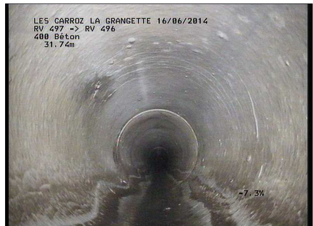
Photo: 4_13A, MPEG #: 160614_1, 00:08:02 32,5m, Dégradation du revêtement à 11 h.
