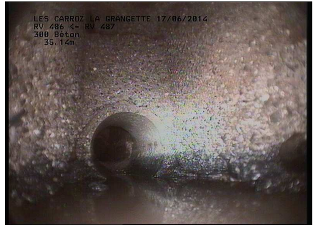
Photo: 15_10A, MPEG #: 160614_1, 00:00:36 35,39m, Interruption de l'inspection dans REGARD BORGNE
