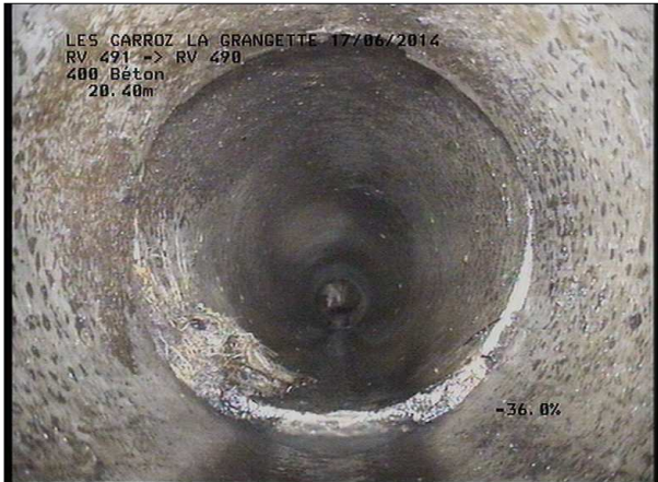
Photo: 10_14A, MPEG #: 160614_1, 00:06:17 20,4m, Emboîtement décentré verticalement
