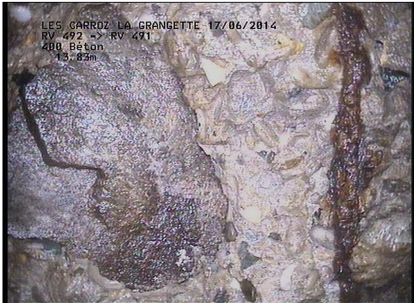
Photo: 9_5B, MPEG #: 160614_1, 00:01:59 13,83m, Eclatement de 08 à 10 h.
