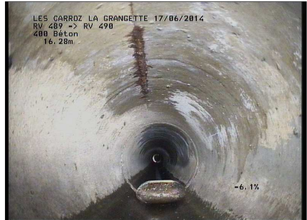
Photo: 11_6A, MPEG #: 160614_1, 00:02:56 16,88m, Armatures visibles à 12 h.
