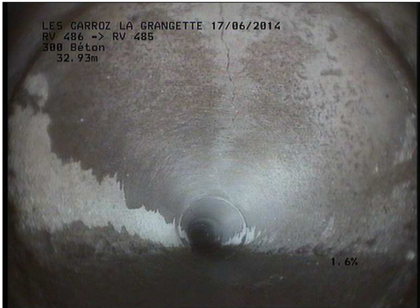
Photo: 16_11A, MPEG #: 160614_1, 00:05:18 33,13m, Fissure longitudinale fermée à 12 h.
