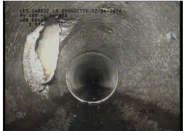
Photo: 12_4A, MPEG #: 160614_1, 00:01:01 3,56m, Raccordement direct à 10 h.
