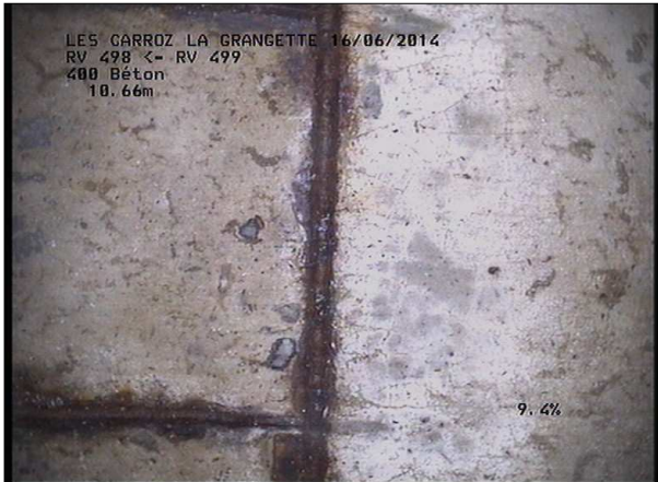
Photo: 2_5B, MPEG #: 160614_1, 00:02:25 9,9m, Armatures visibles à 12 h.
