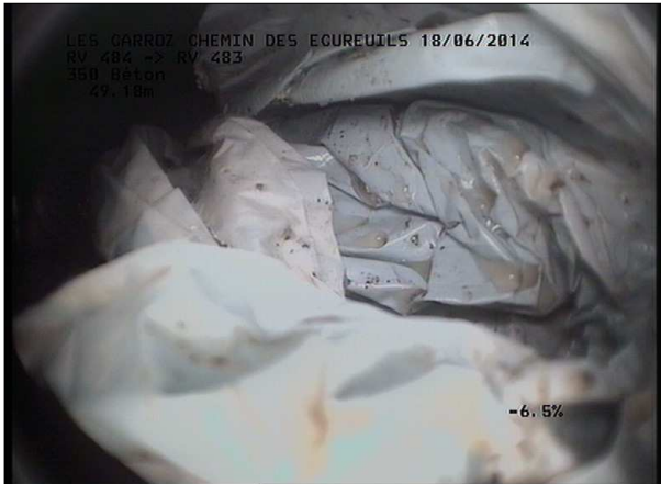
Photo: 23_11B, MPEG #: 160614_1, 00:07:42 49,19m, Pénétration d'élément extérieur à 01 h. Sac plastique
