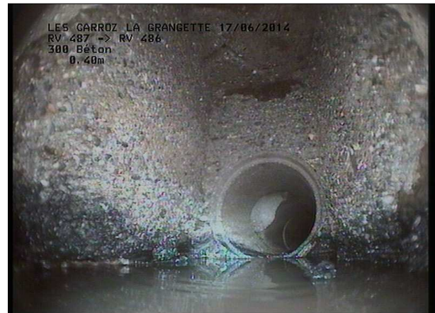
Photo: 14_2A, MPEG #: 160614_1, 00:00:10 0,4m, Interruption de l'inspection dans REGARD BORGNE SANS FOND BETON
