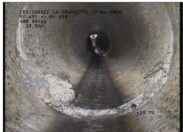
Photo: 10_19A, MPEG #: 160614_1, 00:08:34 33,16m, Dépôt de concrétions à 07 h.
