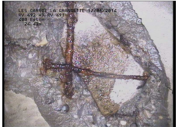
Photo: 9_12B, MPEG #: 160614_1, 00:04:45 24,42m, Eclatement de 11 à 12 h.
