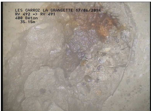
Photo: 9_15B, MPEG #: 160614_1, 00:06:38 35,15m, Eclatement de 10 à 11 h.
