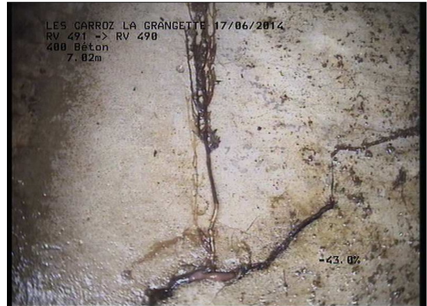
Photo: 10_8B, MPEG #: 160614_1, 00:02:55 6,59m, Fissure transversale (circulaire) avec présence de radicelles
