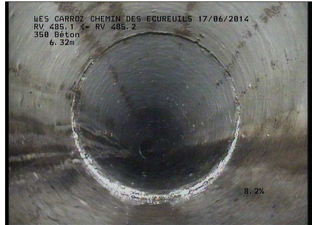
Photo: 18_4A, MPEG #: 160614_1, 00:08:45 6,87m, Emboîtement décentré verticalement
