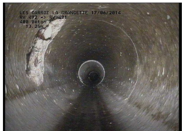
Photo: 9_5A, MPEG #: 160614_1, 00:01:59 13,83m, Eclatement de 08 à 10 h.
