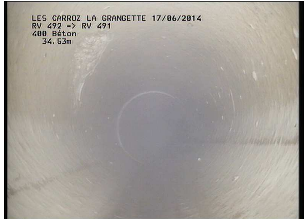
Photo: 9_15A, MPEG #: 160614_1, 00:06:38 35,15m, Eclatement de 10 à 11 h.
