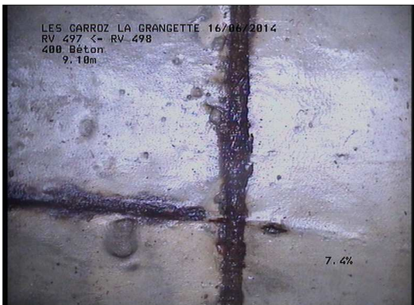
Photo: 1_5B, MPEG #: 160614_1, 00:01:47 9,1m, Armatures visibles à 12 h.
