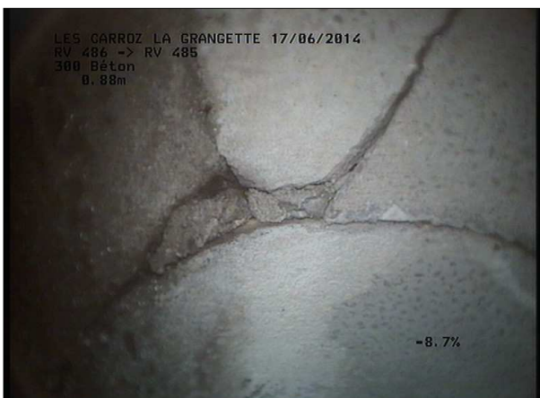
Photo: 16_2B, MPEG #: 160614_1, 00:00:05 0,88m, Fissures multiples de 12 à 12 h.
