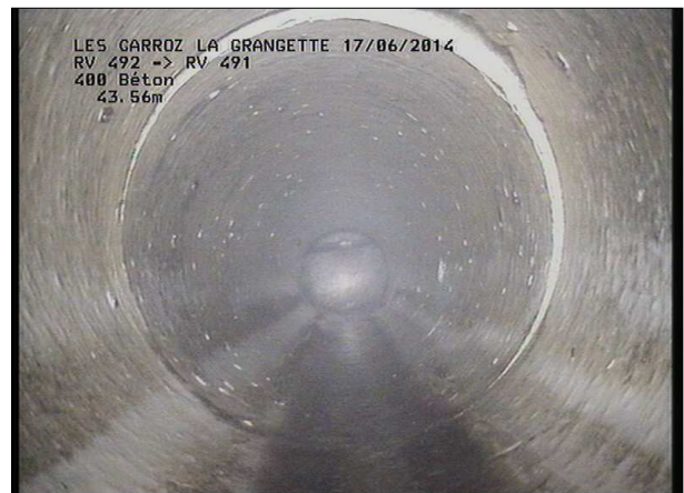
Photo: 9_20A, MPEG #: 160614_1, 00:09:51 43,92m, Emboîtement décentré verticalement
