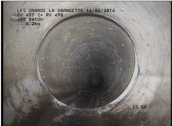
Photo: 1_4A, MPEG #: 160614_1, 00:01:24 6,75m, Emboîtement décentré verticalement
