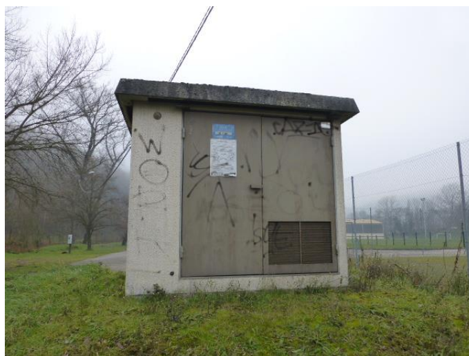
Fig. 33. Transformateur surélevé dans le secteur des terrains de tennis
