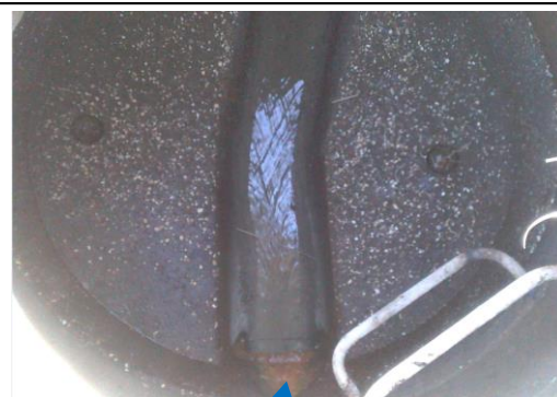
Entrée d'eaux claires
