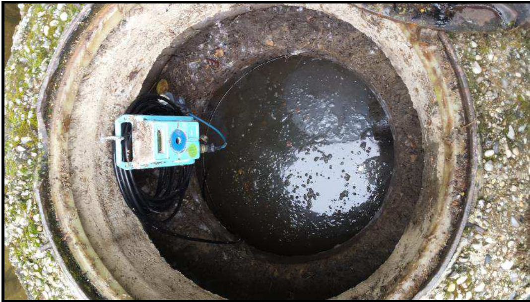
Au niveau du point PE3, la hauteur d'eau a atteint 70 cm.
