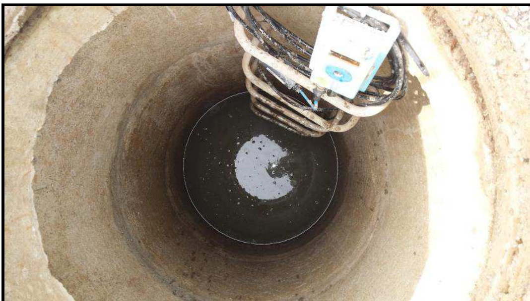
Au niveau du point PE4, la hauteur d'eau a atteint 1.5 m.
